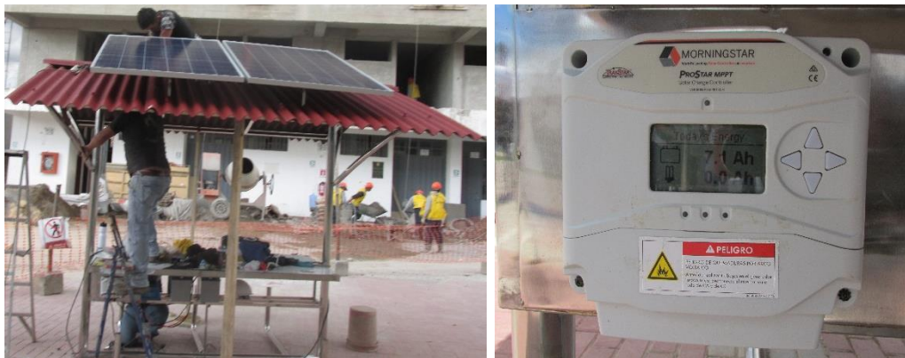
Figura 7. Conexión de los paneles fotovoltaicos al regulador de carga del sistema Fotovoltaico.
