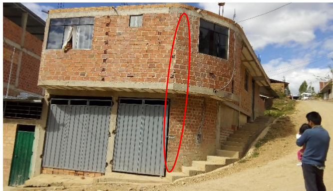
Figura 43. Vivienda sin columna esquinera, vivienda no cuenta con planos
