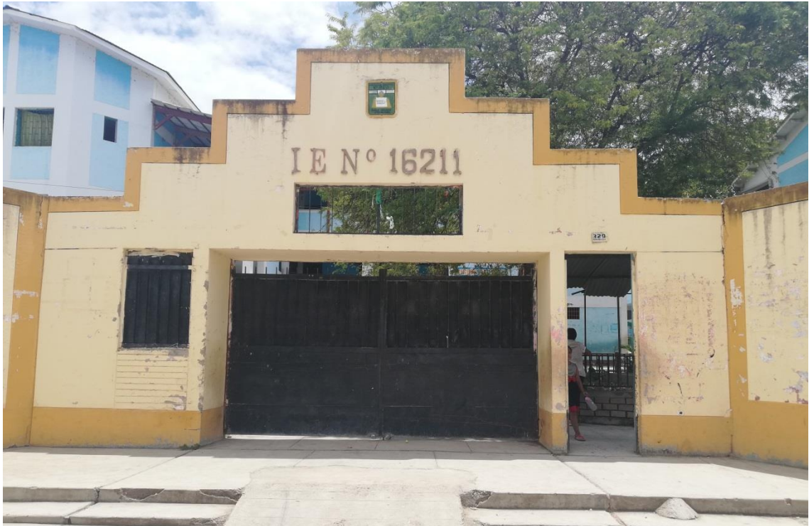
Foto N° 01: Ingreso con presencia de desintegración en el cerco perimétrico de la I.E. N°16211, Bagua Grande, Utcubamba, Amazonas.
