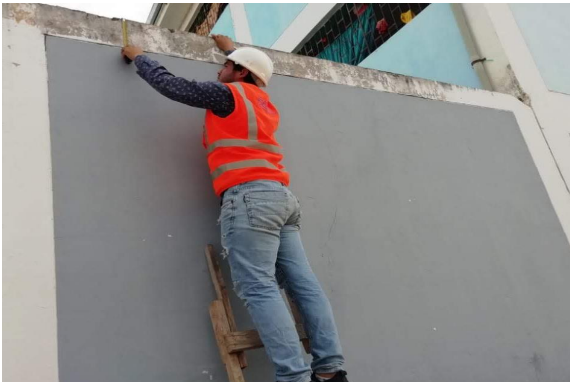
Foto N° 04: Medicion de área de moho en viga en el cerco perimétrico de la I.E. N°16211, Bagua Grande, Utcubamba, Amazonas
