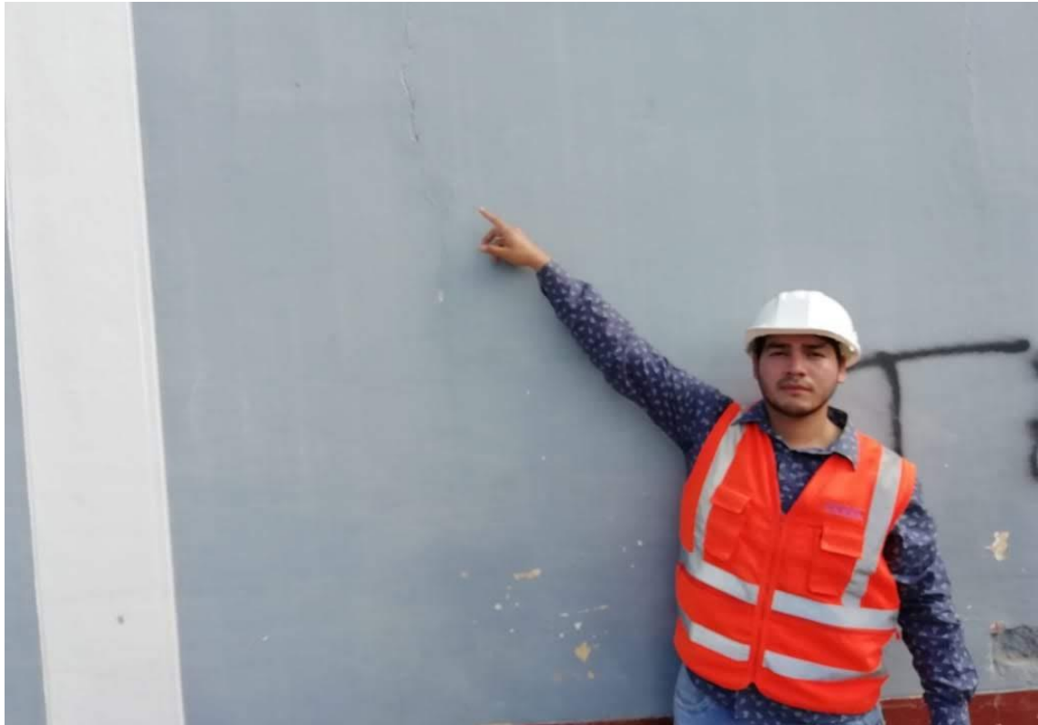
Foto N° 10: Visualización de grietas y fisuras en el paño N° 10 de la I.E. N°16211, Bagua Grande, Utcubamba, Amazonas.
