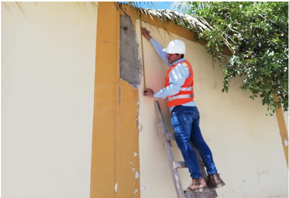
Foto N° 08: Medición de área de desprendimiento en columna en el cerco perimétrico de la I.E. N°16211, Bagua Grande, Utcubamba, Amazonas.
