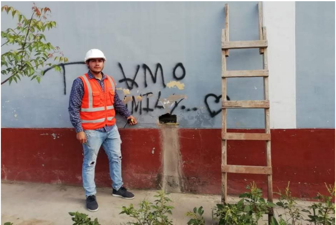
Foto N° 02: Presencia de humedad y desprendimiento de ladrillo en el cerco perimétrico de la I.E. N°16211, Bagua Grande, Utcubamba, Amazonas.
