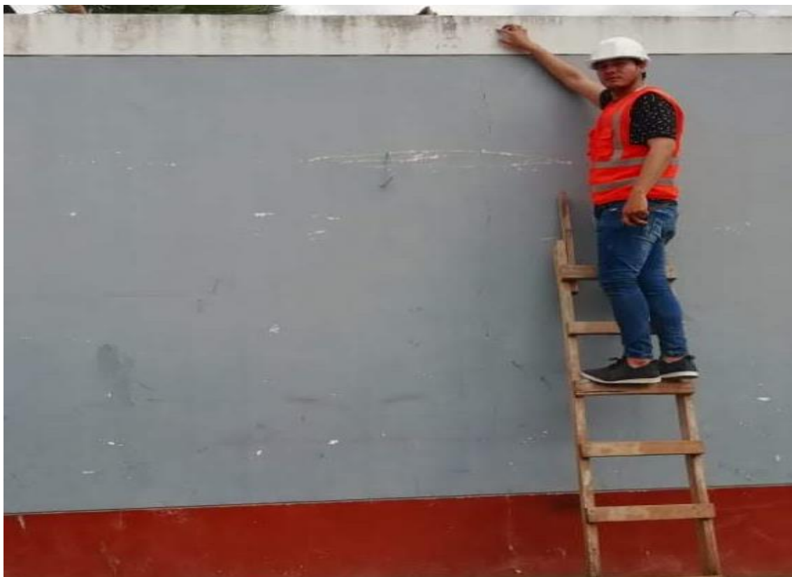
Foto N° 11: Visualización de patologías en el paño N° 02 de la I.E. N°16211, Bagua Grande, Utcubamba, Amazonas.
