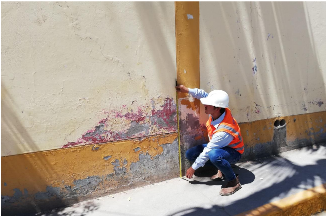
Foto N° 06: Medición de las áreas de las patologías presentes en albañilería, columna, sobrecimiento del cerco perimetrico de la I.E. N°16211.
