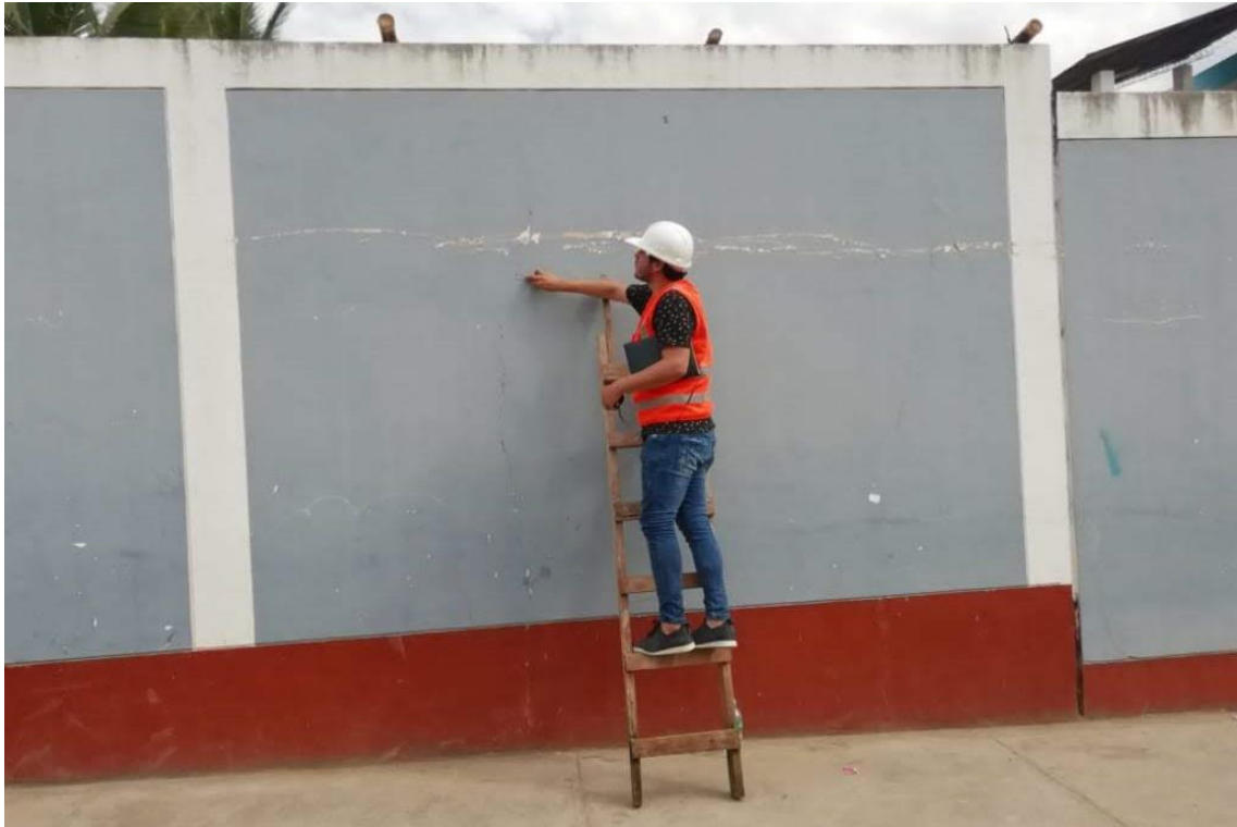
Foto N° 03: Identificación de grietas y fisuras en el cerco perimétrico de la I.E. N°16211, Bagua Grande, Utcubamba, Amazonas
