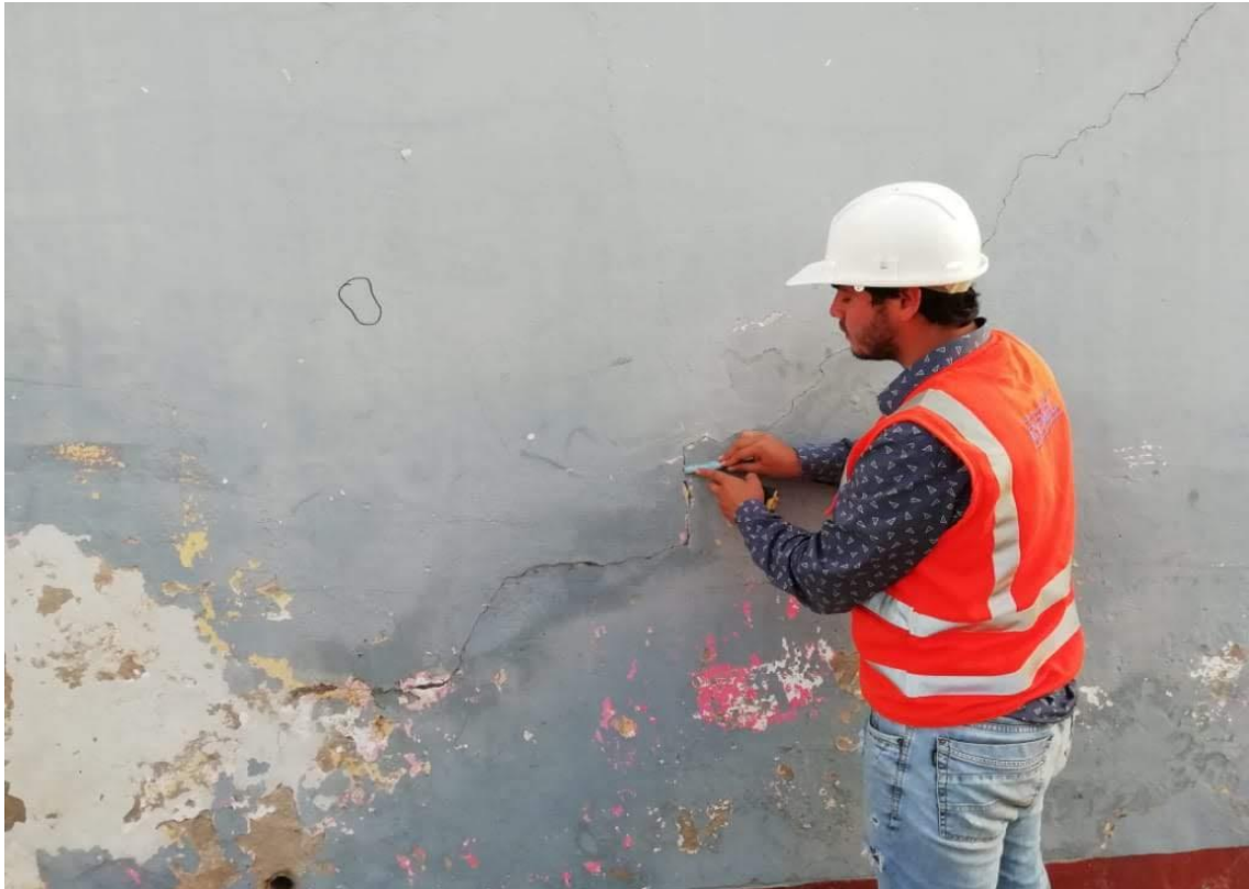
Foto N° 07: Medición de ancho de abertura de grieta para la clasificación del nivel de severidad en el cerco perimétrico de la I.E. N°16211, Bagua Grande, Utcubamba, Amazonas.
