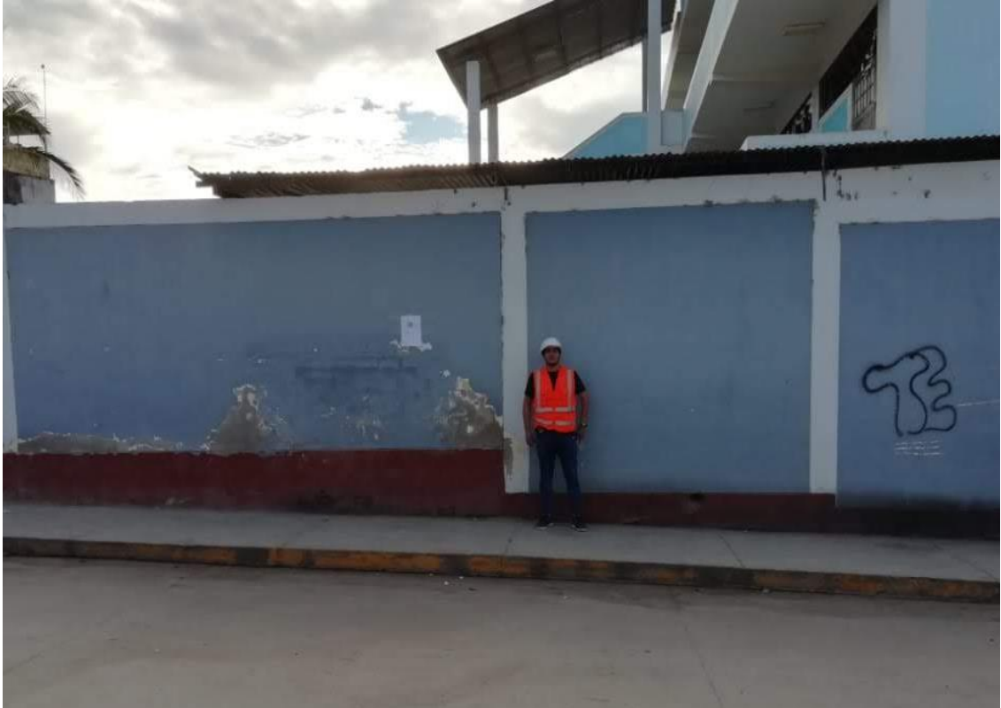
Foto N° 05: Identificación de área afectada por humedad en el cerco perimétrico de la I.E. N°16211, Bagua Grande, Utcubamba, Amazonas
