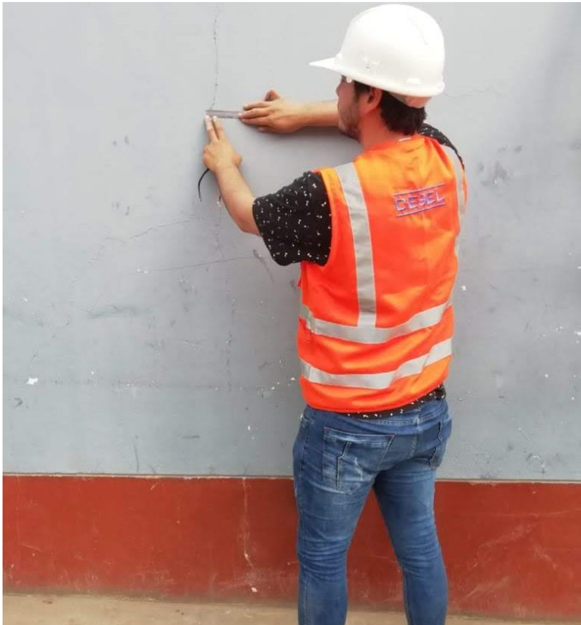
Foto N° 09: Visualización de grietas y fisuras en el paño N° 03 de la I.E. N°16211, Bagua Grande, Utcubamba, Amazonas.
