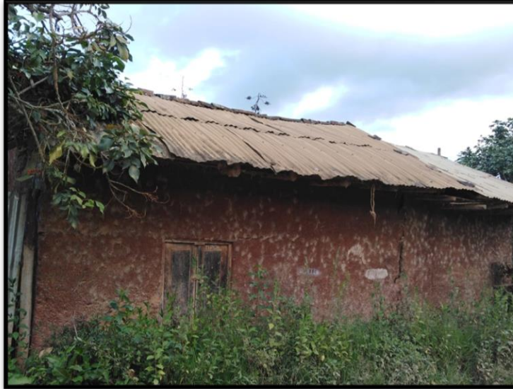
Figura 43. Vivienda de chacra sin habitar, sin servicios básicos de agua desagüe y en mal estado.
