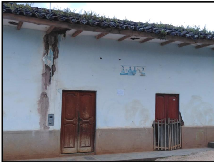
Figura 42. Vivienda de material de adobe, techo de teja típica, en mal estado de conservación y sin servicios básicos de saneamiento
