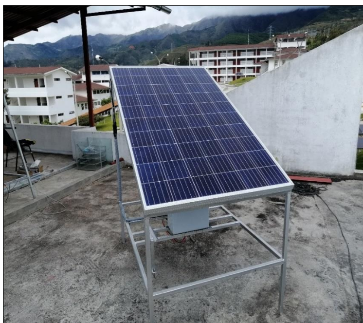
Figura 7. Sistema fotovoltaico armado
