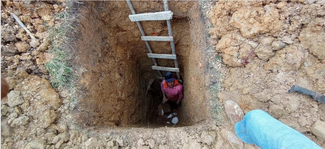
Fotografía N° 8. Presencia de agua en la calicata (C-2), el nivel freático se encontró a 50 cm de profundidad.
