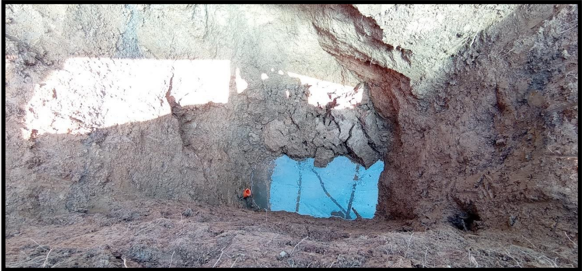
Fotografía N° 6. Después de 24 horas de la excavación de la calicata (C-1), se apreció que el nivel de agua subió 50 cm y hubo desprendimiento de suelo.
