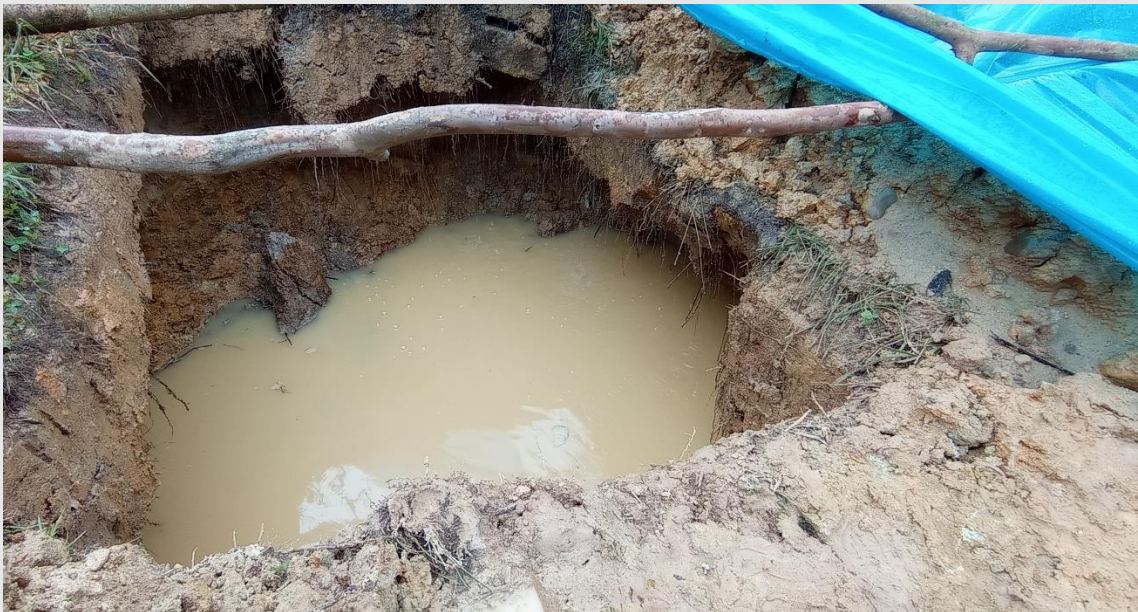
Fotografía N° 9. Después de 24 horas de la excavación de la calicata (C-2), el nivel del agua subió 2.00 m y hubo desprendimiento de suelo.
