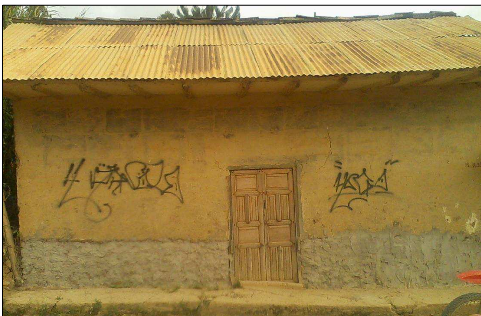
Figura N° 63: Vivienda de la familia Rodríguez Vera, en malas condiciones (elaboración propia)
