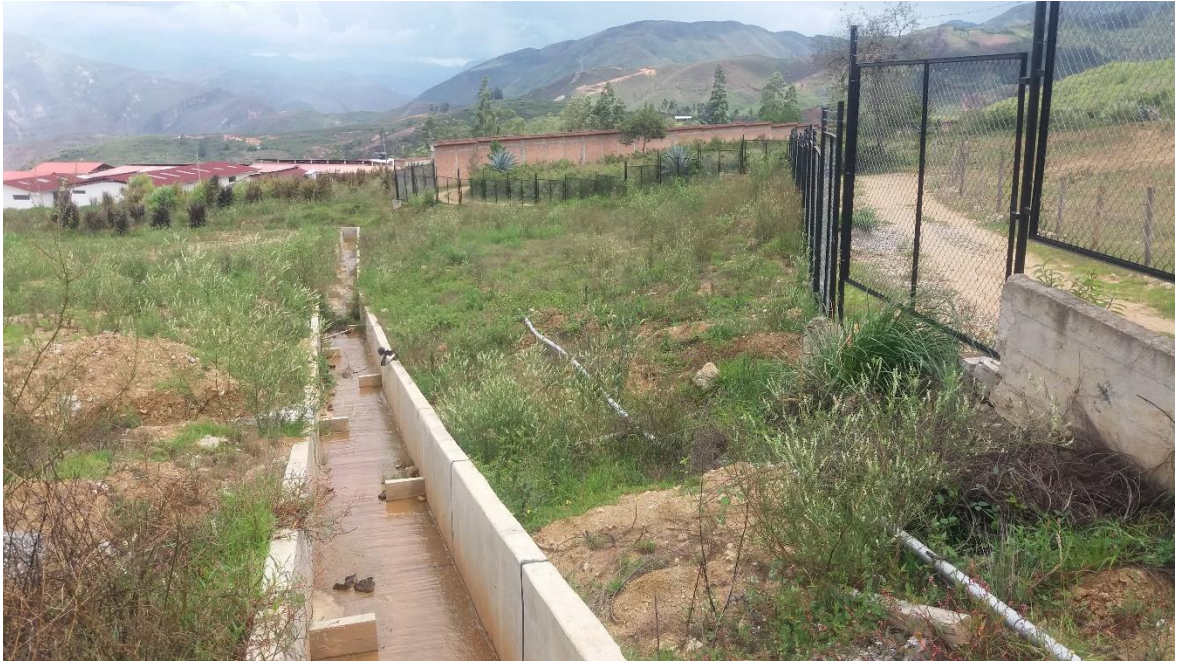
Fotografía 11: Estructuras de drenaje pluvial sin mantenimiento.
