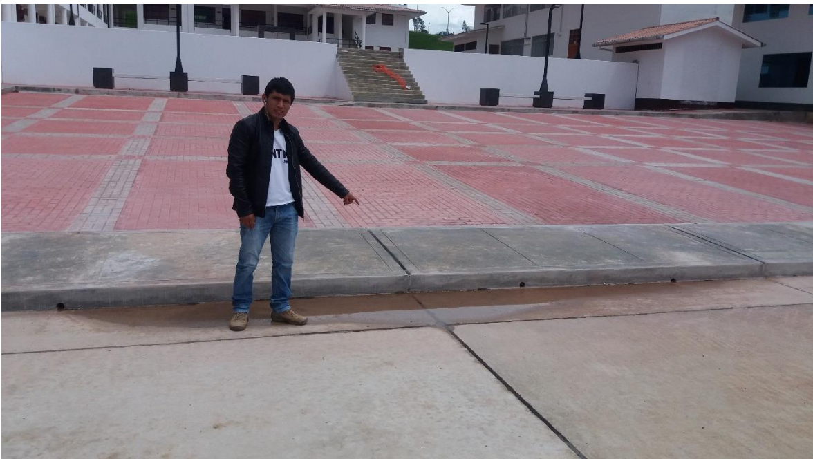
Fotografía 4: Pistas sin estructuras de drenaje pluvial
