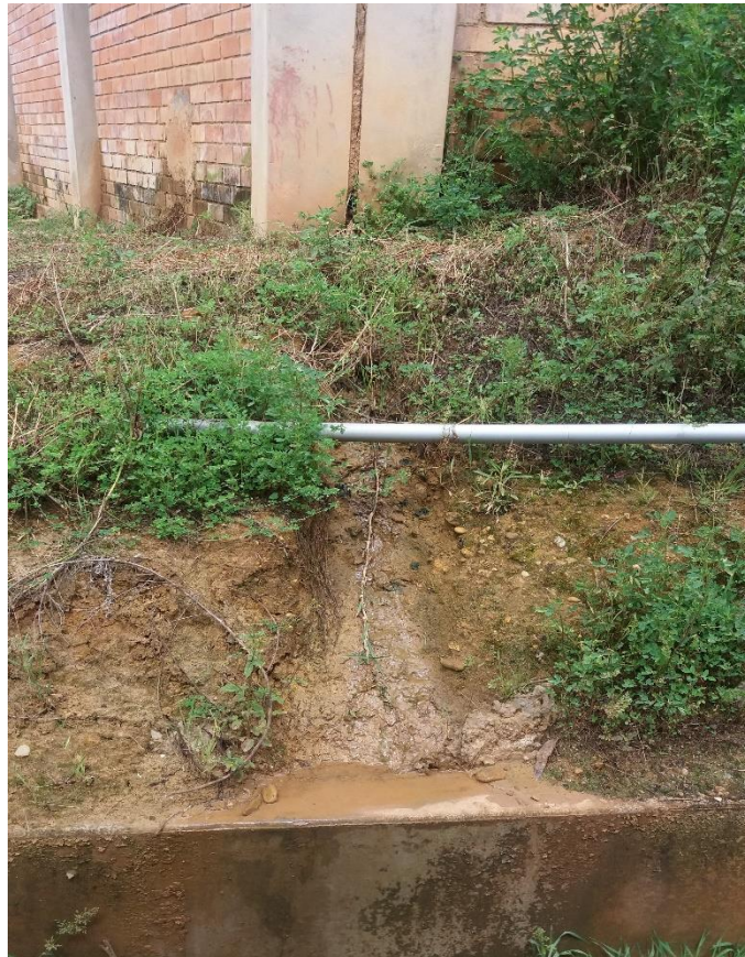
Fotografía 10: Estructuras de drenaje pluvial mal ubicadas
