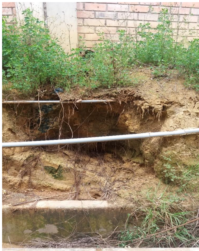
Fotografía 9: Estructuras de drenaje pluvial mal ubicadas
