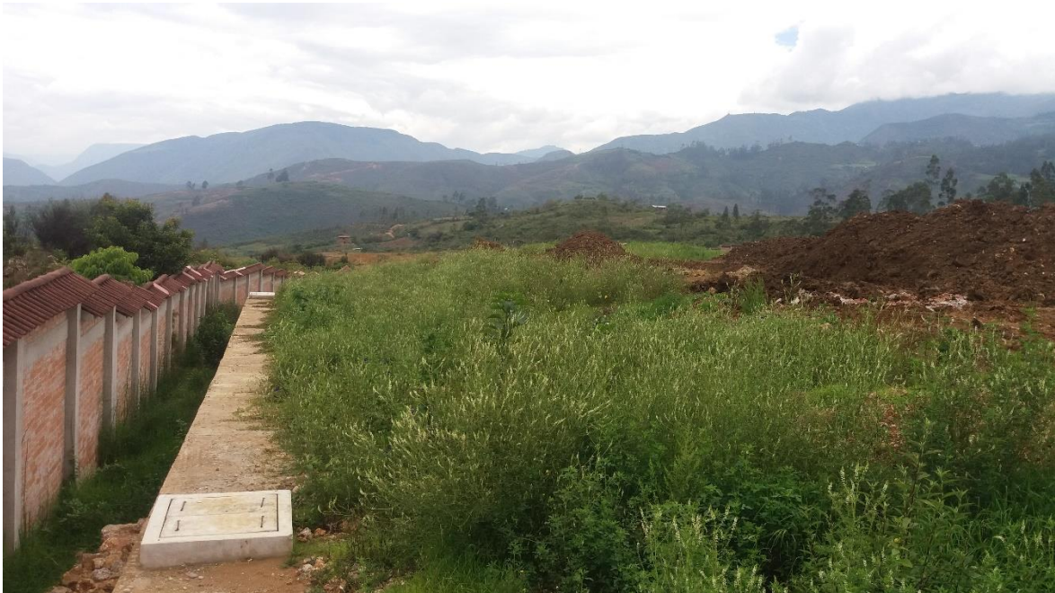
Fotografía 16: Estructuras de drenaje pluvial sobredimensionado
