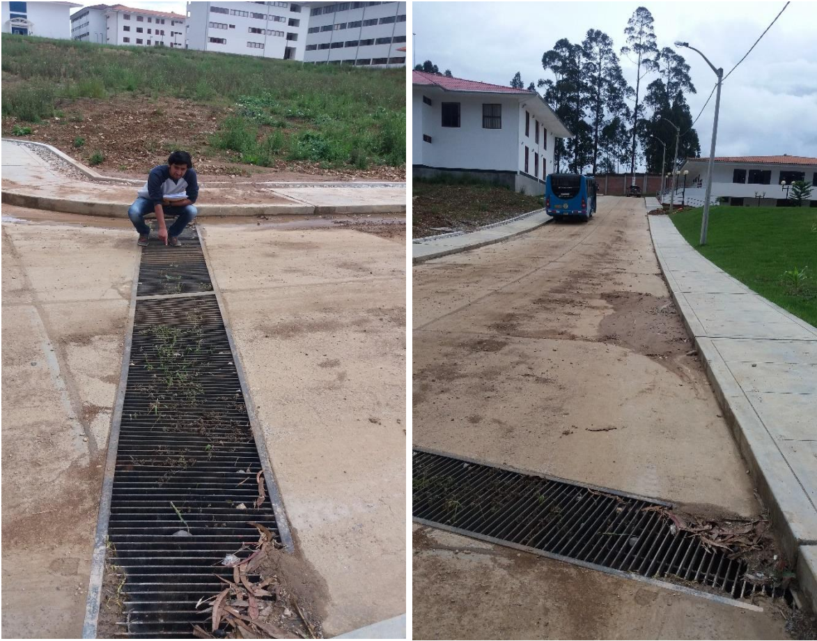
Fotografía 3: Estructuras de drenaje pluvial sin mantenimiento
