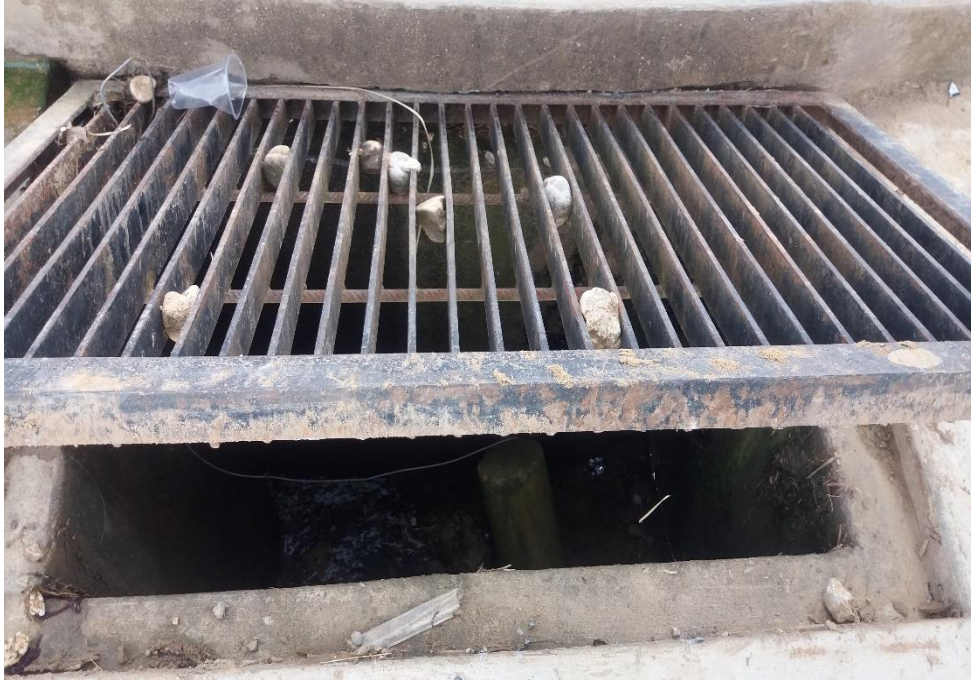
Fotografía 6: Estructuras de drenaje pluvial en mal estado
