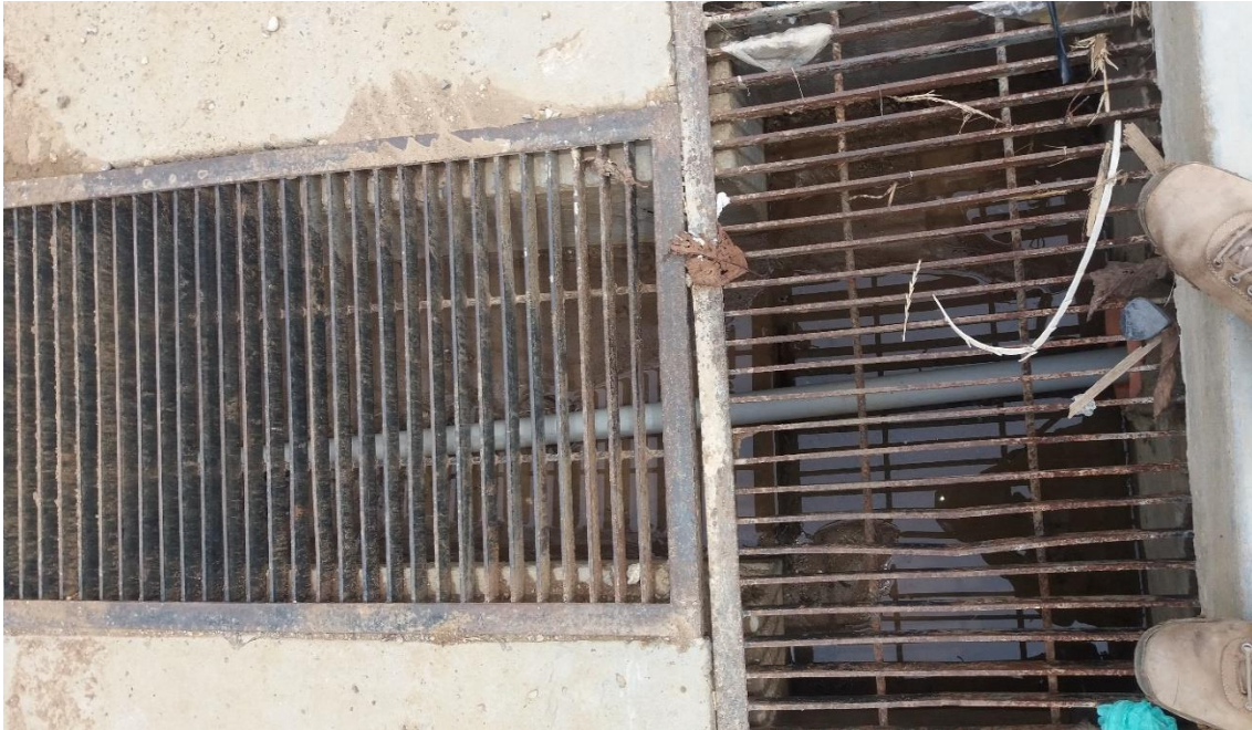
Fotografía 7: Estructuras de drenaje pluvial en mal estado y sin funcionamiento
