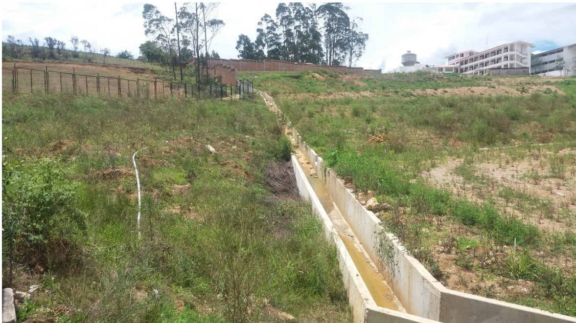
Fotografía 12: Estructuras de drenaje pluvial sobredimensionada
