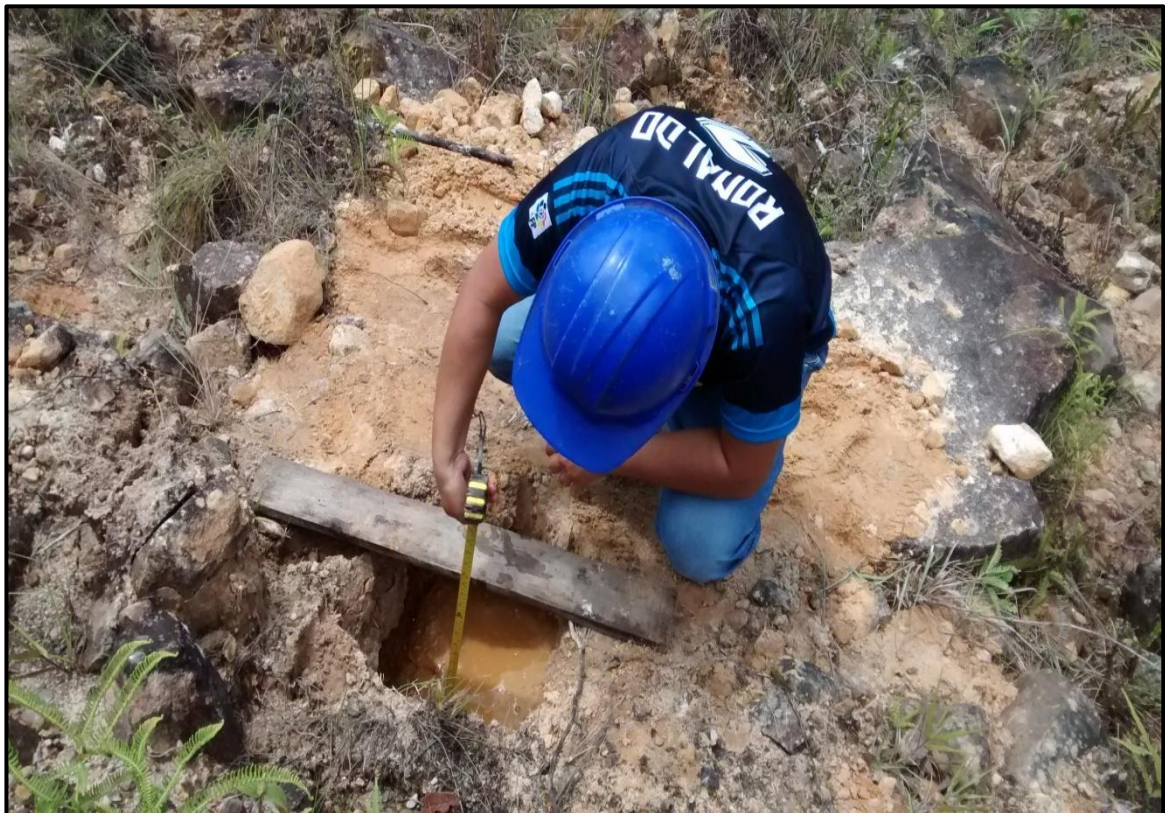
FOTO N° 28. Medición de la pérdida de agua km 07+300 – km 07+320
