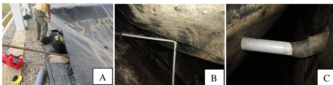
Figura 26. Reparación de tuberías. A: corte de la geomembrana para ingresar al biodigestor. B: tubería de succión reparada para recircular biol. C: subida del nivel para salida de biol del BTLC.
