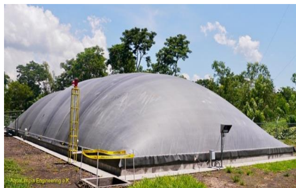
Figura 2. Biodigestor tipo laguna cubierta. Fuente: Moncayo, 2014.
