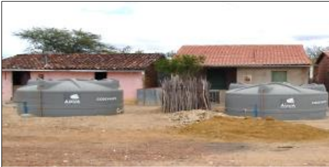
Figura 2. Cisterna de polietileno instalado en el semiárido brasileiro.
