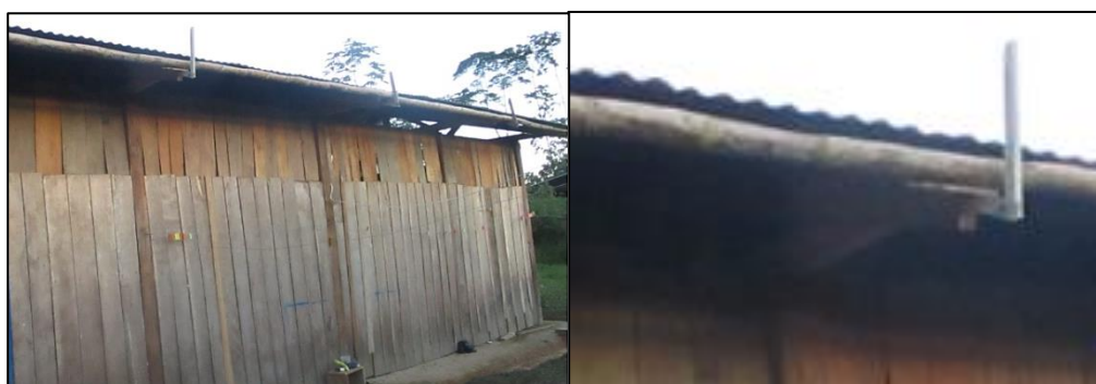
Figura 32. Canaleta de bambú usadas por la Comunidad Awajun de Juum, 2017.
