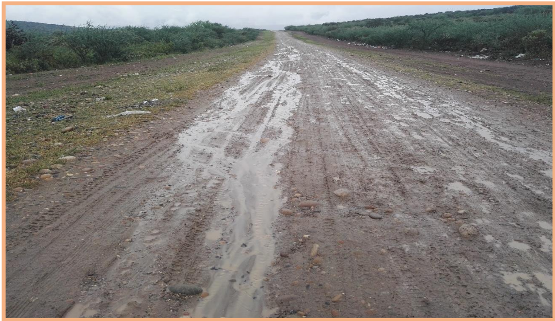
Figura 112: Unidad de Muestra N°2 (630-685m). Falla 81 (Sección Transversal Incorrecta). Según Tabla 9, existe cantidad elevada de pozos de agua (Nivel H), por lo tanto, la longitud máxima sería de 55m.
