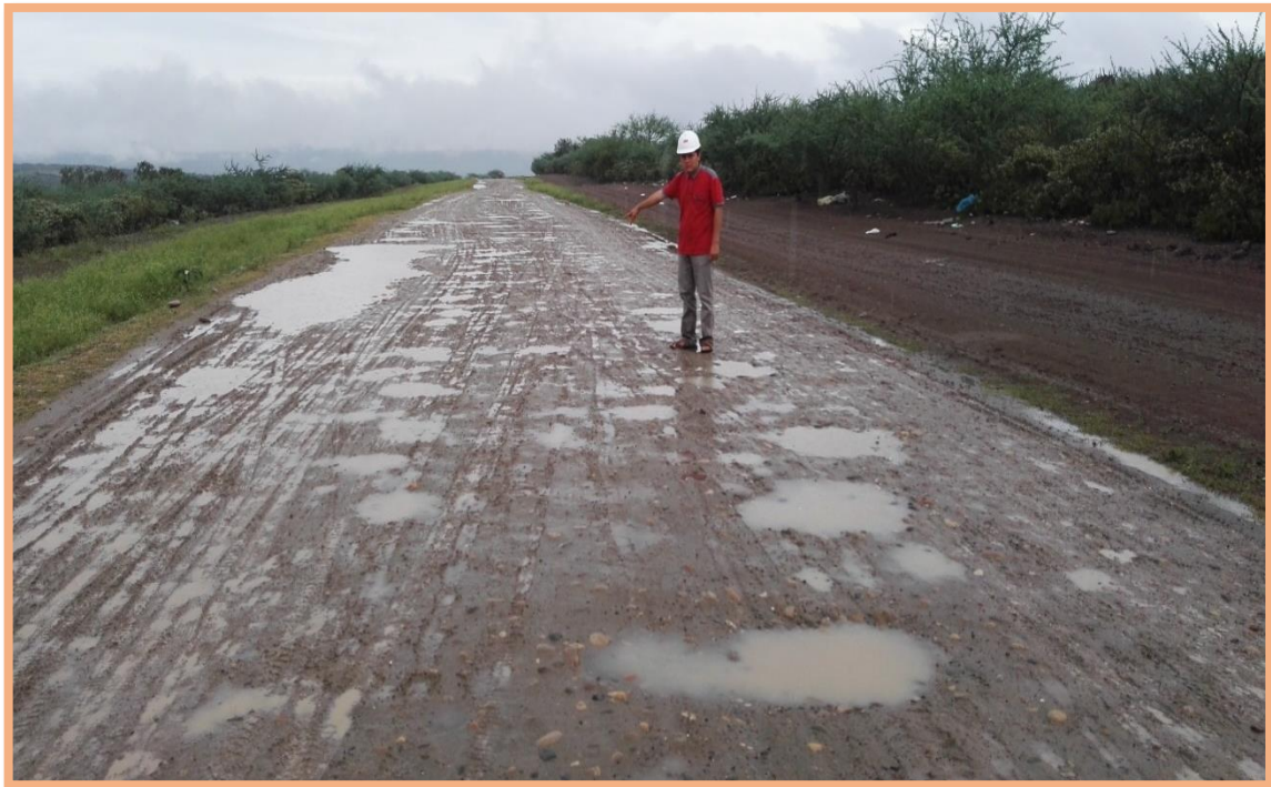
Figura 61: Sección N°2 (0.5-1km). Falla de baches y deformación, encontrado en el 906m, según Tabla 2, menciona que este tipo de bache es de gravedad 3, necesita una reconstrucción. Además, existe deformación mínima (<5cm) en todo el ancho de plataforma.
