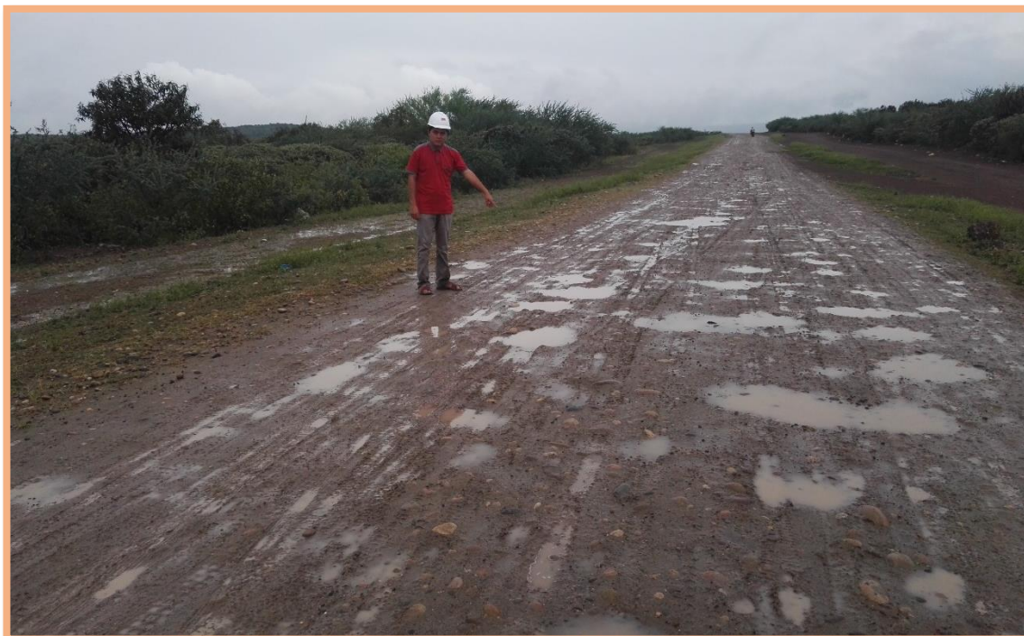
Figura 115: Unidad de Muestra N°2 (630-685m). Falla 85 (Baches). Según Tabla 9, se ha encontrado 4 baches de mediana severidad (Nivel M), 28 baches de baja severidad (Nivel L).
