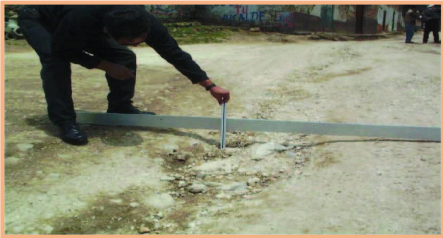
Figura 6: Erosión, Gravedad 3: Profundidad \geq 10 cm. Se observa una erosión muy notoria, de altura mayor a los 10 cm.
