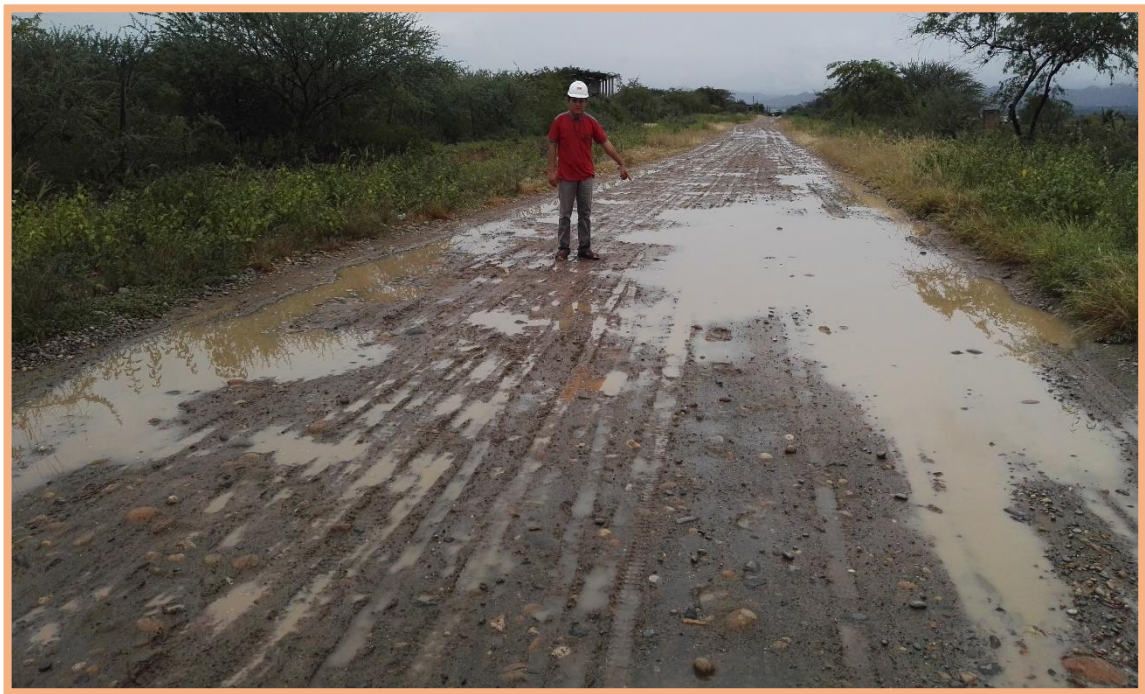
Figura 98: Sección N°8 (3.5-3.7km). Falla de bache y deformación, se presentó en el 3.59km, según la Tabla2 específica para baches que es de gravedad 3, necesita una reconstrucción. Deformación en todo el ancho de plataforma de gravedad 1, sensible al usuario <5cm.
