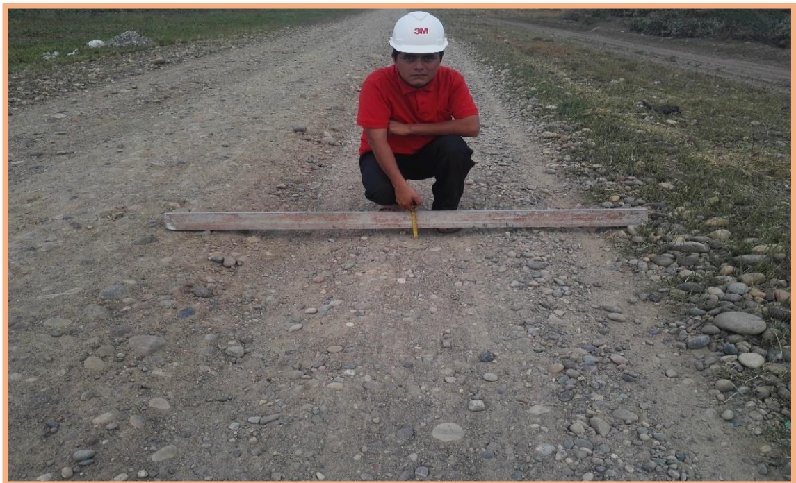
Figura 70: Sección N°3 (1-1.5km). Falla de deformación (ahuellamiento), desde 1.321km hasta 1.50km (179m de extensión), en el lado derecho presenta un ancho de 1.65m y 4.50cm de altura, también en el lado izquierdo presenta ancho de 1.20m y altura de 4.80cm, según Tabla 2, es de severidad 1.
