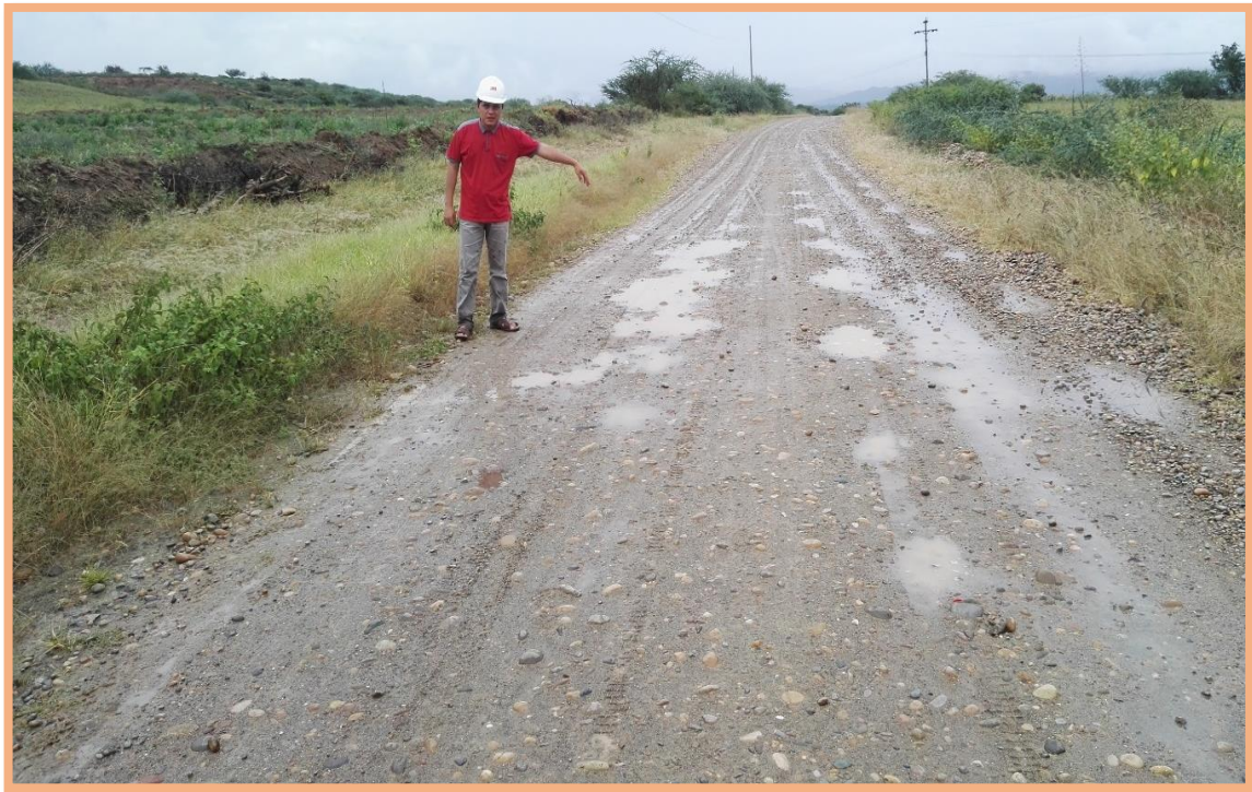
Figura 91: Sección N°7 (3-3.5km). Falla de bache y deformación, se presentó en el 3.28km, según la Tabla2 especifica que es de gravedad 3, necesita una reconstrucción. Además, existe deformación mínima (<5cm) en todo el ancho de plataforma.
