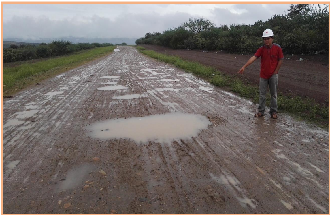
Figura 62: Sección N°2 (0.5-1km). Falla de baches y deformación, encontrado en el 953m, según Tabla 2, menciona que este tipo de bache es de gravedad 3, necesita una reconstrucción. Además, existe deformación mínima (<5cm) en todo el ancho de plataforma.
