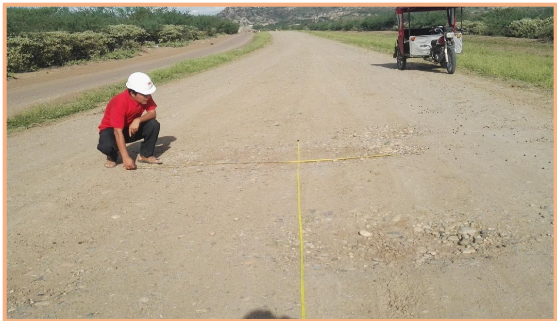
Figura 119: Unidad de Muestra N°3 (1.130km-1.185km). Falla 85 (Baches). Según Tabla 9, se ha encontrado 2 baches de alta severidad (Nivel H), 11 baches de baja severidad (Nivel L).
