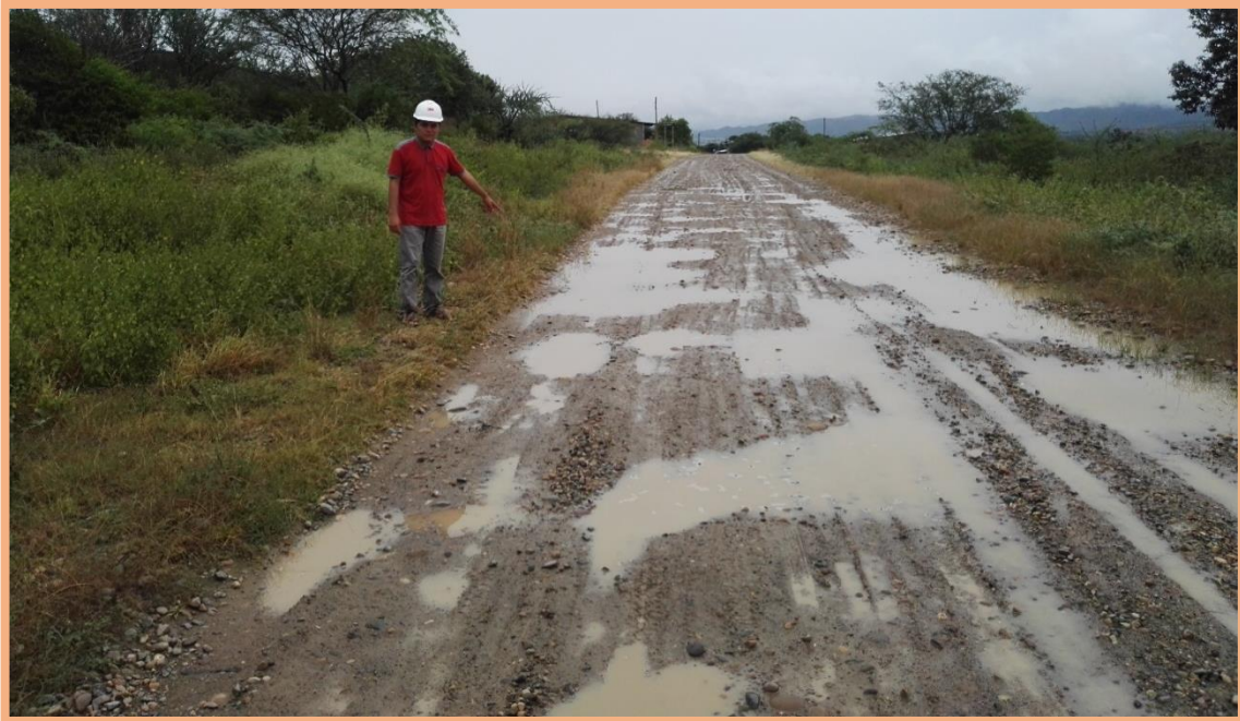
Figura 101: Sección N°8 (3.5-3.7km). Falla de bache y deformación, se presentó en el 3.65km, según la Tabla 2 específica para baches que es de gravedad 3, necesita una reconstrucción. Deformación en todo el ancho de plataforma, de gravedad 1, sensible al usuario <5cm.
