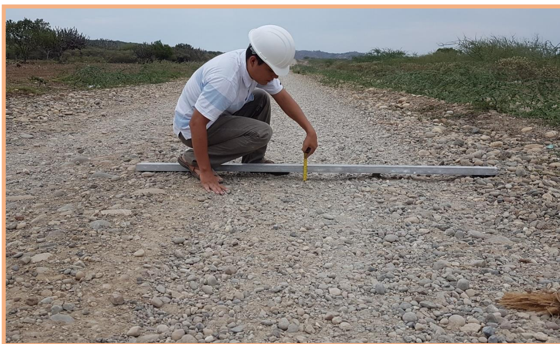
Figura 68: Sección N°3 (1-1.5km). Falla de deformación (ahuellamiento), desde 1.160km hasta 1.321km (161m de extensión), en el lado derecho presenta un ancho de 1.90m y 6.30cm de altura, según Tabla 2, es de severidad 2.
