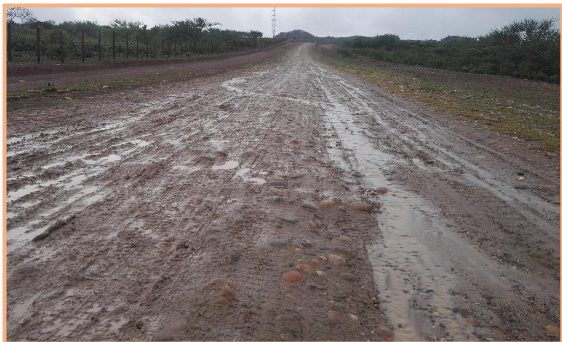
Figura 105: Unidad de Muestra N°1 (202-257m). Falla 81 (Sección Transversal Incorrecta). Según Tabla 9, existe moderada cantidad de agua (Nivel M), con longitud de 55m
