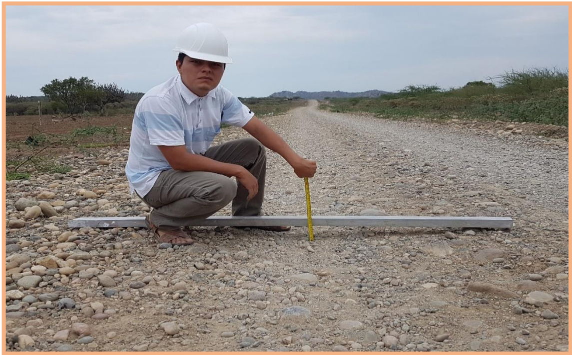
Figura 69: Sección N°3 (1-1.5km). Falla de deformación (ahuellamiento), desde 1.160km hasta 1.321km (161m de extensión), en el lado izquierdo presenta un ancho de 1.10m y 8.70cm de altura, según Tabla 2, es de severidad 2
