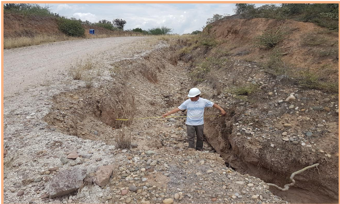
Figura 82: Sección N°6 (2.5-3km). Falla de erosión, la erosión se presentó en el tramo de 2.650km hasta 2.705km (55m de extensión), de altura de 1.30m y con ancho de 2.10m (según Tabla 2 menciona que es de gravedad 3).
