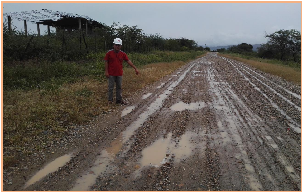
Figura 100: Sección N°8 (3.5-3.7km). Falla de bache y deformación, se presentó en el 3.63km, según la Tabla 2 específica para baches que es de gravedad 2, necesita una capa de material adicional. Deformación en todo el ancho de la plataforma de gravedad 1, h < 5\text{cm} .
