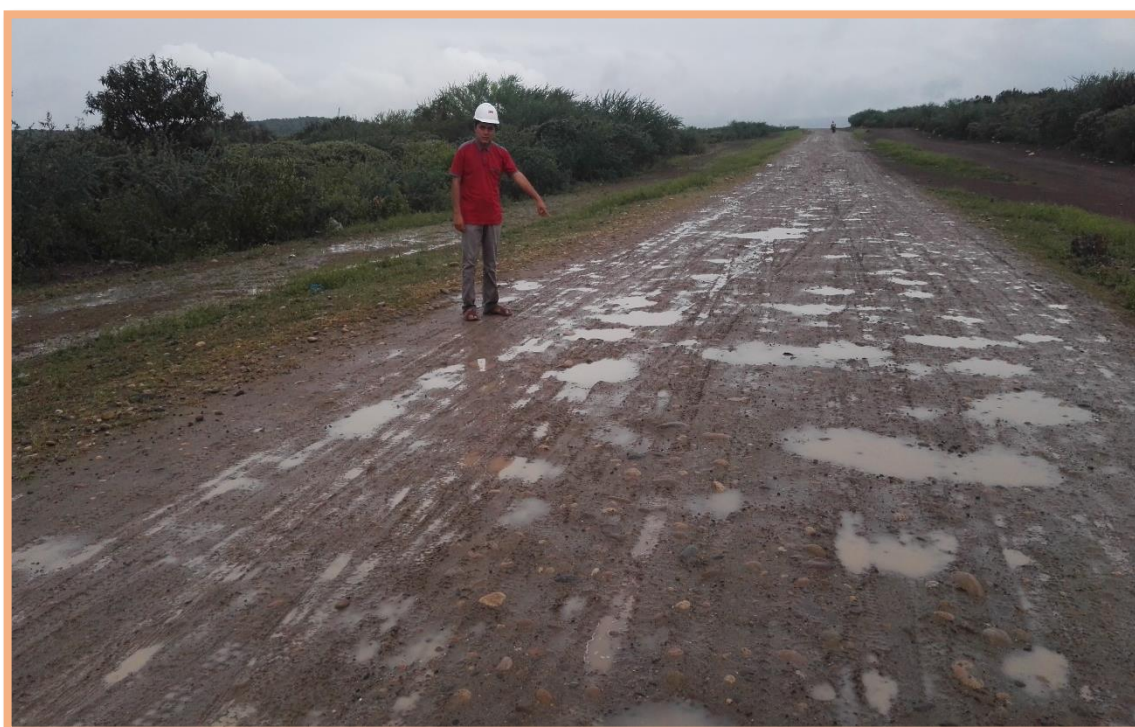
Figura 52: Sección N°1 (0-500m). Falla de baches, encontrado en el 440m, según la Tabla2, menciona que este tipo de bache es de gravedad 3, necesita una reconstrucción.
