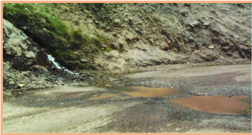
Figura 12: Cruce de agua. Se observa como la humedad constante, añadiéndole el tráfico, perjudica a la vía no pavimentada.
