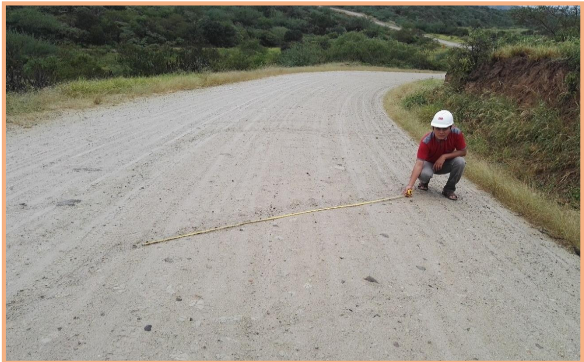
Figura 84: Sección N°6 (2.5-3km). Falla de erosión, se presentó en el 3.00km, con altura de 2.5cm, ancho 37cm y longitud de 2.85m, en la parte posterior existen dos fallas del mismo tipo con altura de 1.5 cm, pero longitud de 2.42 y 2.28, donde su ancho respectivo es 23cm y 28cm. Según la Tabla2 especifica que todas son de gravedad 1.
