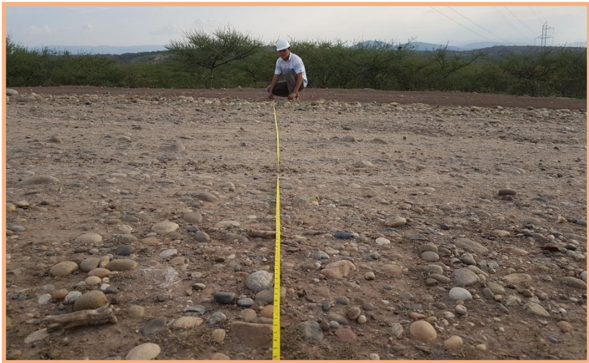
Figura 49: Sección N°1 (0-500m). Medición del ancho de la calzada, dando 5.50m de longitud.
