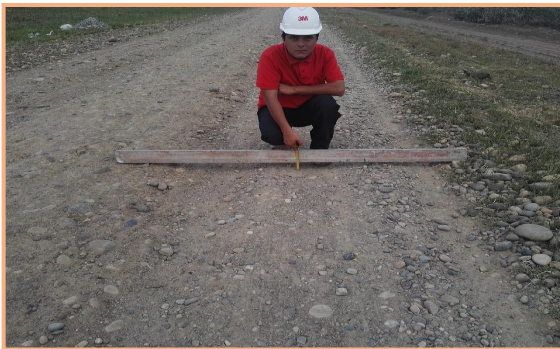
Figura 128: Unidad de Muestra N°4 (1.322km-1.377km). Falla 86 (Surcos), según Tabla 9, la profundidad de la falla en ambos lados de la calzada es de Nivel M. Su longitud es de 55m y con ancho de casi toda la calzada que es de 2.85m.
