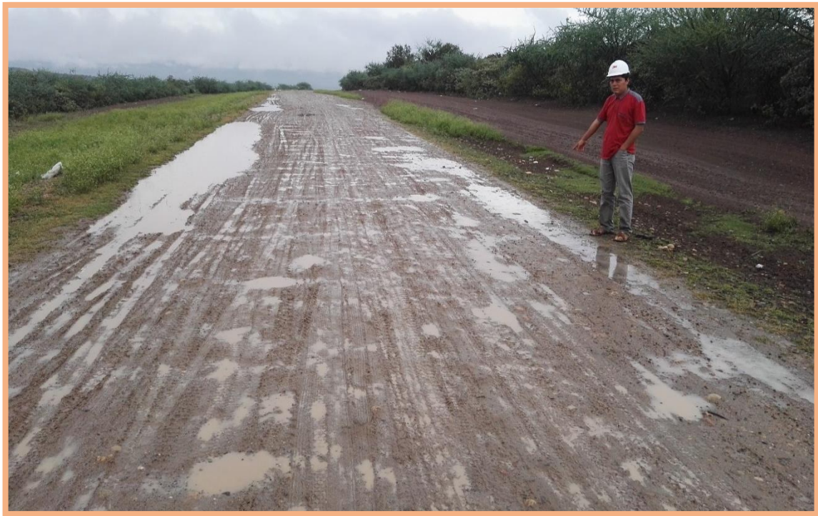
Figura 63: Sección N°2 (0.5-1km). Falla de baches y deformación, encontrado en el 971m, según Tabla 2, menciona que este tipo de bache es de gravedad 3, necesita una reconstrucción. Además, existe deformación mínima (<5cm) en todo el ancho de plataforma hasta 1+000 km.
