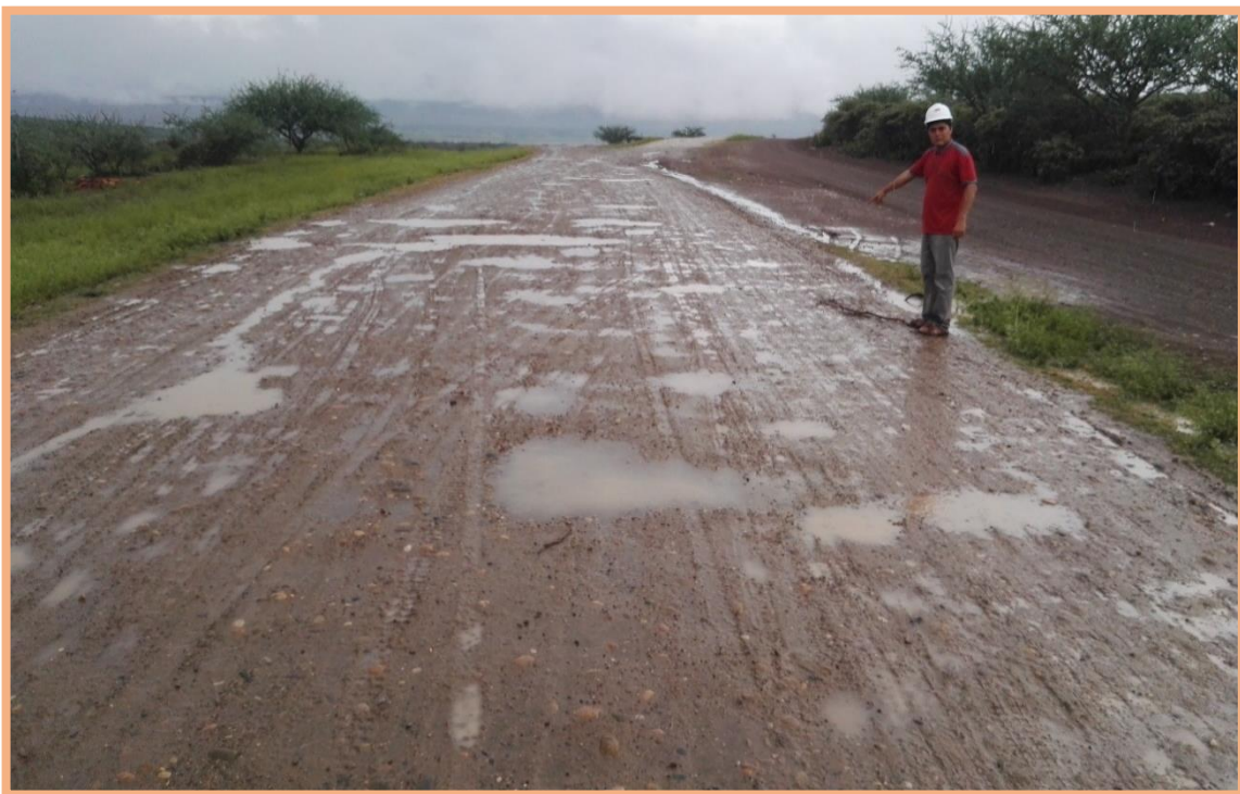
Figura 66: Sección N°3 (1-1.5km). Falla de baches y deformación, encontrado en el 1.130km, según Tabla 2, menciona que este tipo de bache es de gravedad 3, necesita una reconstrucción. Además, existe deformación mínima (<5cm) en todo el ancho de plataforma.
