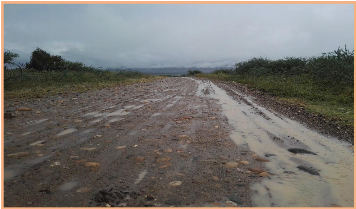
Figura 131: Unidad de Muestra N°5 (2.315km-2.370km). Falla 81 (Sección transversal incorrecta), según Tabla 9, es de alta severidad (Nivel H), por la cantidad elevada de pozos de agua, su longitud es la máxima de 55m.
