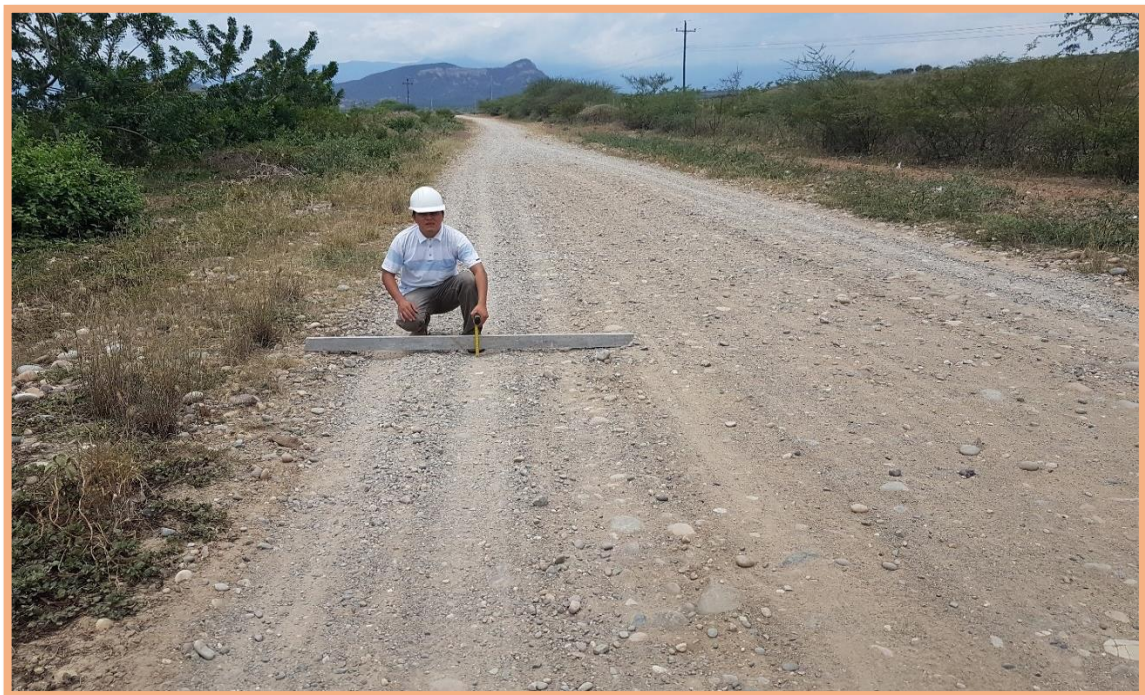
Figura 151: Unidad de Muestra N°8 (3.540km-3.590km). Falla 86 (Surcos), según Tabla 9, es de severidad alta (Nivel H), por tener una profundidad de 7.6 cm y ancho de 2.05 m (parte derecha), también en la parte izquierda de 1.80 m y h=6.3 cm (M), ambos de longitud de 10m.
