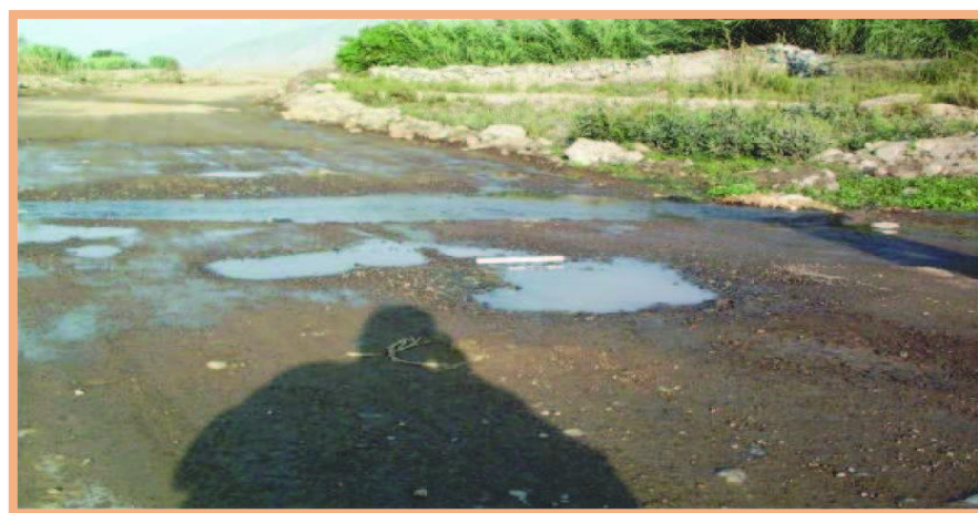
Figura 9: Baches (Huecos), Gravedad 3: Necesita una reconstrucción
