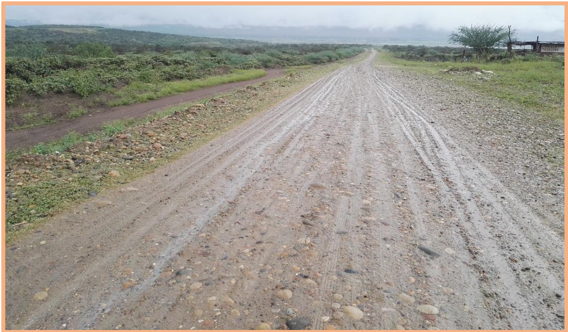
Figura 125: Unidad de Muestra N°4 (1.321km-1.376km). Falla 81 (Sección transversal incorrecta), según Tabla 9, es de baja severidad (Nivel L), por la baja cantidad de pozos de agua, su longitud es de 55m.
