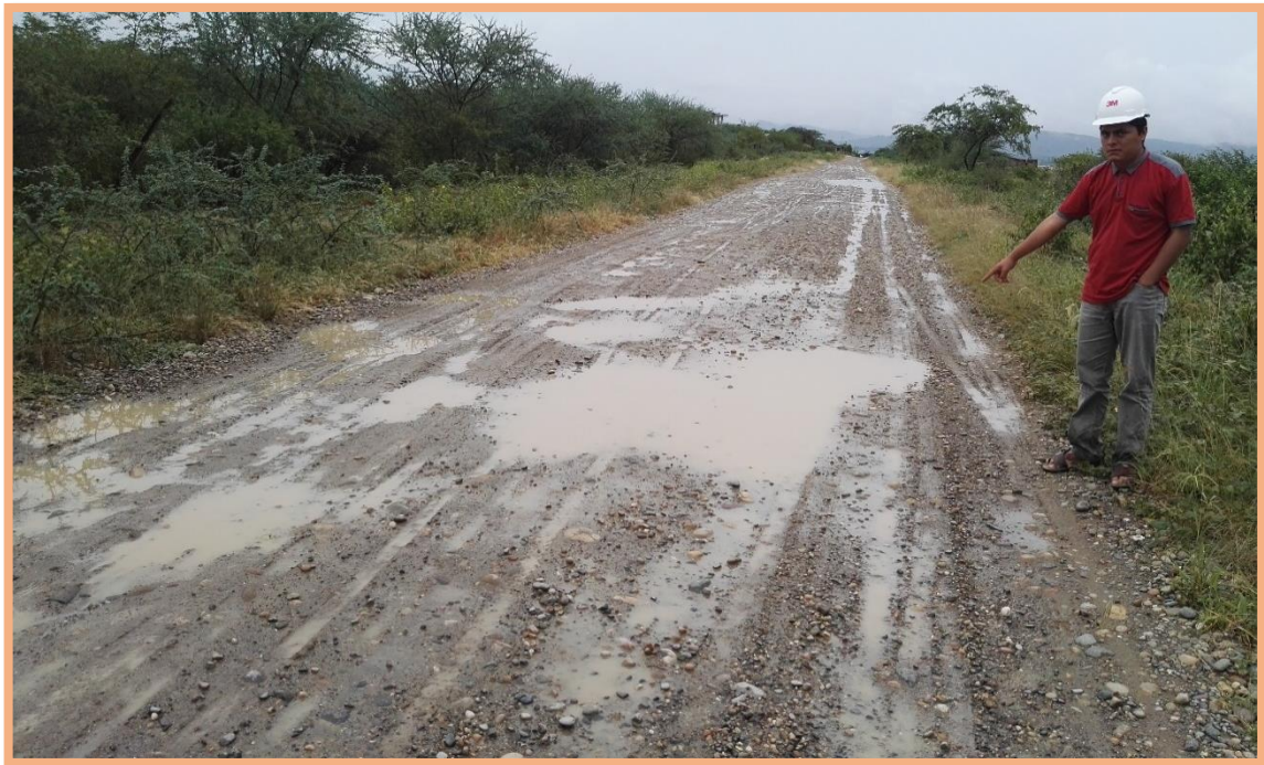
Figura 152: Unidad de Muestra N°8 (3.540km-3.590km). Falla 85 (Baches) y Falla 87 (Agregado Suelto). Falla 85, según Tabla 9, 3 baches son de severidad media (Nivel M), 5 baches son de severidad baja (Nivel L). Falla 87, según Tabla 9, es de severidad baja (Nivel L), por ser la altura <math>< 5\text{cm}</math> y con extensión 100 m, por presentarse ambos lados de la calzada.
