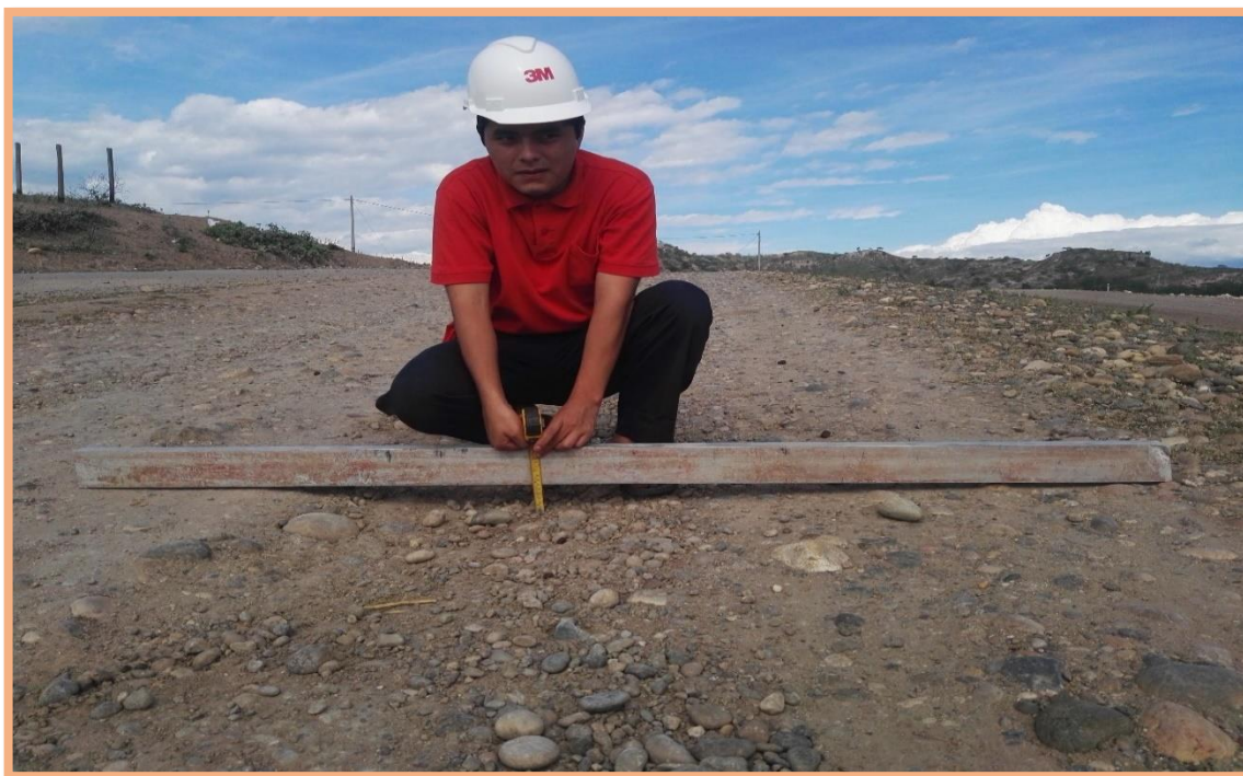
Figura 108: Unidad de Muestra N°1 (202-257m). Falla 86 (Surcos). Según Tabla 9, presenta profundidad de 8 cm >7.5 cm (Nivel H), situado en la parte izquierda de la calzada, tiene longitud de toda la muestra (55m) y ancho de 1.40 m.
