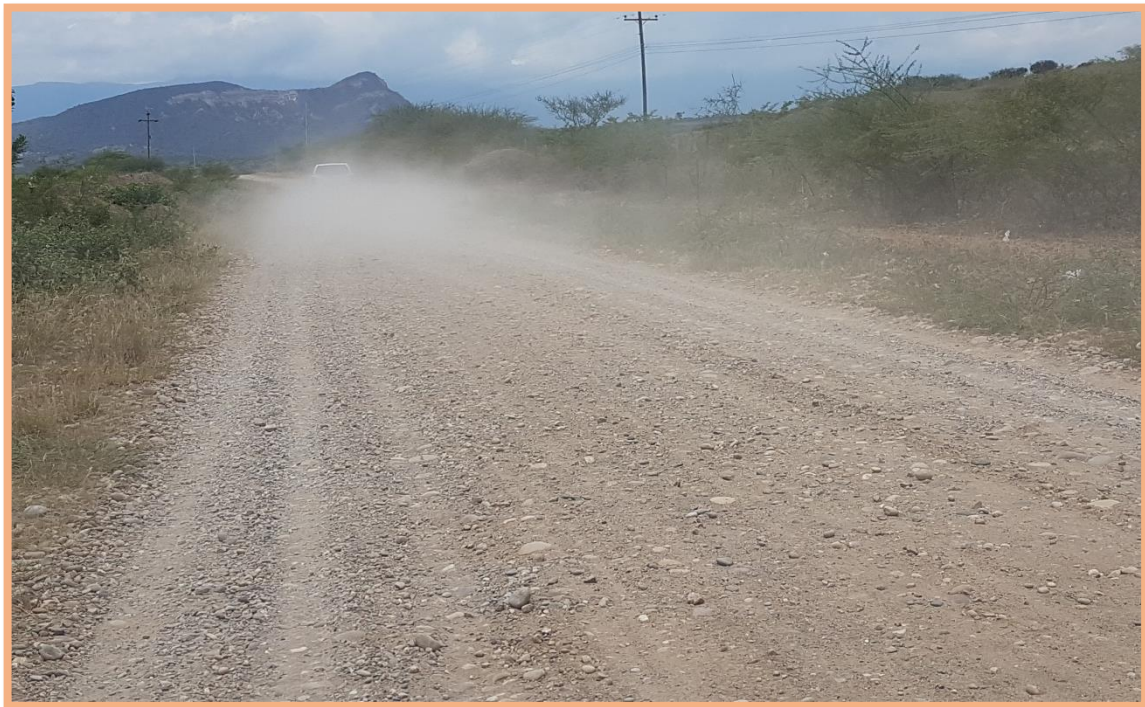
Figura 150: Unidad de Muestra N°8 (3.540km-3.590km). Falla 84 (Polvo), según Tabla 9, es de severidad alta (Nivel H), ya que existe graves problemas de visibilidad.
