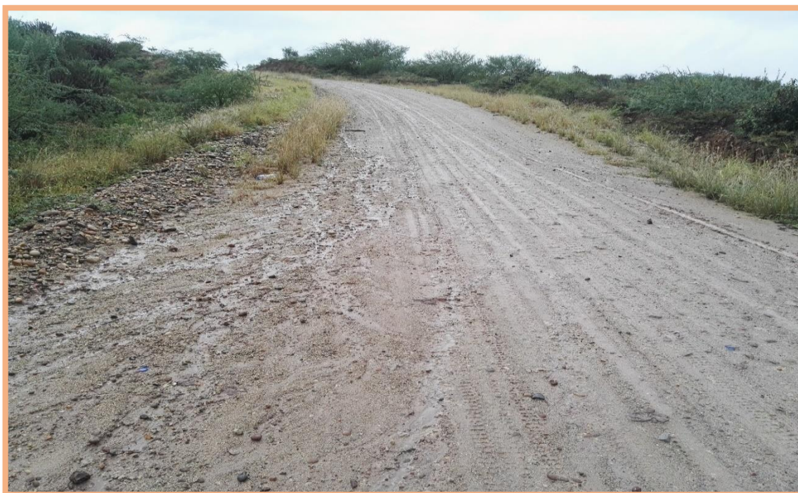
Figura 140: Unidad de Muestra N°6 (2.640km-2.690km). Falla 87 (Agregado suelto), según Tabla 9, la altura <math><5\text{cm}</math>, por lo que es de severidad baja (Nivel L), con extensión de 50m.
