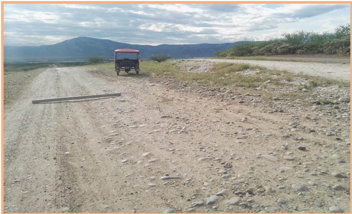
Figura 123: Unidad de Muestra N°3 (1.130km-1.185km). Falla 87 (Agregado Suelto), según Tabla 9, se caracteriza de baja severidad (Nivel L), por ser <5 cm, su longitud es de 110m.
