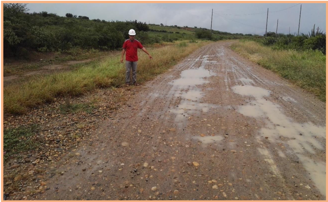
Figura 87: Sección N°7 (3-3.5km). Falla de bache y deformación, se presentó en el 3.14km, según la Tabla2 especifica que es de gravedad 3, necesita una reconstrucción. Además, existe deformación mínima (<5cm) en todo el ancho de plataforma.
