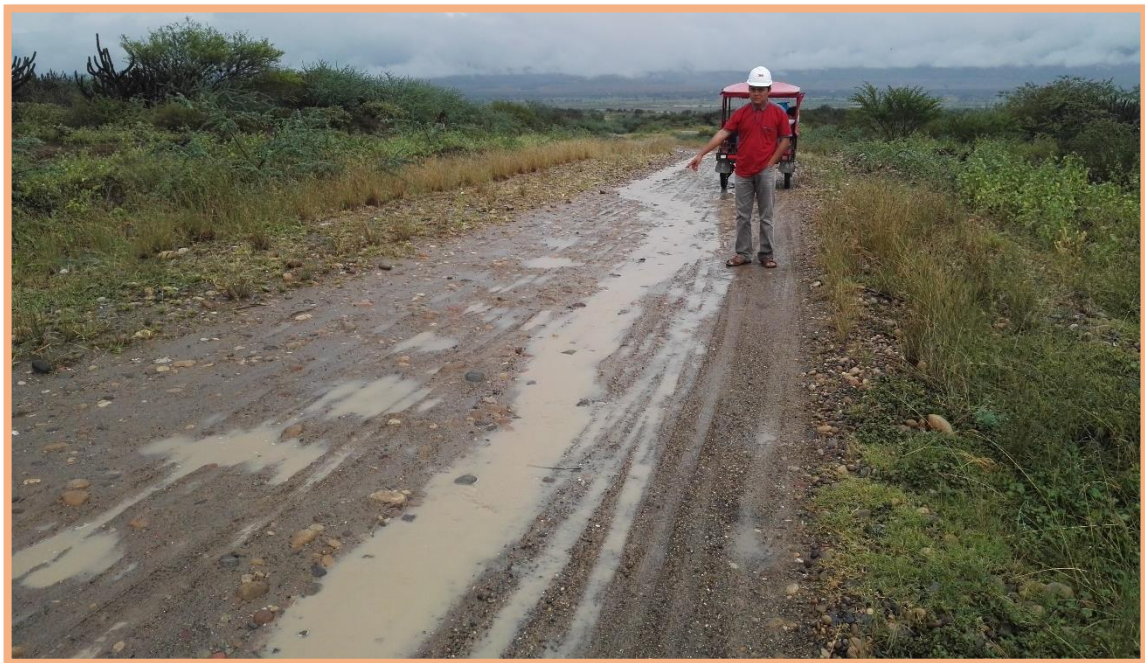
Figura 78: Sección N°6 (2.5-3km). Falla de erosión, la erosión se presentó en el tramo de 2.40km-2.59km (190m de extensión), de altura de 3.5cm y con ancho de 0.45m (según Tabla 2 menciona que es de gravedad 1)
