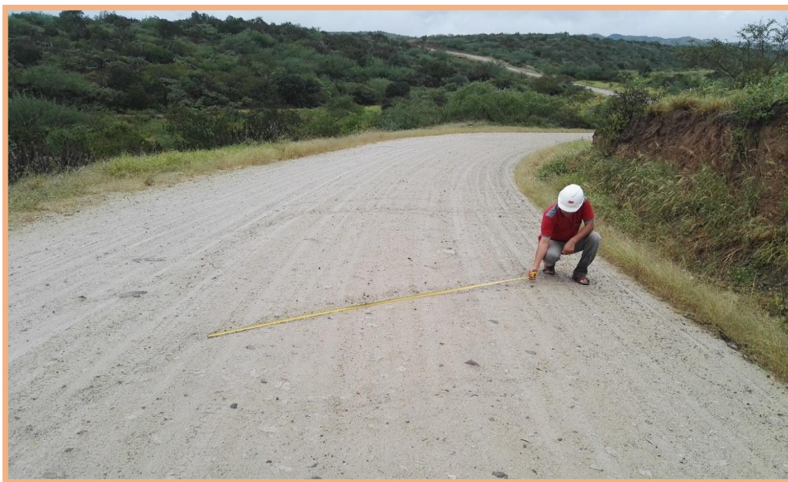
Figura 144: Unidad de Muestra N°7 (3.00km-3.050km). Falla 86 (Surcos), según Tabla 9, es de severidad media (Nivel M), por tener una profundidad de 2.5 cm, longitud de 2.85m y ancho de 37 cm.
