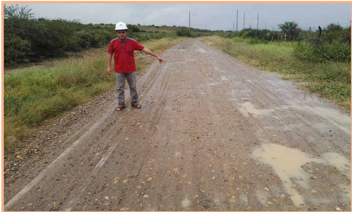
Figura 86: Sección N°7 (3-3.5km). Falla de bache y deformación, se presentó en el 3.11km, según la Tabla2 específica que es de gravedad 2, necesita una capa de material adicional. Además, existe deformación mínima (<5cm) en todo el ancho de plataforma.
