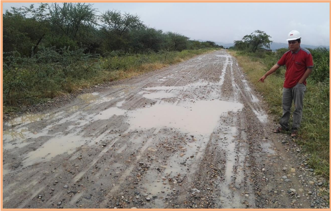
Figura 97: Sección N°8 (3.5-3.7km). Falla de bache y deformación, se presentó en el 3.57km, según la Tabla 2 específica para baches que es de gravedad 3, necesita una reconstrucción. Deformación en todo el ancho de plataforma de gravedad 1, sensible al usuario <5cm.
