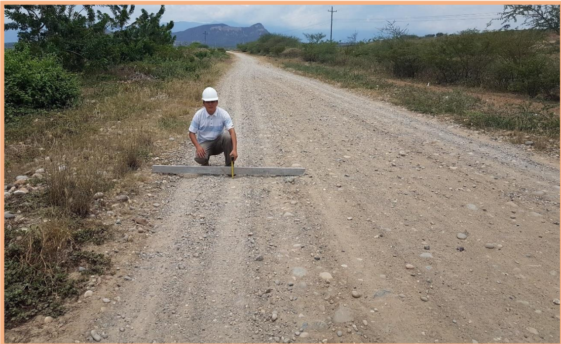
Figura 96: Sección N°8 (3.5-3.7km). Falla de deformación, se presentó a partir del 3.50km hasta 3.55km, en la parte izquierda presenta un ancho de 1.80m y h=6.3\text{cm} ; así como también en la parte derecha un ancho de 2.05m y h=7.6\text{cm} . Según la Tabla 2 especifica que estos son de gravedad 2, huellas entre 5 y 10cm.
