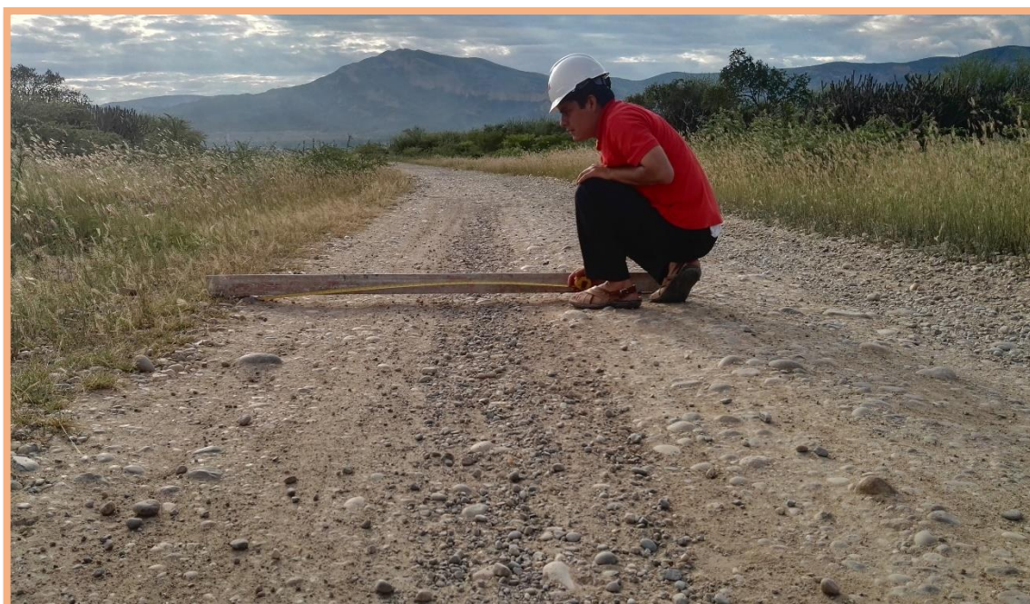
Figura 76: Sección N°5 (2-2.5km). Falla de deformación (ahuellamiento), desde 2km hasta 2.37 km (370m de extensión), de altura de 3.5cm y con ancho de 1.25m, por lo que según la Tabla 2, es de gravedad 1 ( h < 5\text{cm} )
