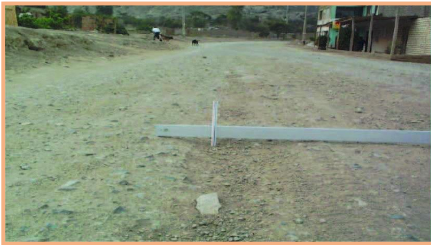
Figura 1: Deformación, Gravedad 1: Huella/ hundimiento sensible al usuario, pero < 5 cm. Se observa la medición respectiva de la falla utilizando un escalímetro y una regla.
