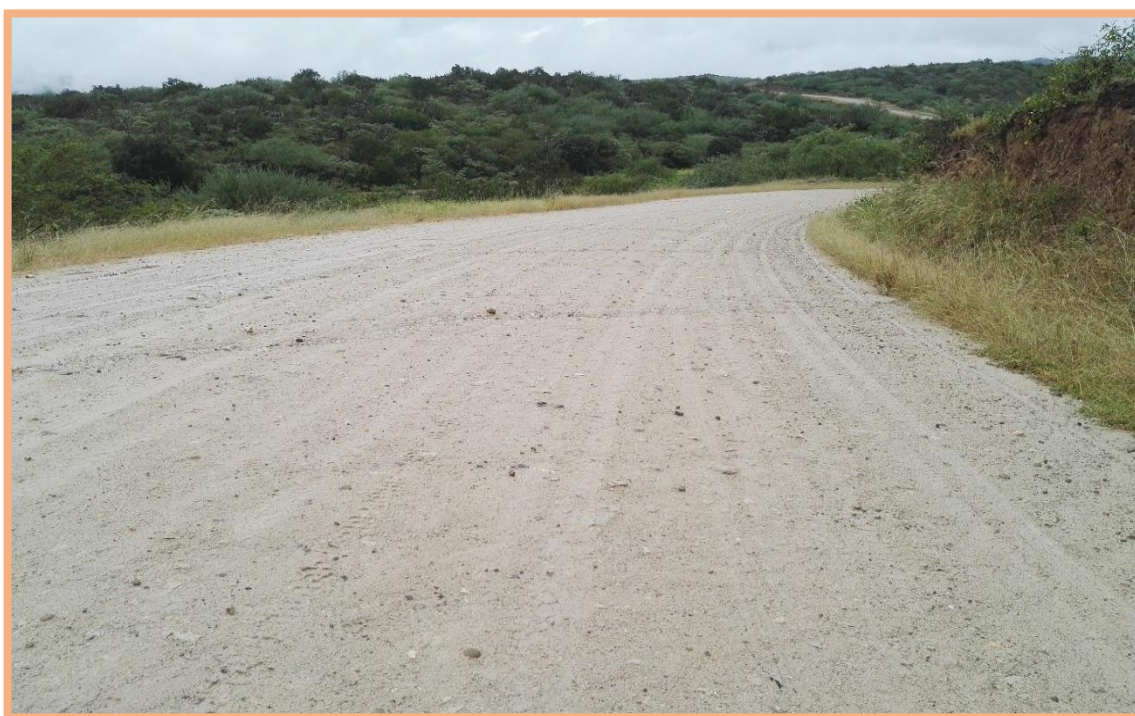
Figura 146: Unidad de Muestra N°7 (3.00km-3.050km). Falla 87 (Agregado suelto), según Tabla 9, la altura <math><5\text{cm}</math>, por lo que es de severidad baja (Nivel L), con extensión de 100 m.
