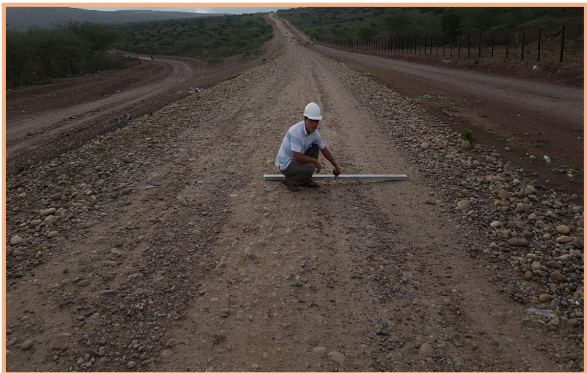
Figura 50: Sección N°1 (0-500m). Falla de deformación (ahuellamiento), encontrado en el 202m hasta el 422m; en el lado derecho, midió un ancho de 1.00 m y una altura de 9 cm. La clasificación según la Tabla 2, menciona que este tipo de deformación es de gravedad 2.
