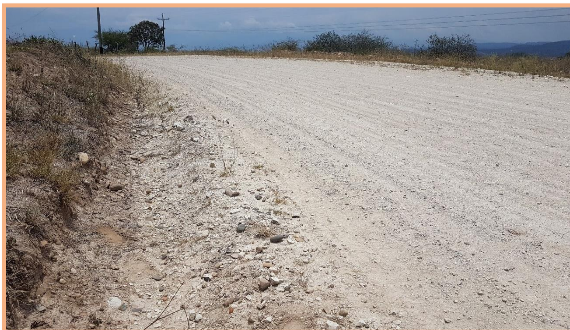
Figura 143: Unidad de Muestra N°7 (3.00km-3.050km). Falla 82 (Drenaje inadecuado), según Tabla 9, es de severidad media (Nivel M), por presentar erosión en la cuneta y crecimiento de vegetación, con extensión de 100 m.
