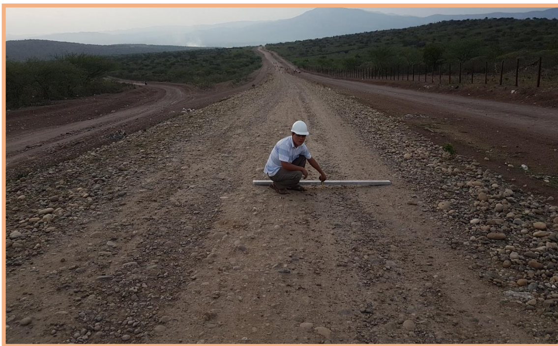
Figura 109: Unidad de Muestra N°1 (202-257m). Falla 86 (Surcos). Según Tabla 9, presenta profundidad de 9 cm >7.5 cm (Nivel H), situado en la parte derecha de la calzada, tiene longitud de toda la muestra (55m) y ancho de 1.00 m.
