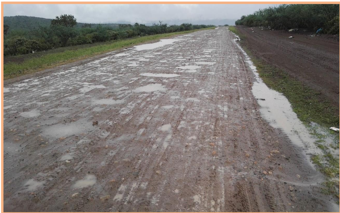
Figura 60: Sección N°2 (0.5-1km). Falla de baches y deformación, encontrado en el 871m, según Tabla 2, menciona que este tipo de bache es de gravedad 3, necesita una reconstrucción. Además, existe deformación mínima (<5cm) en todo el ancho de plataforma.
