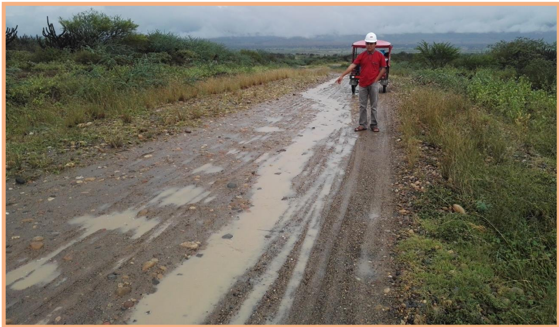
Figura 77: Sección N°5 (2-2.5km). Falla de erosión y baches, la erosión se presentó en el tramo de 2.40km-2.59km (190m de extensión), de altura de 3.5cm y con ancho de 0.45m; también se observa el bache que según Tabla 2, es de gravedad 2, se necesita una capa de material adicional.
