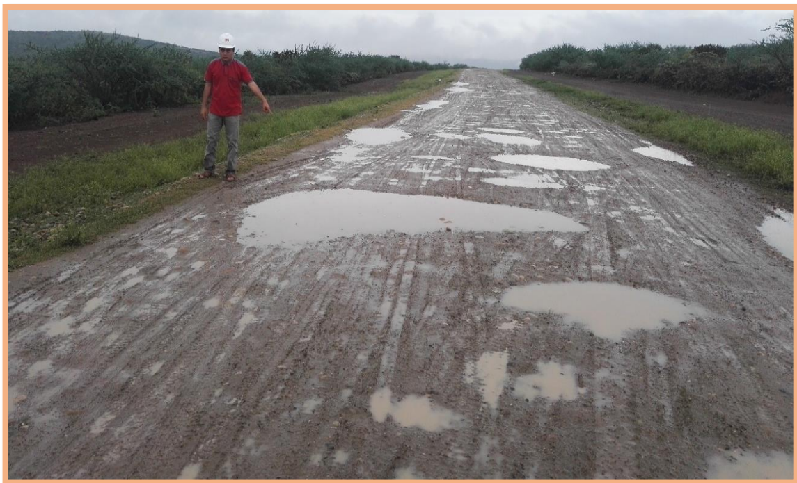
Figura 56: Sección N°2 (0.5-1km). Falla de baches y deformación, encontrado en el 675m, según Tabla 2, menciona que este tipo de bache es de gravedad 3, necesita una reconstrucción. También existe una deformación mínima (<5cm) en todo el ancho de la plataforma.
