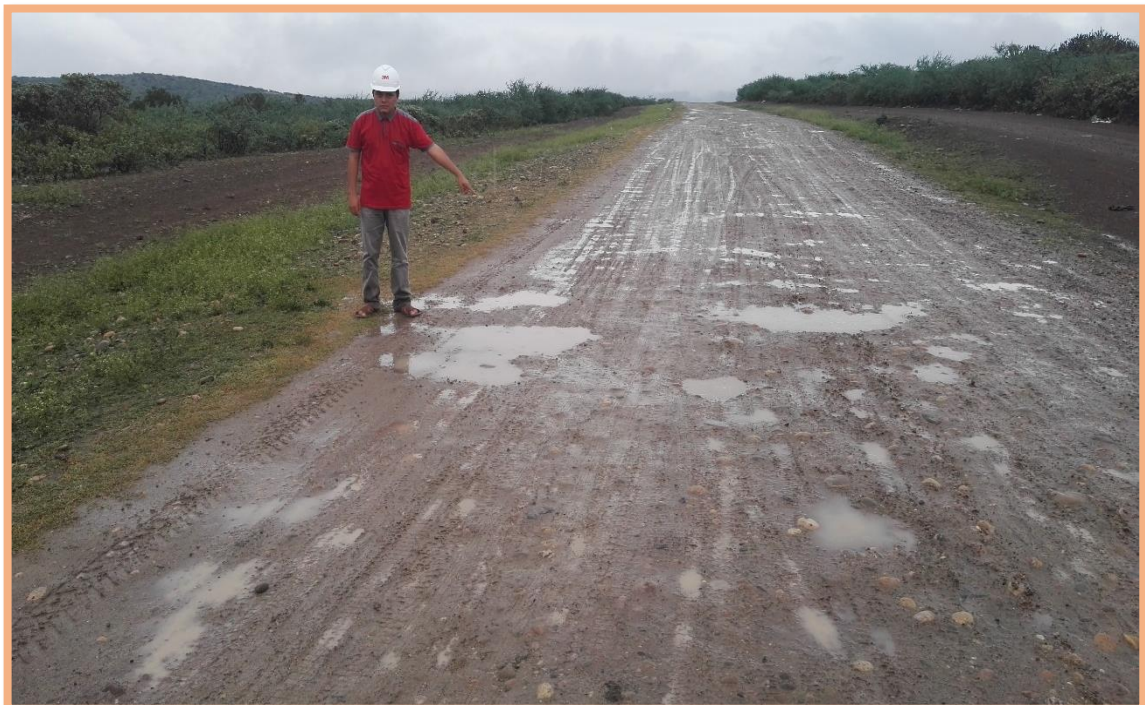
Figura 54: Sección N°2 (0.5-1km). Falla de baches y deformación, encontrado en el 635m, según Tabla 2, menciona que este tipo de bache es de gravedad 3, necesita una reconstrucción. También hay deformación mínima abarcando todo el ancho de plataforma.
