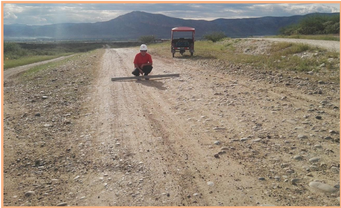
Figura 122: Unidad de Muestra N°3 (1.130km-1.185km). Falla 86 (Surcos o Ahuellamiento), según Tabla 9, se caracteriza de mediana severidad (Nivel M), por ser de 4.5cm de altura, de longitud 25m y un ancho 3.00m.
