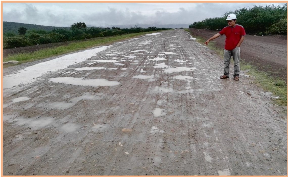
Figura 59: Sección N°2 (0.5-1km). Falla de baches y deformación, encontrado en el 821m, según Tabla 2, menciona que este tipo de bache es de gravedad 3, necesita una reconstrucción. Además, existe deformación mínima (<5cm) en todo el ancho de plataforma.
