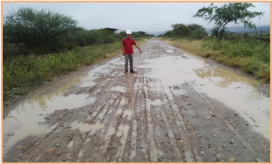
Figura 148: Unidad de Muestra N°8 (3.540km-3.590km). Falla 81 (Sección transversal incorrecta), según Tabla 9, es de severidad alta (Nivel H), cantidad elevada de pozos de agua, con una extensión máxima de 50 m.
