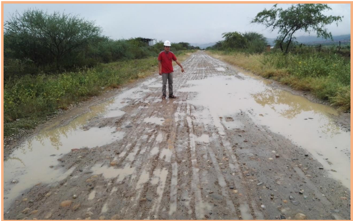
Figura 149: Unidad de Muestra N°8 (3.540km-3.590km). Falla 82 (Drenaje Inadecuado), según Tabla 9, es de severidad alta (Nivel H), por el agua estancada y crecimiento excesivo de vegetación, con extensión máxima de 100m, por presentar en ambos lados de la calzada.
