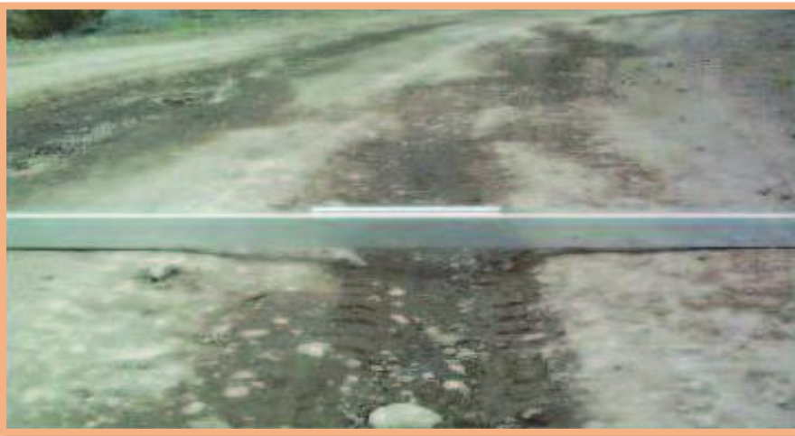
Figura 5: Erosión, Gravedad 2: Profundidad entre 5 cm y 10 cm. Se percibe una erosión moderada, utilizando como medición un escalímetro y una regla.
