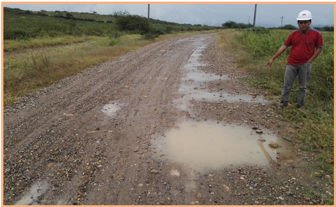
Figura 88: Sección N°7 (3-3.5km). Falla de bache y deformación, se presentó en el 3.17km, según la Tabla2 especifica que es de gravedad 3, necesita una reconstrucción. Además, existe deformación mínima (<5cm) en todo el ancho de plataforma.
