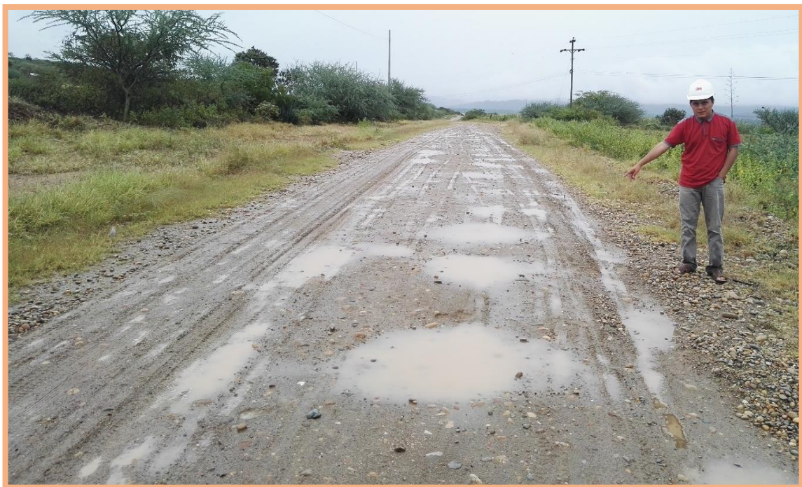
Figura 92: Sección N°7 (3-3.5km). Falla de bache y deformación, se presentó en el 3.32km, según la Tabla2 especifica que es de gravedad 3, necesita una reconstrucción. Además, existe deformación mínima (<5cm) en todo el ancho de plataforma.
