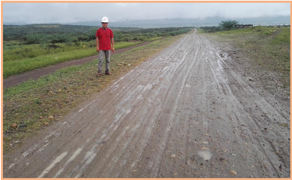
Figura 73: Sección N°4 (1.5-2km). Falla de deformación (ahuellamiento), desde 1.753km hasta 2km (247m de extensión), según Tabla 2 es de gravedad 1 ( h < 5\text{cm} ) y con ancho de 5.50m por ser mínimo en toda la plataforma.
