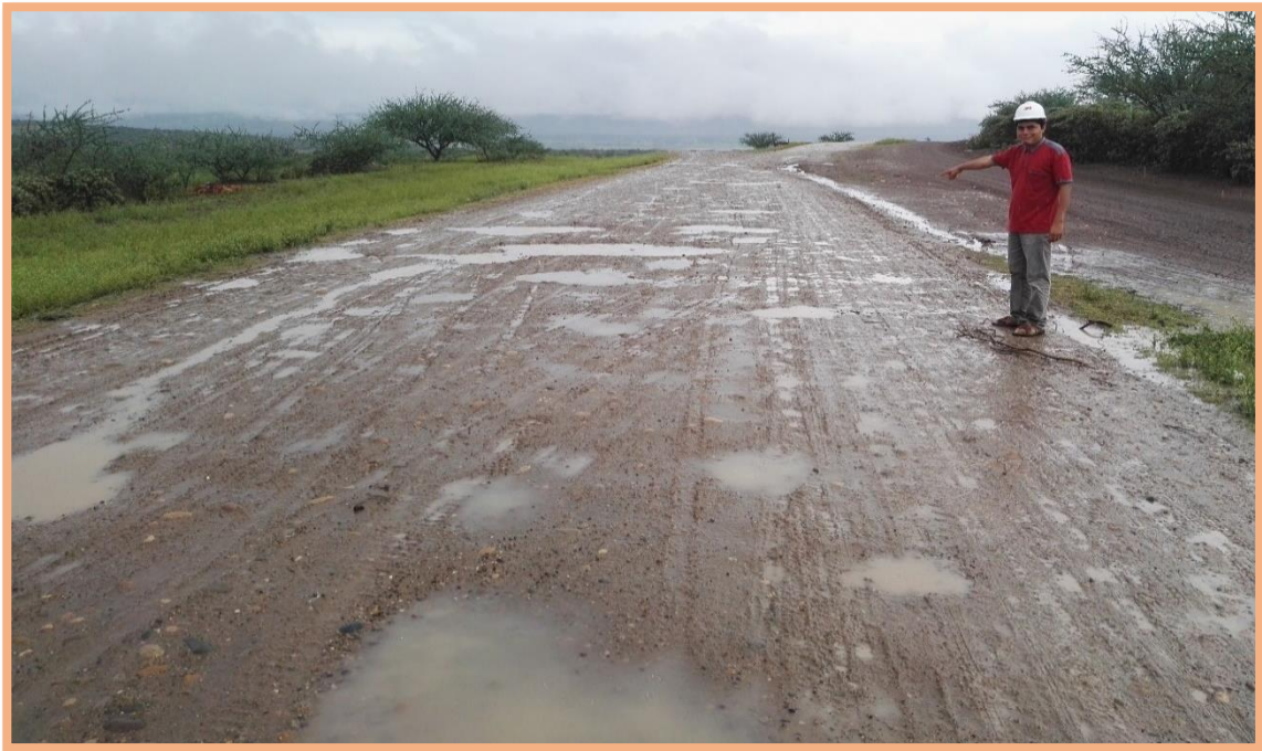
Figura 120: Unidad de Muestra N°3 (1.130km-1.185km). Falla 81 (Sección transversal incorrecta), según Tabla 9, existe elevada cantidad de pozos de agua (H), su longitud es de 15m y el resto de la muestra es de 40m de severidad baja. Falla 85 (Baches), según Tabla 9, se ha encontrado 2 baches de alta severidad (Nivel H), 11 baches de baja severidad (Nivel L).
