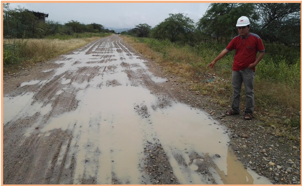
Figura 99: Sección N°8 (3.5-3.7km). Falla de bache y deformación, se presentó en el 3.61km, según la Tabla 2 específica para baches que es de gravedad 3, necesita una reconstrucción. Además, deformación en todo el ancho de plataforma de gravedad 1, sensible al usuario <math><5\text{cm}</math>.
