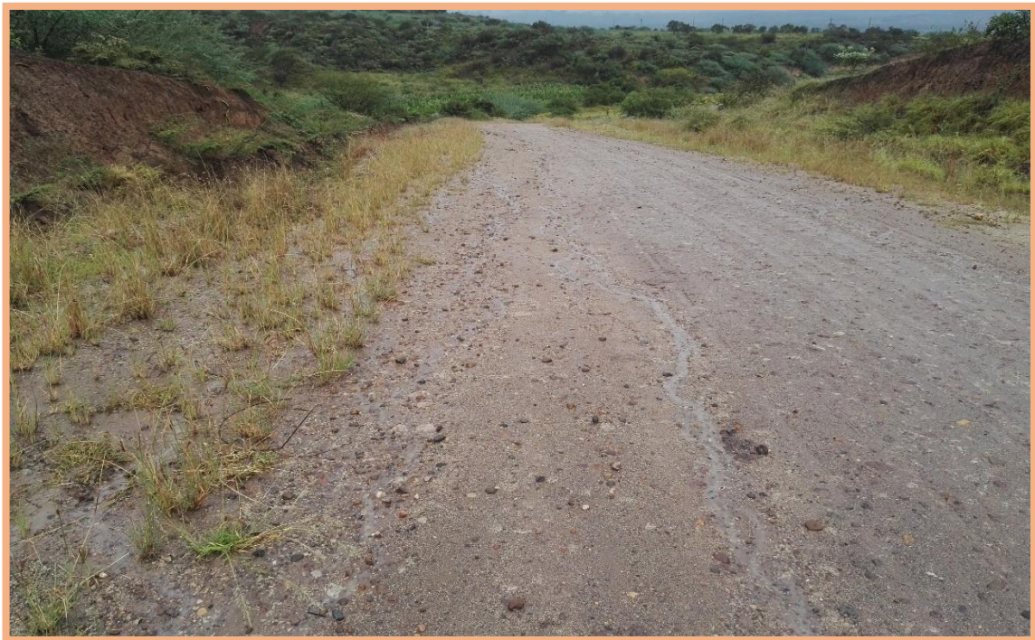
Figura 137: Unidad de Muestra N°6 (2.640km-2.690km). Falla 81 (Sección transversal incorrecta), según Tabla 9, es de baja severidad (Nivel L), por la baja cantidad de pozos de agua, con una extensión de 55m por presentar en toda la unidad de muestra.
