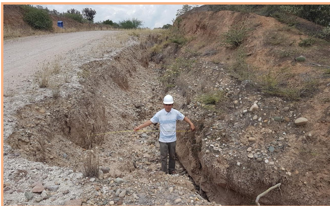
Figura 138: Unidad de Muestra N°6 (2.640km-2.690km). Falla 82 (Drenaje inadecuado), según Tabla 9, es de severidad alta (Nivel H), por presentar erosión de la cuneta y crecimiento de vegetación, además de extensión de 35m (parte izquierda), y en el lado derecho, de 50 m de extensión con severidad media (Nivel M).
