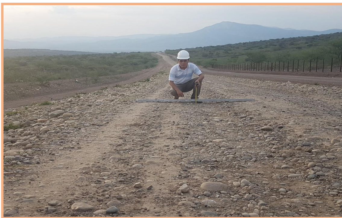
Figura 51: Sección N°1 (0-500m). Falla de deformación (ahuellamiento), encontrado en el 202m hasta el 422m, en el lado izquierdo, midió un ancho de 1.40 m y una altura máxima de 8cm. Según la Tabla 2, menciona que este tipo de deformación es de gravedad 2.
