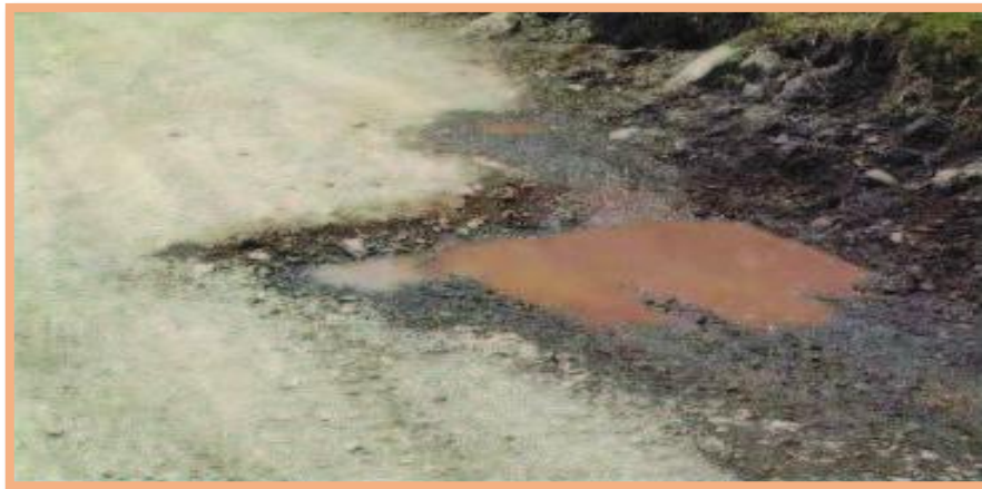
Figura 7: Baches (Huecos), Gravedad 1: Pueden repararse por mantenimiento rutinario.
