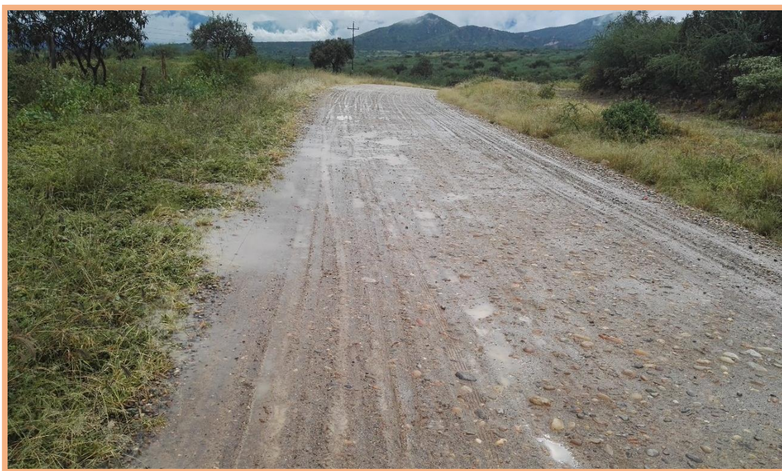
Figura 142: Unidad de Muestra N°7 (3.00km-3.050km). Falla 81 (Sección transversal incorrecta), según Tabla 9, es de baja severidad (Nivel L), por la baja cantidad de pozos de agua, con una extensión de 35m por presentar en toda la unidad de muestra.
