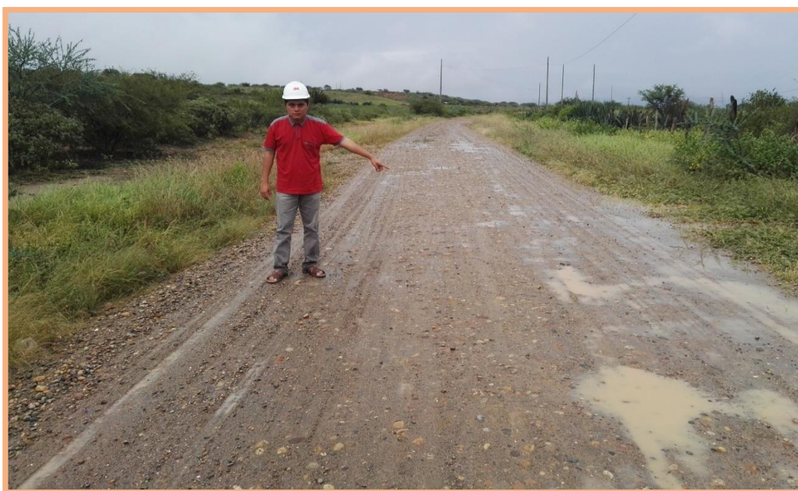
Figura 145: Unidad de Muestra N°7 (3.00km-3.050km). Falla 85 (Baches) y 86 (Surcos). Falla 85, según Tabla 9, hay 2 baches de severidad media (nivel M) y 3 de severidad baja (Nivel L). Falla 86, según Tabla 9, es de severidad baja (Nivel L), por la profundidad de <2.5cm, con ancho de 2.65m en toda la calzada y extensión de 10m.
