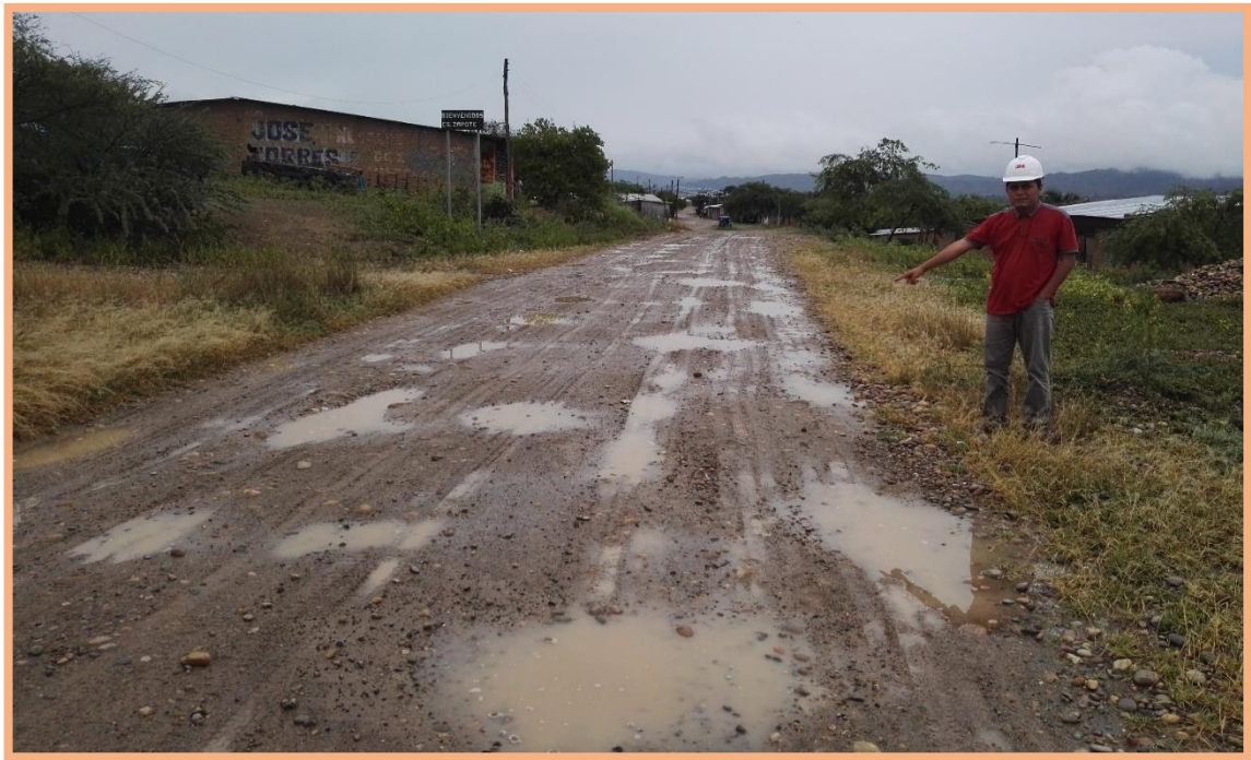
Figura 103: Sección N°8 (3.5-3.7km). Falla de bache y deformación, se presentó en el 3.69km, según la Tabla 2 específica para baches que es de gravedad 3, necesita una reconstrucción. Deformación en todo el ancho de plataforma, de gravedad 1, sensible al usuario <5cm.
