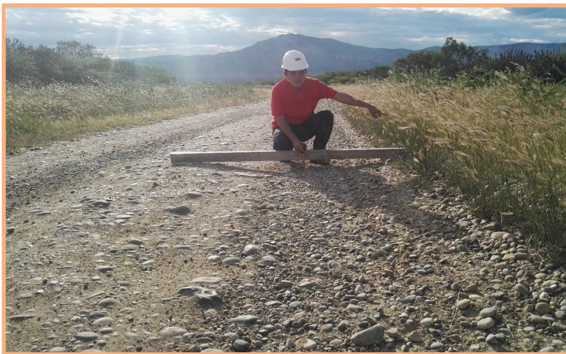
Figura 75: Sección N°5 (2-2.5km). Falla de deformación (ahuellamiento), desde 2km hasta 2.37 km (370m de extensión), de altura de 6.10cm y con ancho de 1.58m, por lo que según la Tabla 2, es de gravedad 2 ( 5 < h < 10\text{cm} ).
