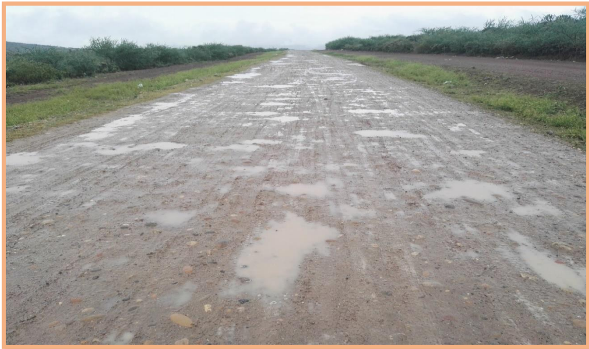
Figura 55: Sección N°2 (0.5-1km). Falla de baches y deformación, encontrado en el 650m, según Tabla 2, menciona que este tipo de bache es de gravedad 3, necesita una reconstrucción. También hay deformación mínima (<5cm) en el ancho de la plataforma.
