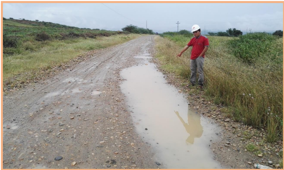
Figura 90: Sección N°7 (3-3.5km). Falla de bache y deformación, se presentó en el 3.25km, según la Tabla2 especifica que es de gravedad 3, necesita una reconstrucción. Además, existe deformación mínima (<5cm) en todo el ancho de plataforma.
