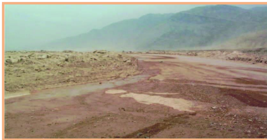
Figura 8: Baches (Huecos), Gravedad 2: Necesita una capa de material adicional.
