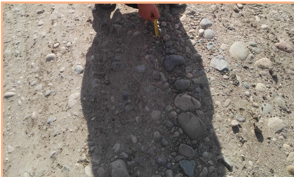
Figura 117: Unidad de Muestra N°2 (630-685m). Falla 87 (Agregado Suelto). Según Tabla 9, estipula que esta falla es de baja severidad (Nivel L), porque es <5cm. En este caso es la longitud máxima de 55m.
