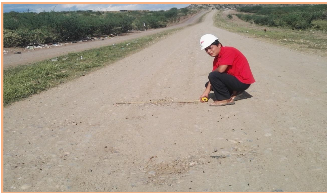
Figura 114: Unidad de Muestra N°2 (630-685m). Falla 85 (Baches). Según Tabla 9, se ha encontrado 4 baches de mediana severidad (Nivel M), 28 baches de baja severidad (Nivel L).
