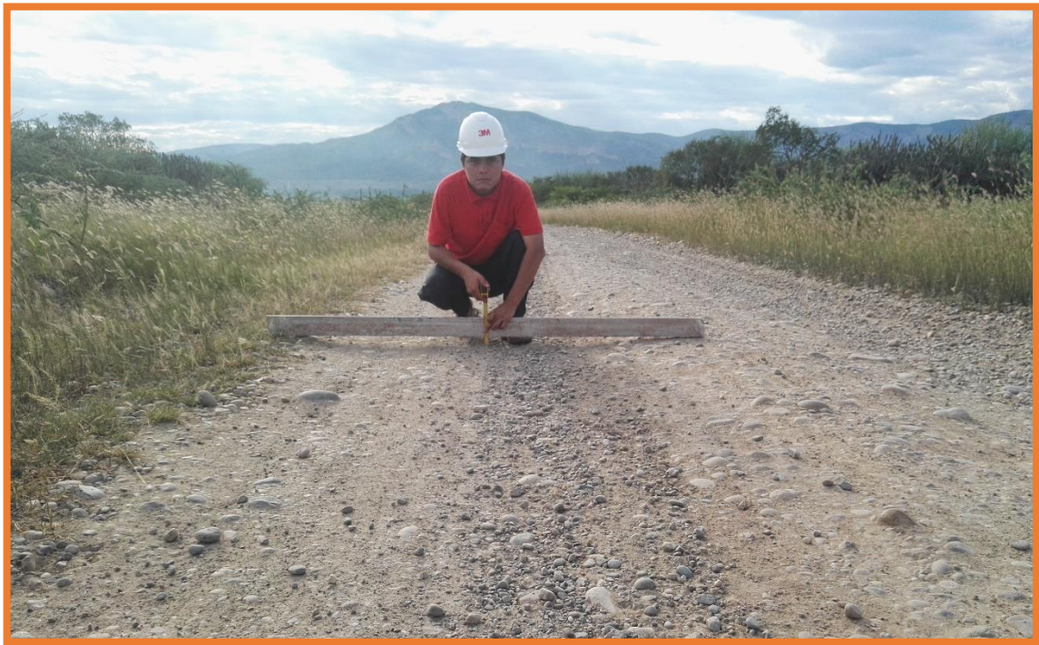
Figura 134: Unidad de Muestra N°5 (2.315km-2.370km). Falla 86 (Surcos), según Tabla 9, es de severidad media (Nivel M), por ser de profundidad de 3.5cm, longitud de 55m y ancho de 1.25m.
