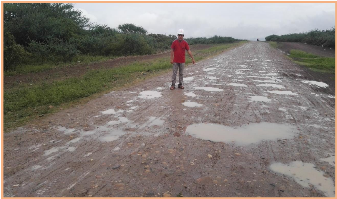
Figura 53: Sección N°1 (0-500m). Falla de baches, encontrado en el 460m, según Tabla 2, menciona que este tipo de bache es de gravedad 3, necesita una reconstrucción.
