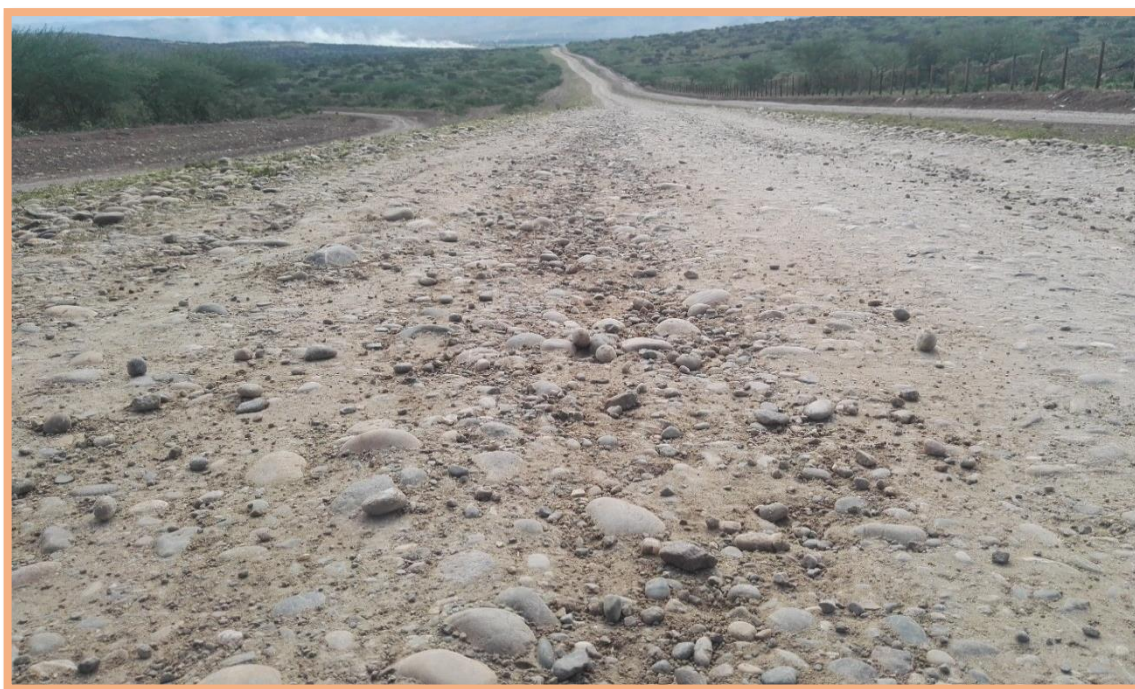
Figura 110: Unidad de Muestra N°1 (202-257m). Falla 87 (Agregado Suelto). Según Tabla 9, presenta agregados menores a 5 cm (Nivel L), además por existir en los dos lados del surco, se tomó como longitud máxima de 110 m.
