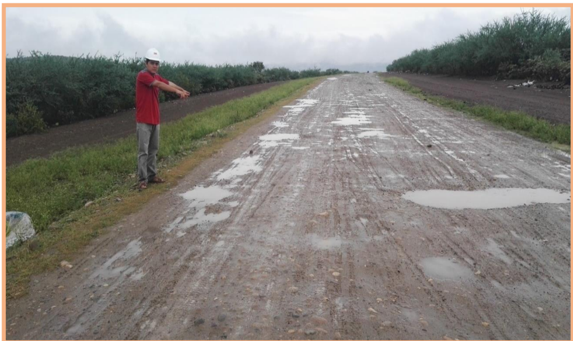
Figura 58: Sección N°2 (0.5-1km). Falla de baches y deformación, encontrado en el 782m, según Tabla 2, menciona que este tipo de bache es de gravedad 3, necesita una reconstrucción. También hay deformación mínima (<5cm) en todo el ancho de la plataforma.
