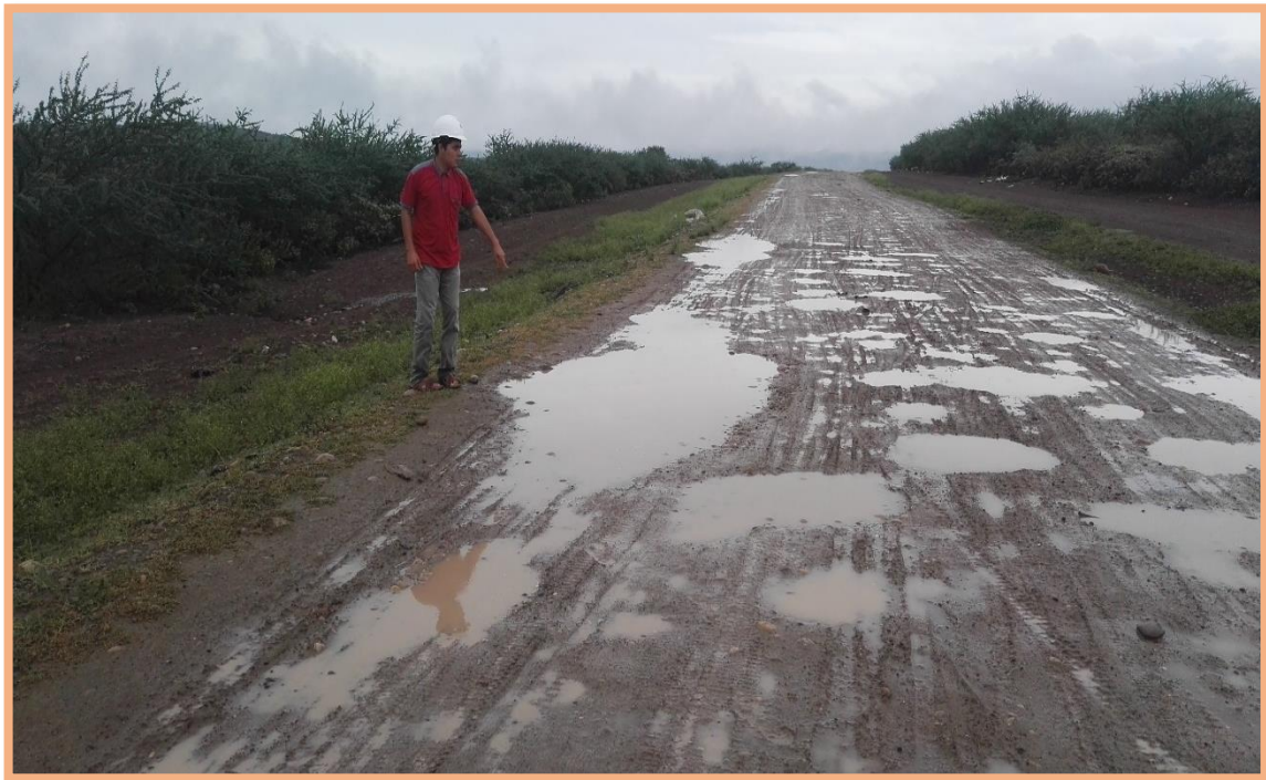
Figura 57: Sección N°2 (0.5-1km). Falla de baches y deformación, encontrado en el 756m, según Tabla 2, menciona que este tipo de bache es de gravedad 3, necesita una reconstrucción. Además, existe deformación mínima (<5cm) en el ancho de la plataforma.
