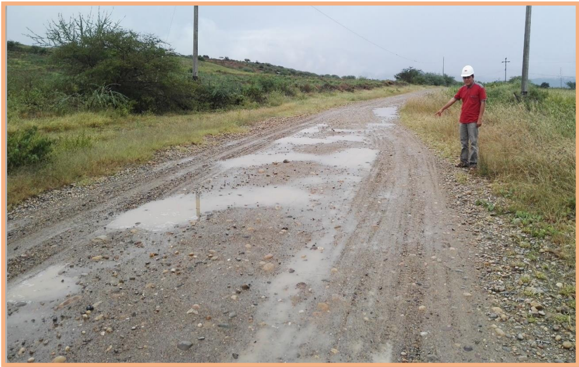
Figura 89: Sección N°7 (3-3.5km). Falla de bache y deformación, se presentó en el 3.23km, según la Tabla2 especifica que es de gravedad 3, necesita una reconstrucción. Además, existe deformación mínima (<5cm) en todo el ancho de plataforma.
