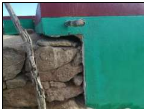
Figura 34: Deslizamiento en la infraestructura de sedimentación
