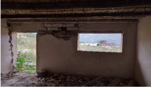
FOTO 1.- Se muestra Los daños de muro de adobe en viviendas existentes.
