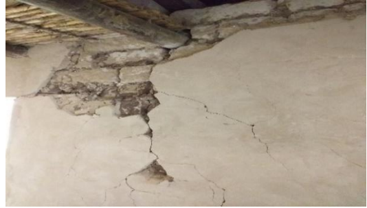
FOTO 2.- Se observa fallas en los muros.
