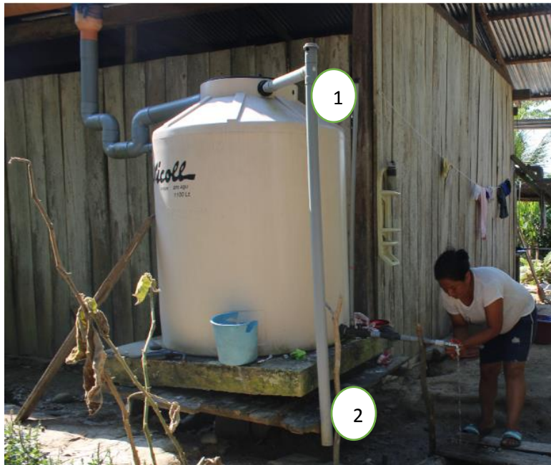
Figura 10. Ventilación del rebose (1); Salida del rebose (2)
