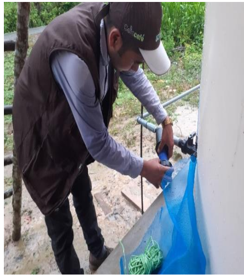
17. verificación de filtros
