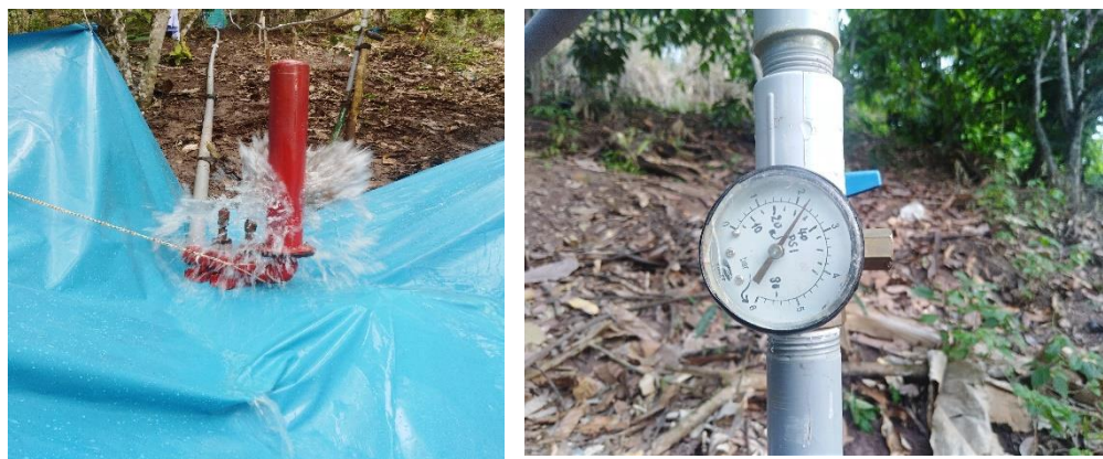
Fotografía 4. Cierre de válvulas de impulso.
