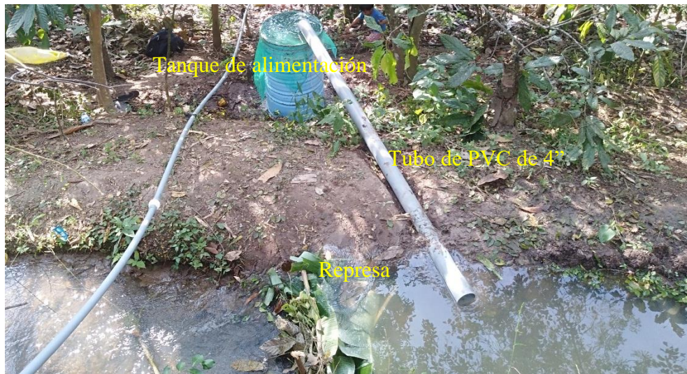
Figura 2. Entrada del agua a la tubería desde el embalse al reservorio.
