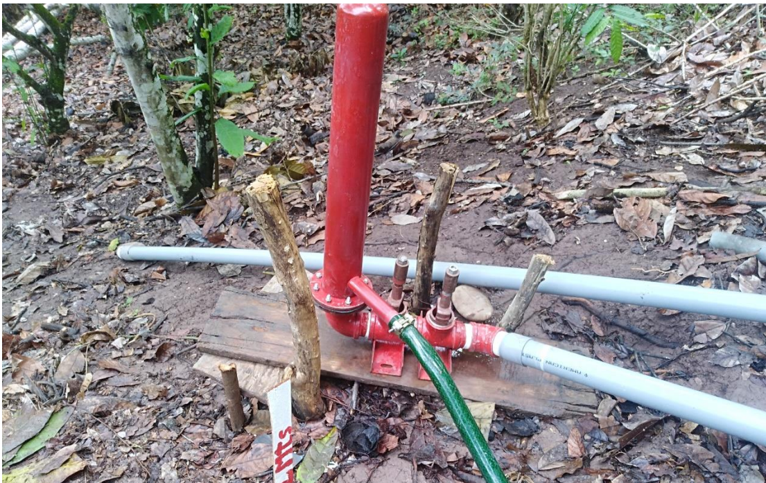
Fotografía 2. Tanque de compresión del aire, ubicación de la válvula check y bomba de ariete hidráulico de 2" anclada en la base de madera.
