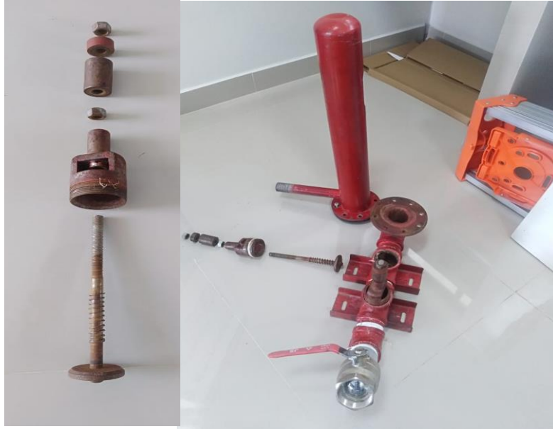
Fotografía 1. Válvula de cierre o de impulso desmontada en el cuerpo de la BAH de 2".
