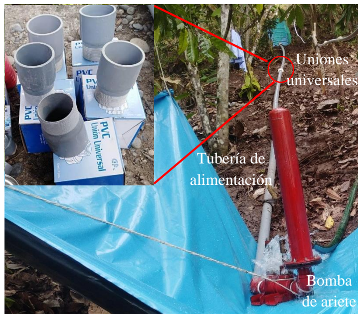
Figura 5. Tubería de alimentación a la bomba de ariete.
