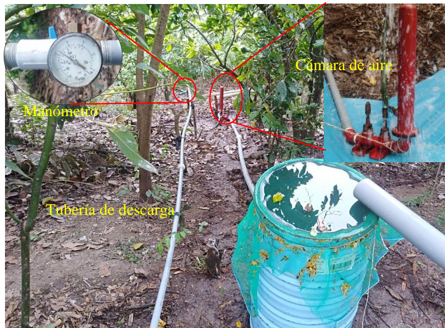
Figura 8. Tubería de conducción de agua bombeada.
