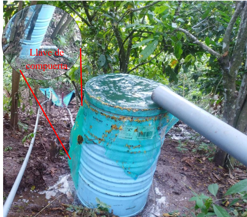
Figura 3. Tanque de alimentación de la bomba de ariete hidráulico.
