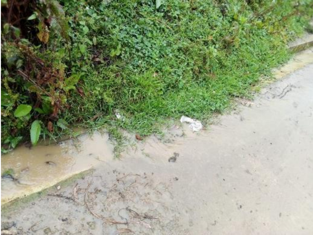
Figura 63 Obras de arte parcialmente colmatadas.
