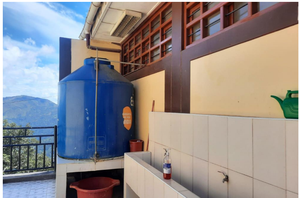
Imagen 3. Fotografía del tanque de almacenamiento de agua de la I.E.
