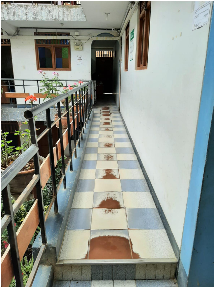
Pasadizo principal de las oficinas de la Dirección Regional de Educación Amazonas – Unidad Ejecutora 300
