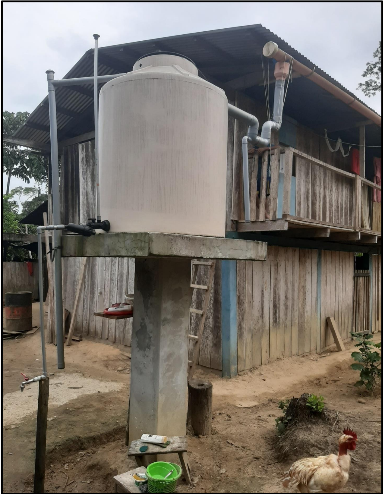
Fotografía 1: Sistema de prototipo utilizado para captación de agua de lluvia en las comunidades nativas de Yahuahua y Tunants- Condorcanqui.
