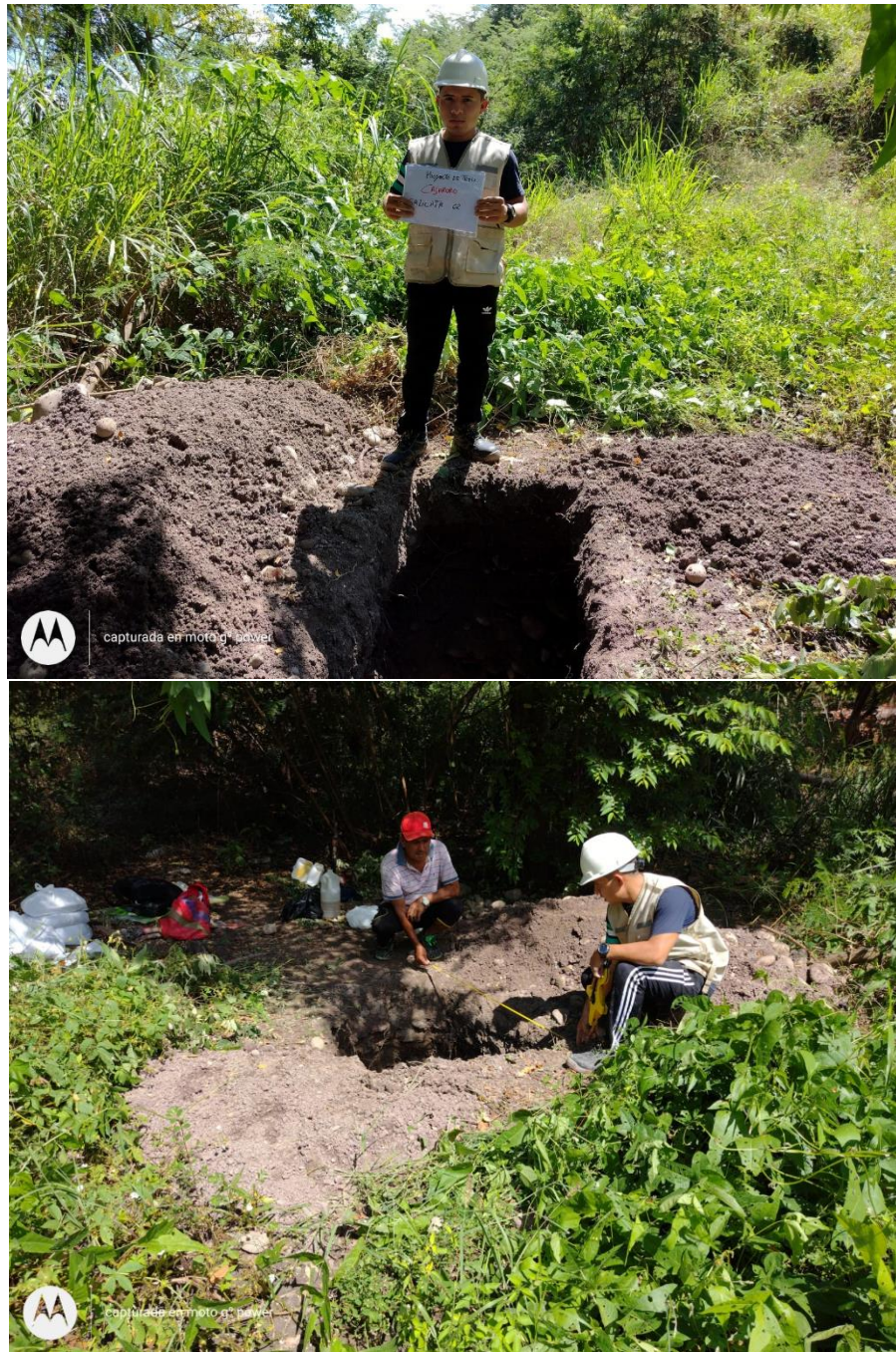
Figura 11. Calicata N° 02 en tramo de la carretera de Cajaruro a Naranjos Alto, Amazonas (Km 06+820 – Km 06+880)
