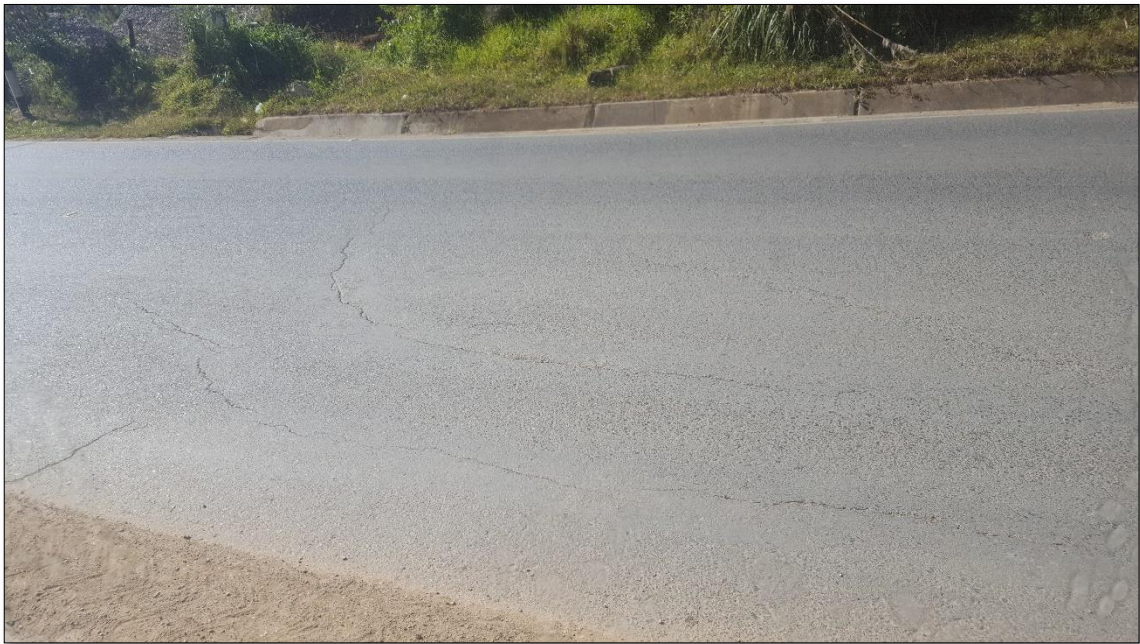
Fotografía 4. Grieta parabólica (F17) de severidad (M) registrada en UM-01
