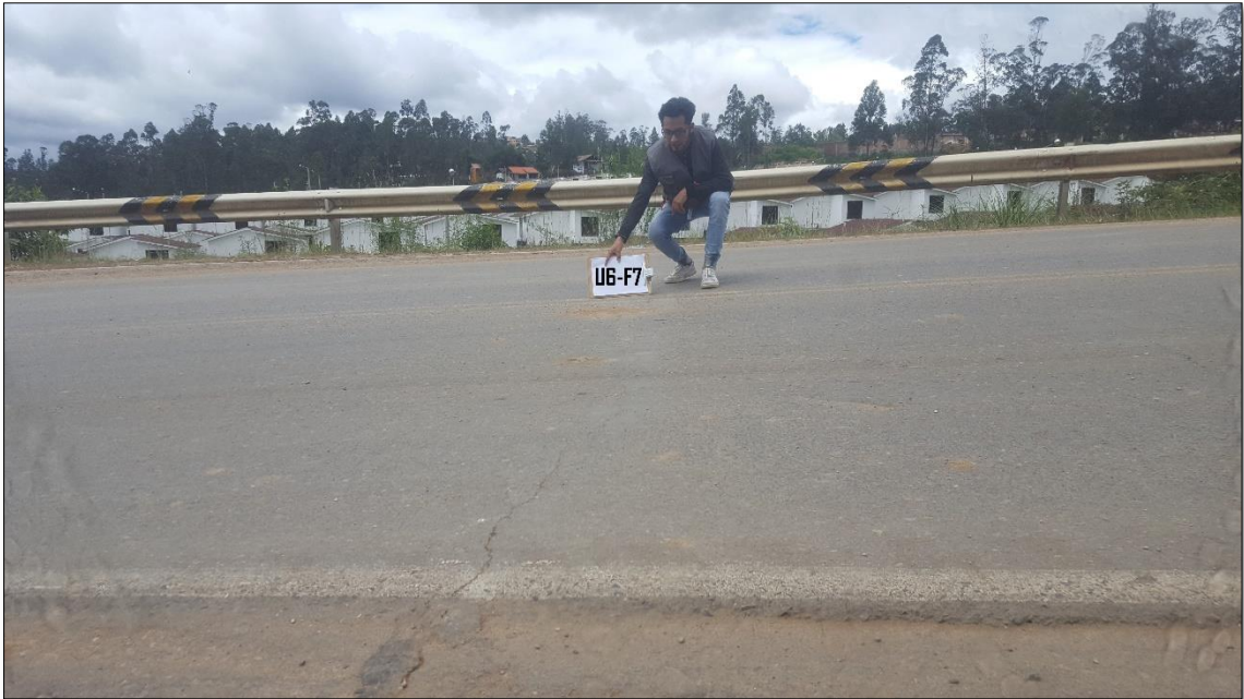
Fotografía 10. Grieta de borde (F7) de severidad (M) registrada en UM-06
