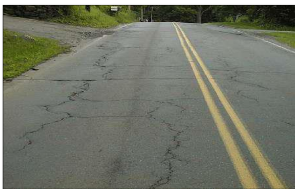
Figura 3. Agrietamiento en bloque
