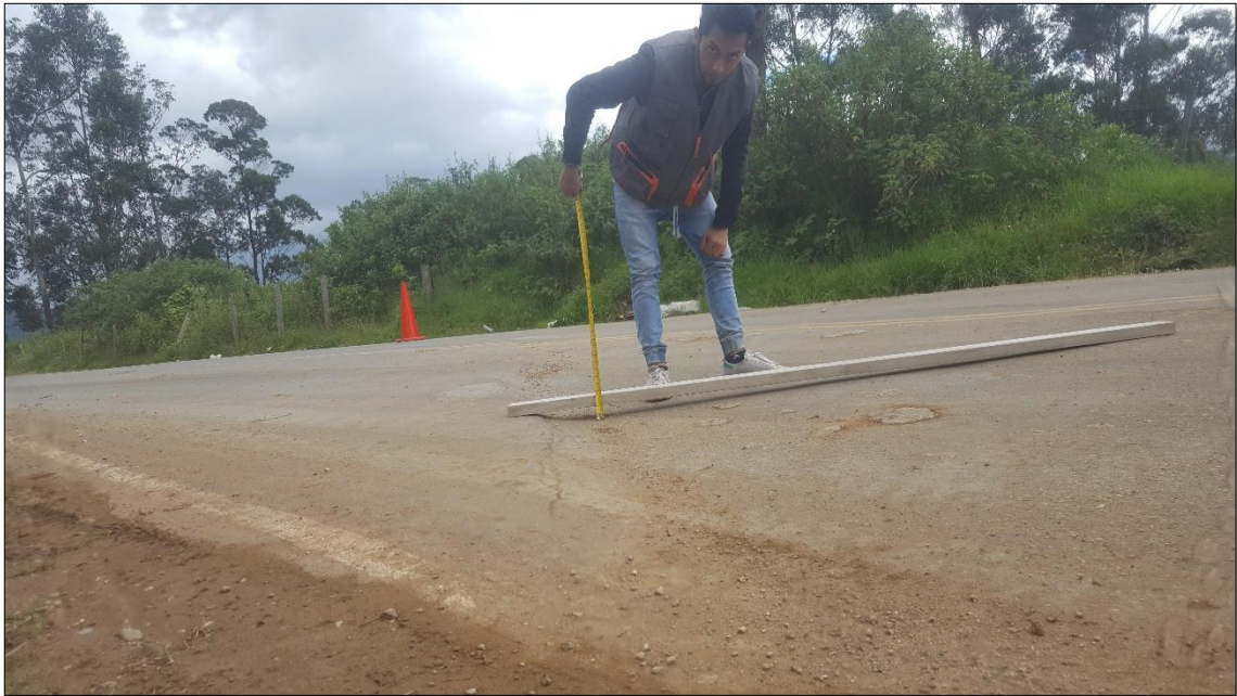
Fotografía 7. Hundimientos (F4) de severidad (A) registrada en UM-04
