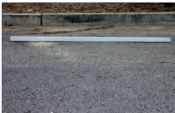
Figura 4. Abultamientos y hundimientos
