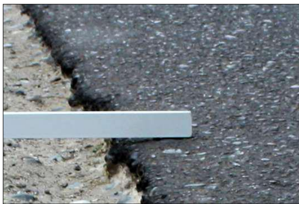
Figura 9. Desnivel de carril/berma
