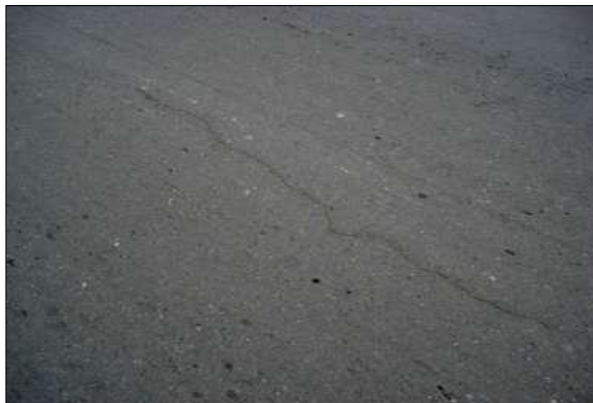
Figura 10. Grietas longitudinales y transversales
