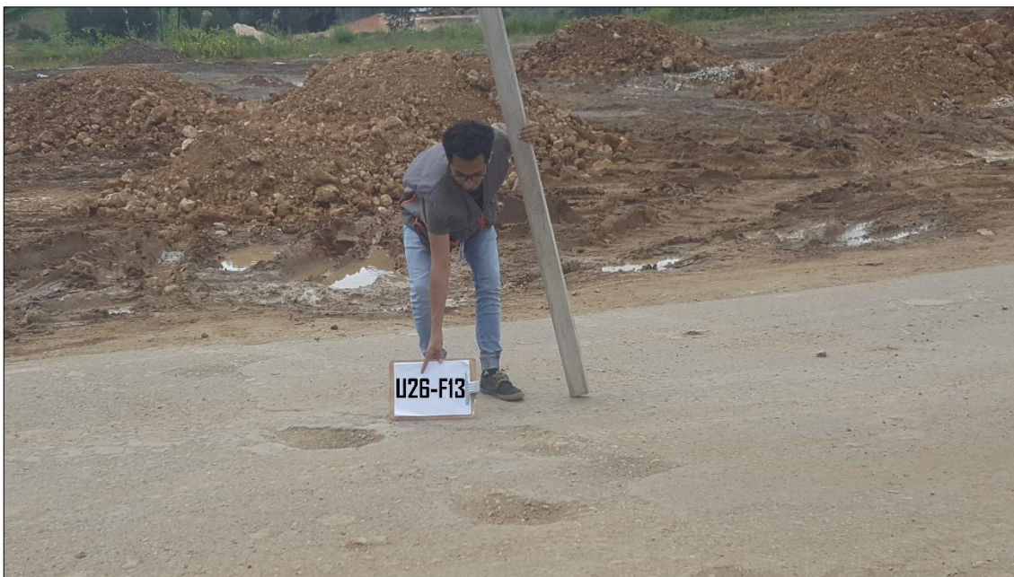
Fotografía 12. Huecos (F13) de severidad (M) registrada en UM-26
