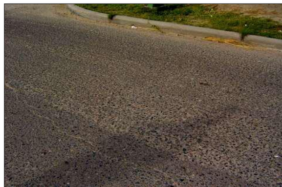
Figura 19. Desprendimiento de agregados
