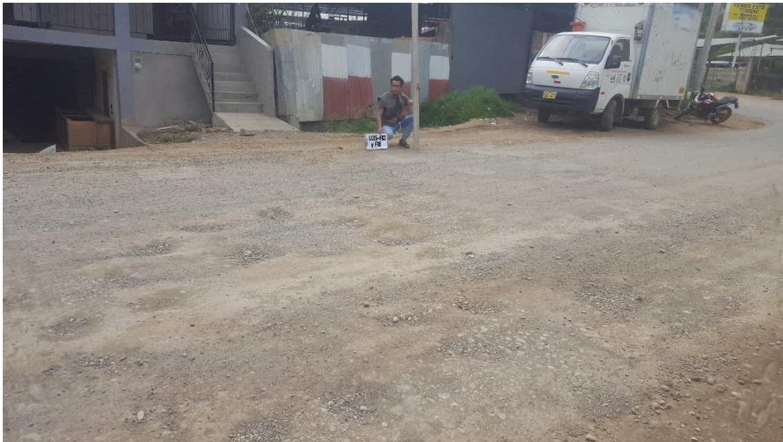
Fotografía 14. Tramo más crítico del pavimento flexible a consecuencia del desprendimiento de agregados (F18) y presencia de huecos (F13) en toda la UM-35.
