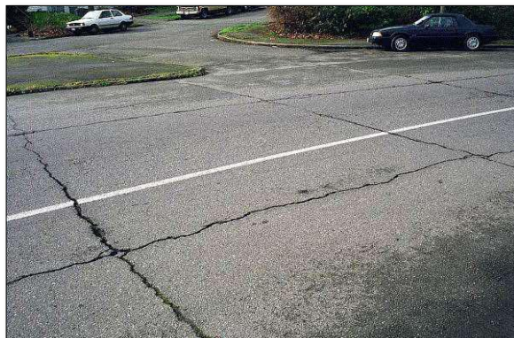
Figura 8. Grieta de reflexión de junta
