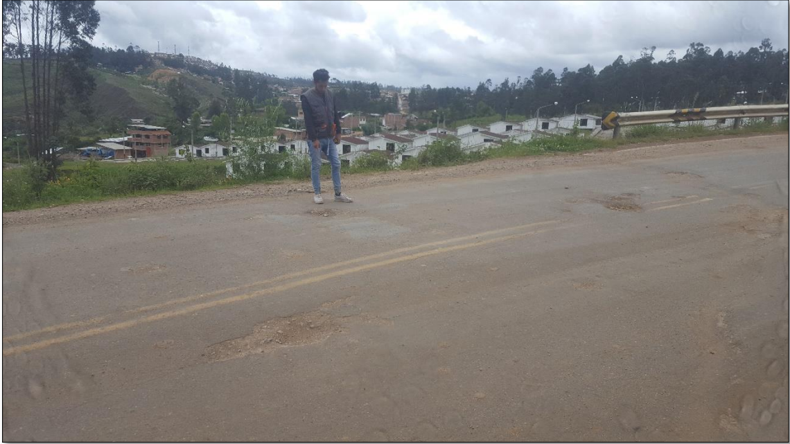
Fotografía 9. Huecos y hundimientos (F13, F4) de severidad (M) registrada en UM-04
