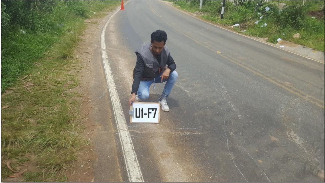
Fotografía 5. Grieta de borde (F7) de severidad (M) registrada en UM-01
