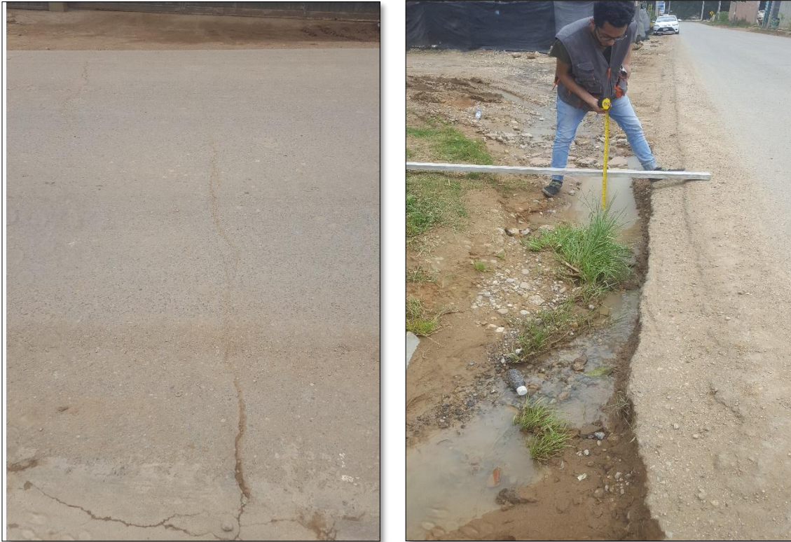
Fotografía 11. Grieta transversal de severidad (M) y socavamientos del agua de lluvia por la falta de drenaje registrada en UM-20
