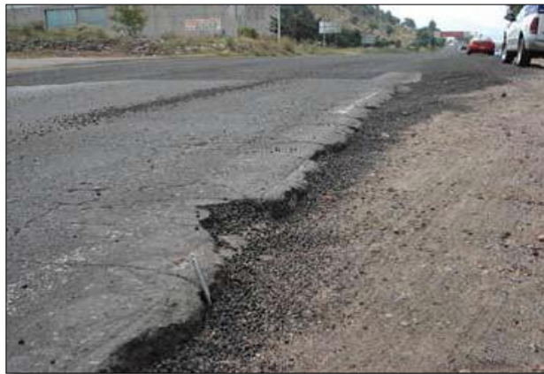
Figura 7. Grieta de borde
