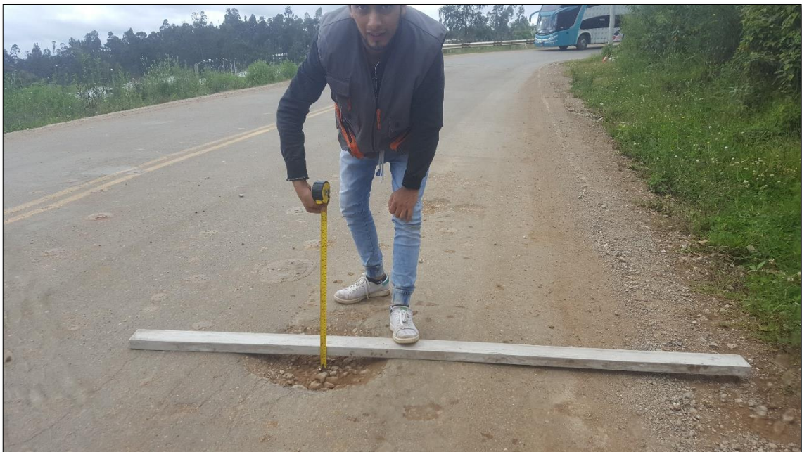
Fotografía 8. Huecos (F13) de severidad (M) registrada en UM-04
