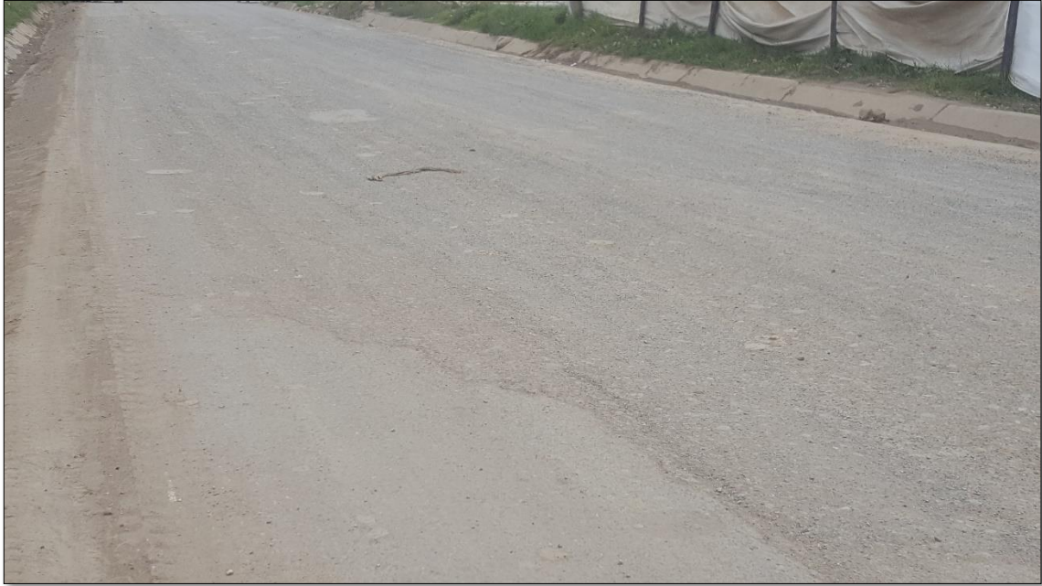
Fotografía 13. Desprendimiento de agregados (F18) de severidad (A) registrada desde la UM-26 hasta UM-29
