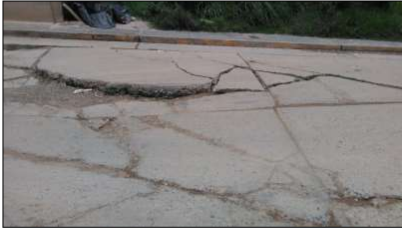
Foto N° 1: Identificación de falas en el pavimento
