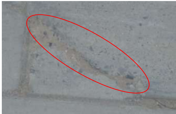
Figura 27. Fisura de esquina
