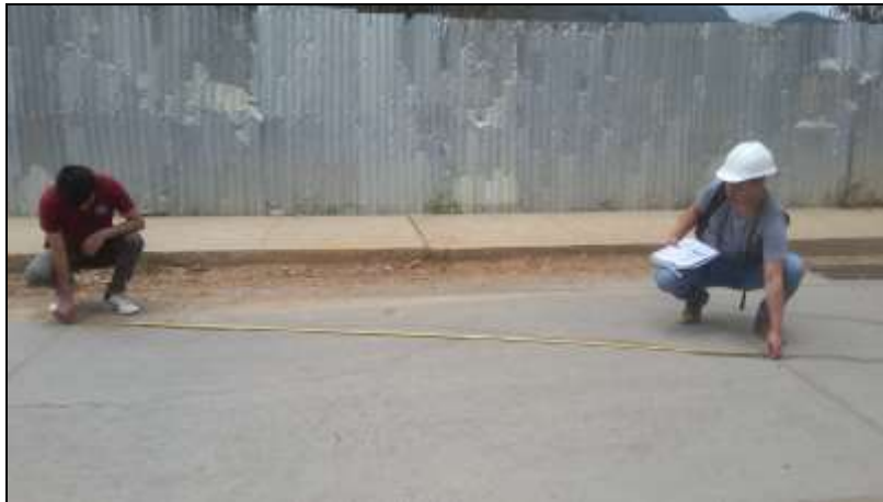
Foto N° 2: Medición de falas en el pavimento
