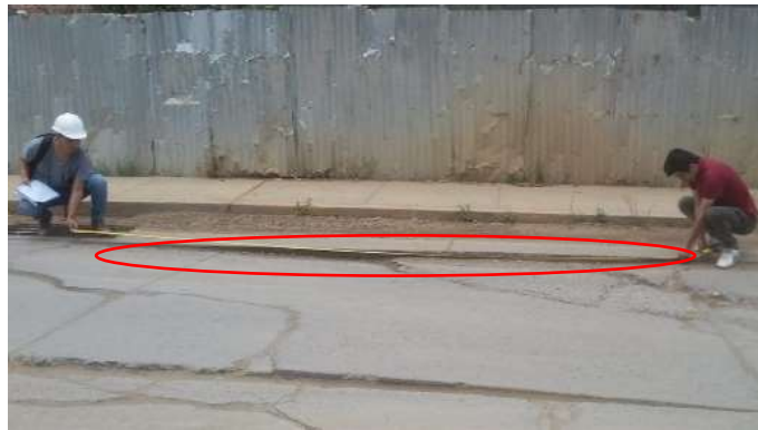
Figura 37. Desevel entre calzada – berma
