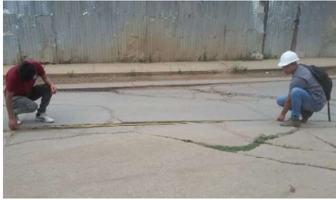
Figura 21. Desnivel entre Losas
