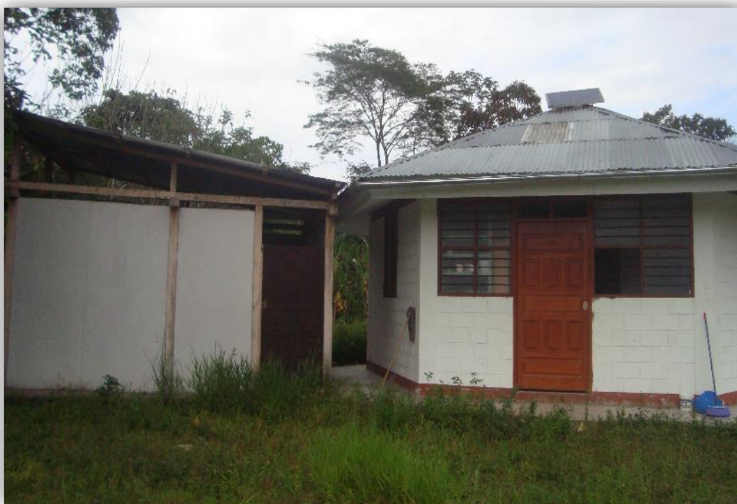
Figura 35. Estado actual del puesto de salud de la comunidad nativa de Shimpiyacu. (Exterior)
