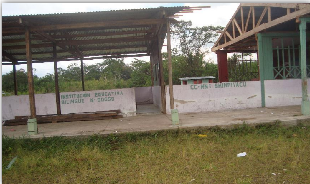
Figura 34. Estado actual de la escuela de la comunidad nativa de Shimpiyacu. (Exterior)
