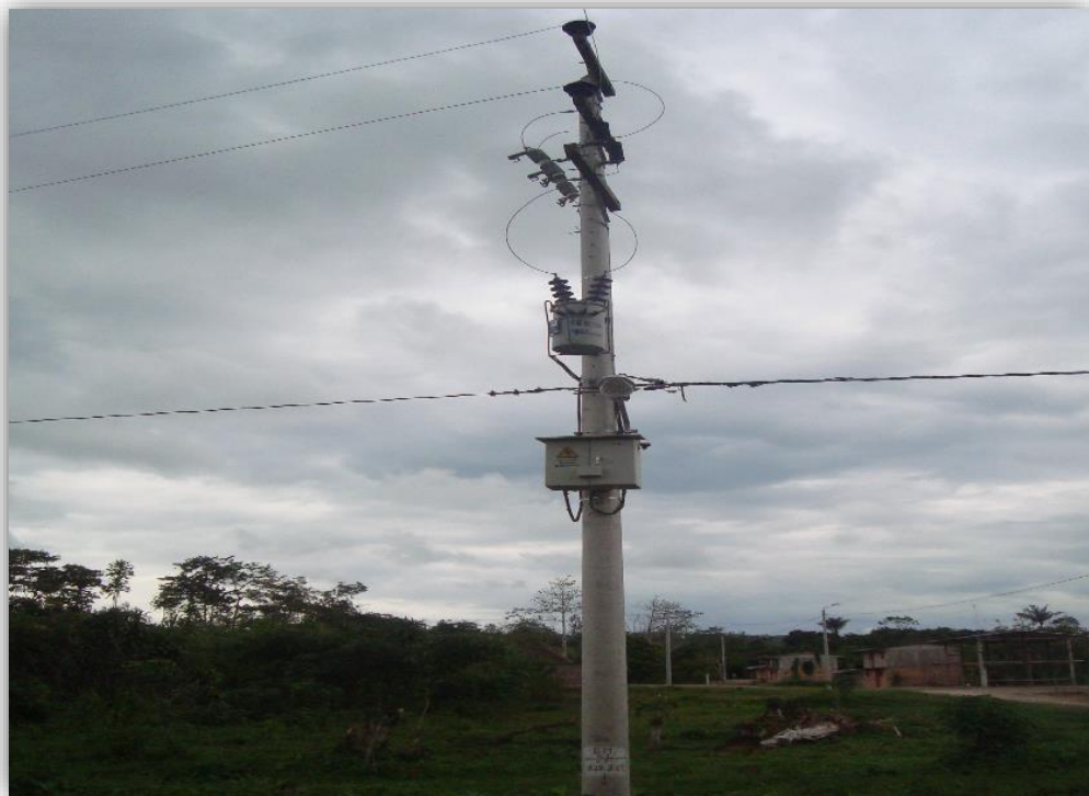
Figura 39. Tendido eléctrico instalado en la CCNN de Shimpiyacu.
