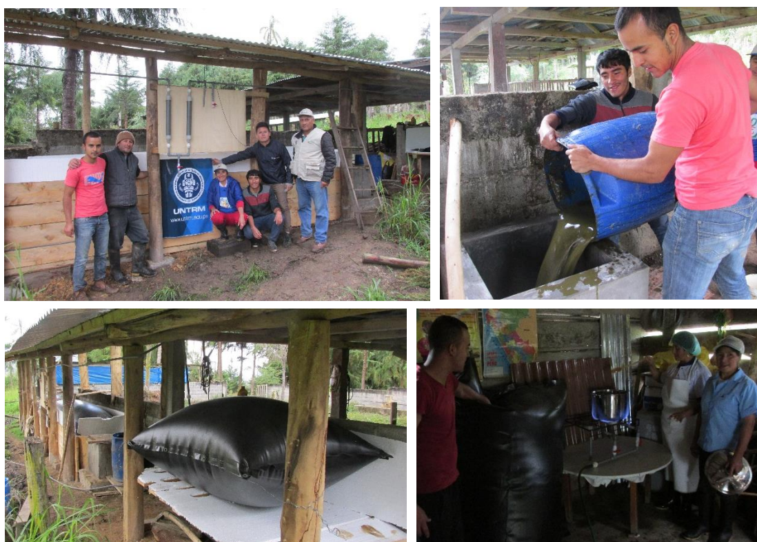
Fotografía 10. Biodigestor instalado en Pumahermana, Chachapoyas.
