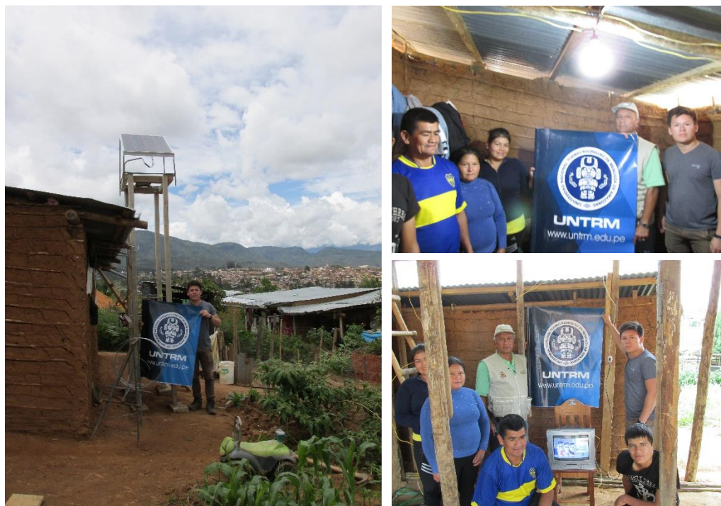
Fotografía 8. Sistema fotovoltaico de 100 W instalado en 16 de Octubre, Chachapoyas.
