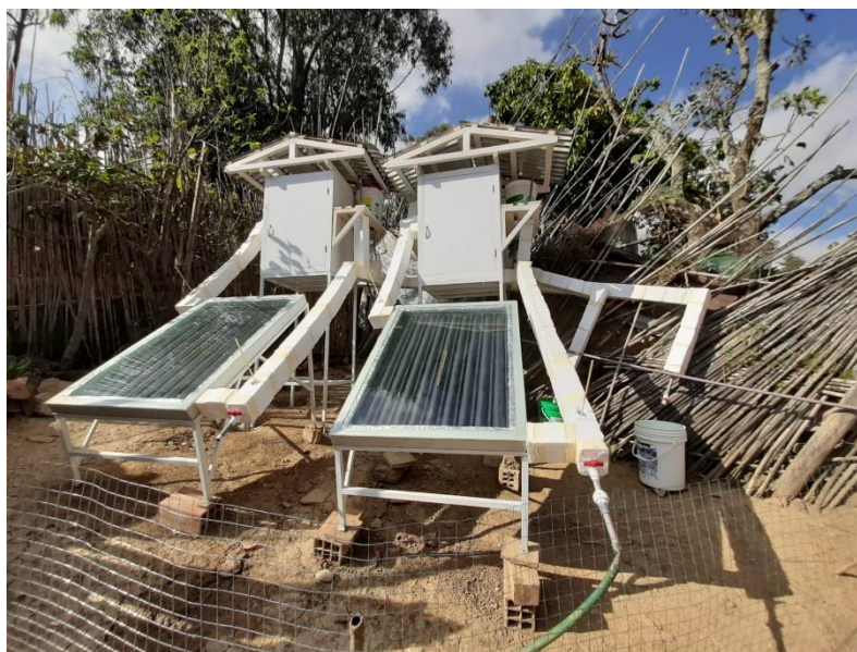
Fotografía 9. Termas solares instaladas en el Barrio Zeta, Chachapoyas.
