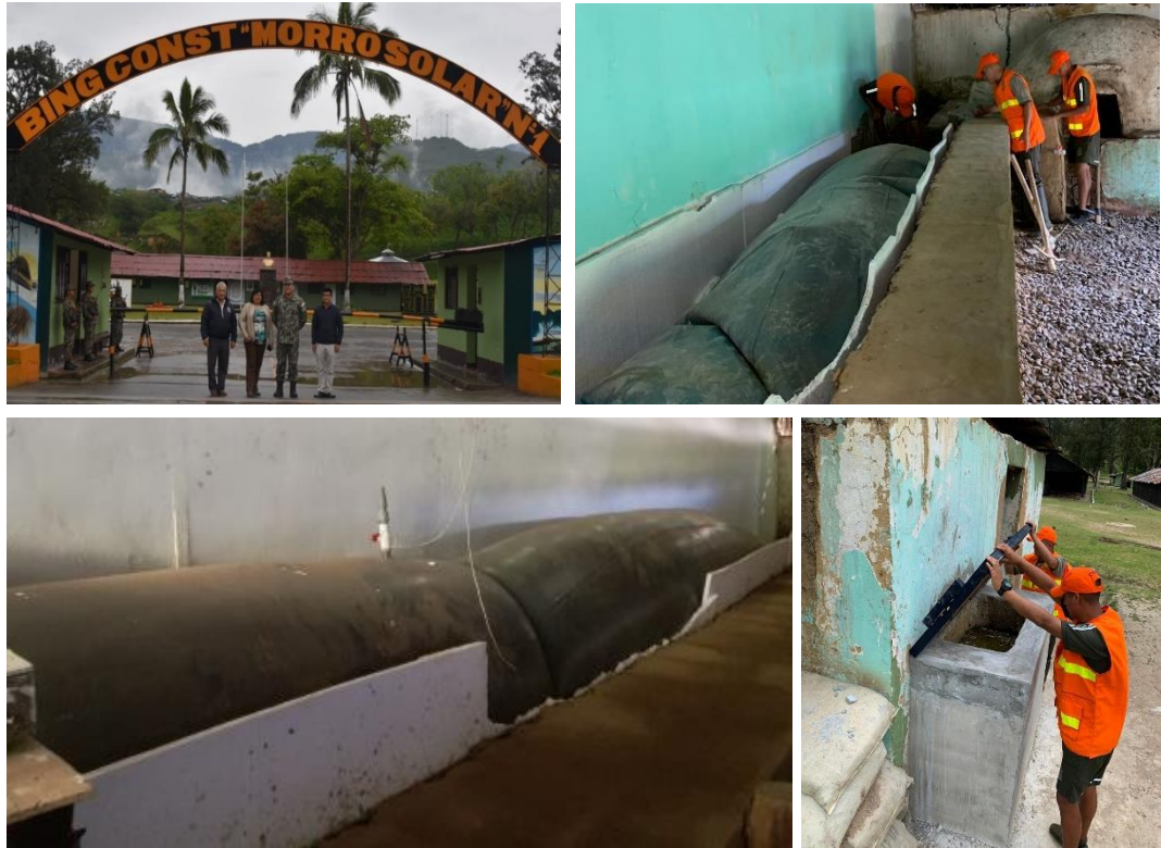
Fotografía 12. Biodigester instalado en el Cuartel del Batallón de Ingeniería de Construcción “Morro Solar” N° 1 del Ejército del Perú, en Pedro Ruiz, Bongará.
