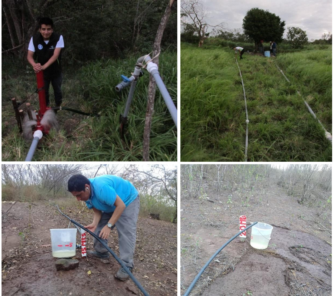
Fotografía 3. Bomba de ariete hidráulico instalada en Victoria, Bagua.
