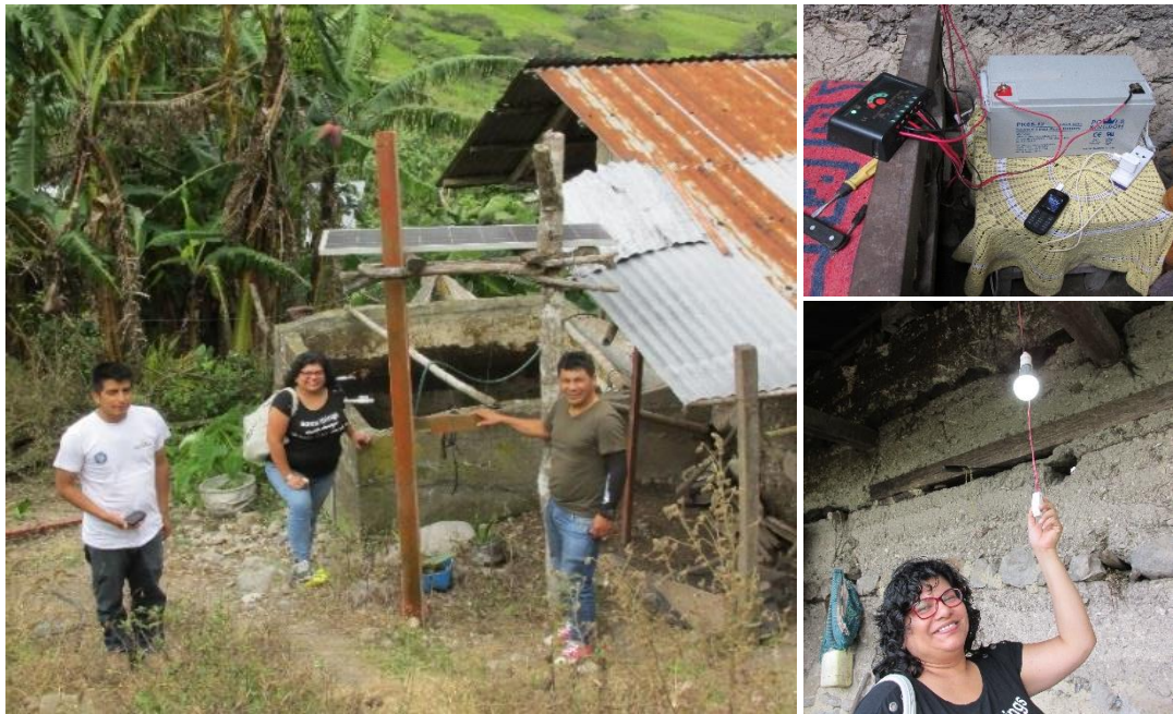
Fotografía 5. Sistema fotovoltaico de 150 W instalado en Naranjos, Bagua.
