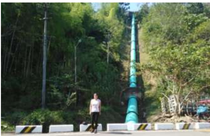
Hidroeléctrica El Muyo
