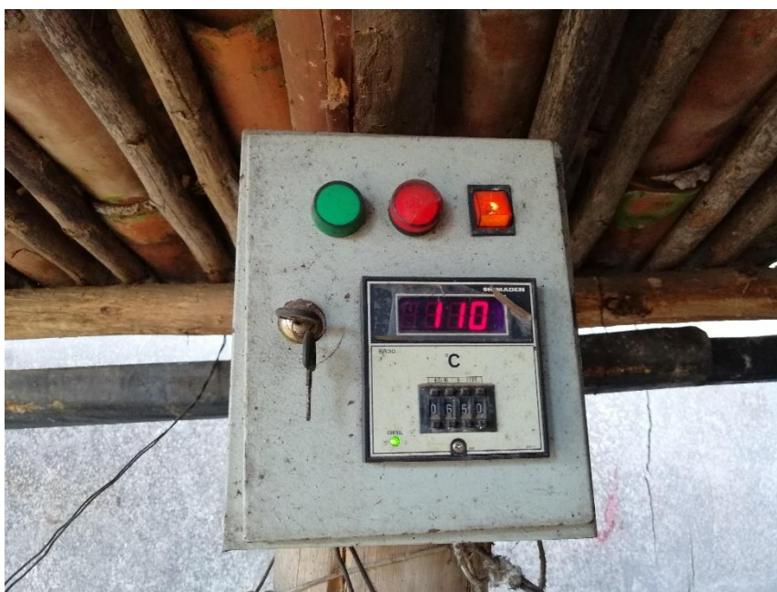
Foto N° 04. Termómetro del horno industrial que controla el aumento de la temperatura.
