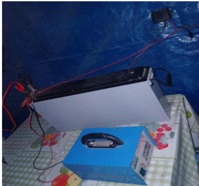
Figura 12. Batería, panel fotovoltaico e inversor conectados al regulador de carga del sistema fotovoltaico.
