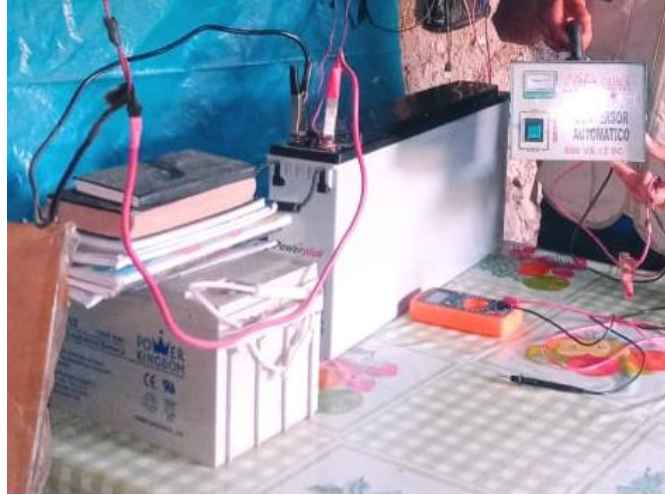
Figura 11. Conexión del inversor al regulador de carga del sistema fotovoltaico.
