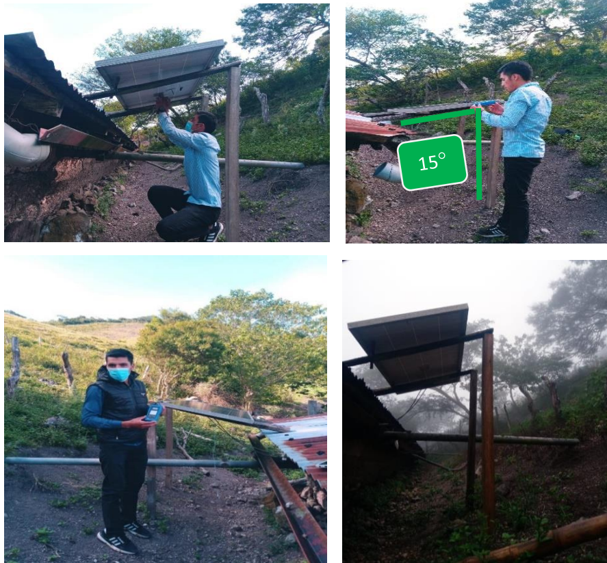
Figura 8. Soporte e instalación del panel solar, con inclinación de 15^\circ
