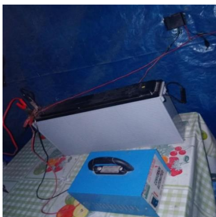
Figura 9. Conexión de la batería al regulador de carga del sistema fotovoltaico.
