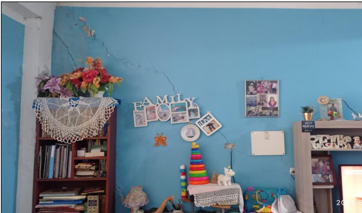
Foto 3. Muro de ladrillo King Kong agrietado del primer piso
