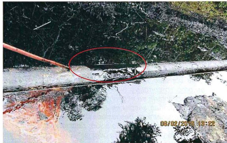
Muestra el punto de la falla donde se produjo el derrame de petróleo crudo, el mismo que aún no había sido controlado. Coordenada WG84: 9524314N/0237150E.
