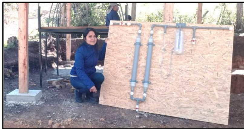
Figura 8. Tablero de purificación y control de presión
