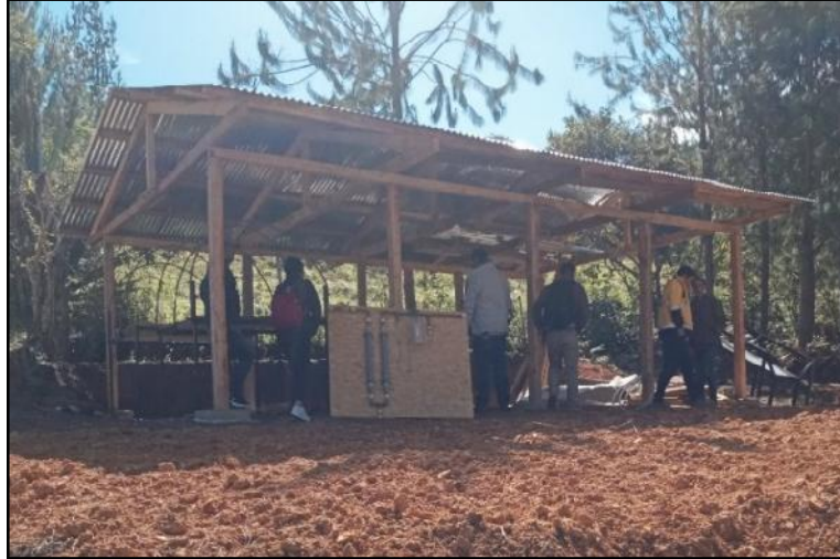
Figura 4. Caseta del Sistema de Biodigestor
