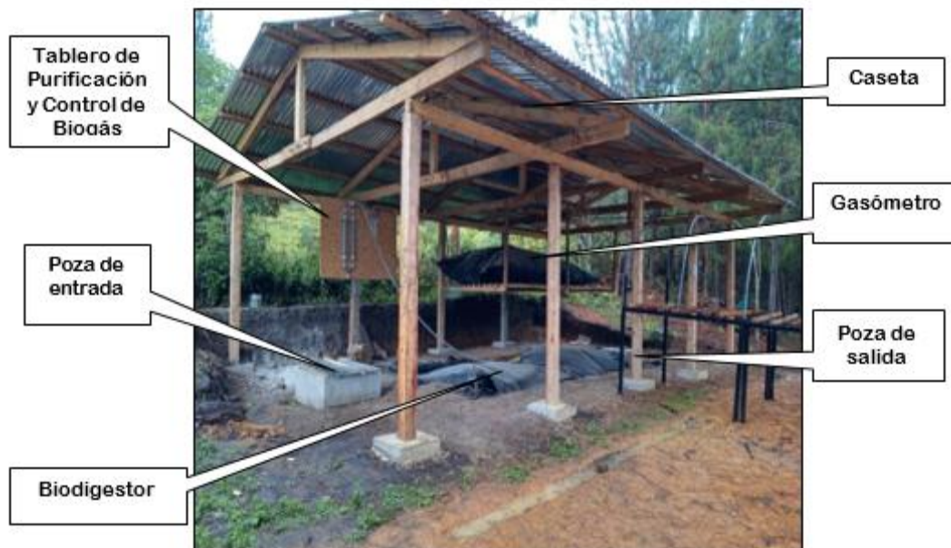
Figura 17. Sistema de Biodigestor Tubular instalado en el caserío Ramos.
