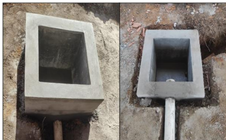
Figura 7. Buzones de carga (lado izquierdo) y poza de descarga (lado derecho)
