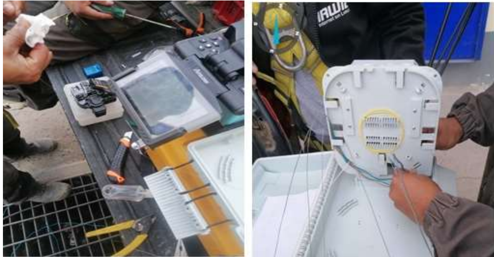
Figura 37. Empalmes de las cajas NAP
