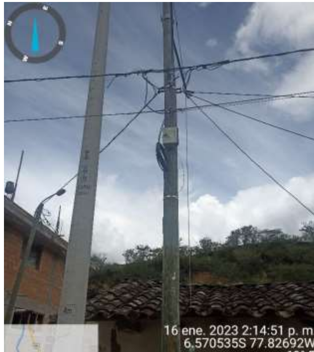
Figura 35. Despliegue de la fibra óptica
