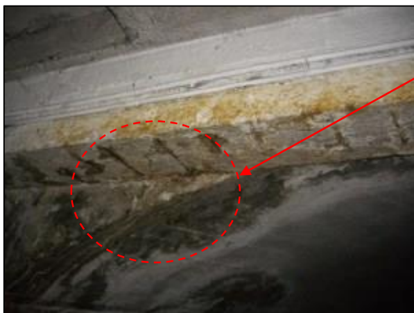
Figura 9. Presencia de humedad en las estructuras.
