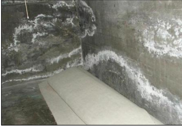
Figura 4. Eflorescencia en las estructuras de concreto
