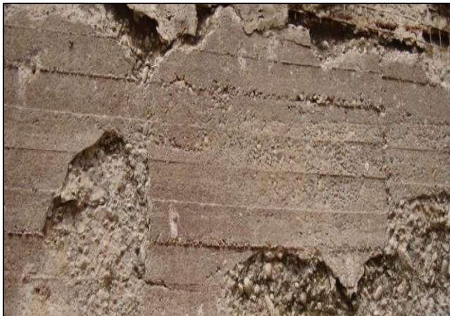
Figura 5. Corrosión del concreto.
