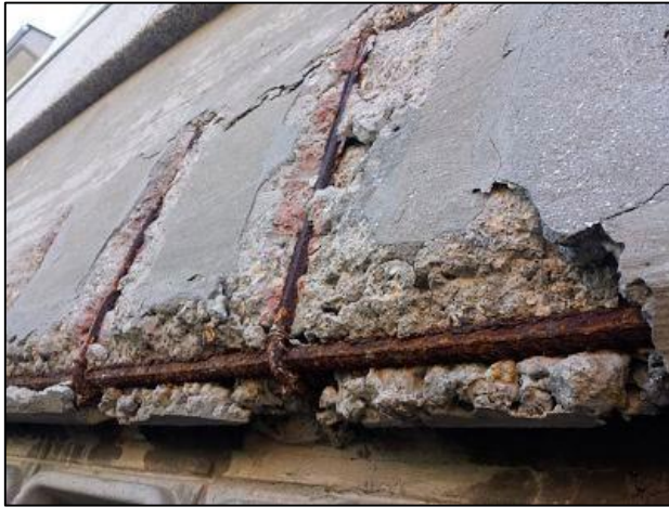
Figura 6. Corrosión del acero de refuerzo.
