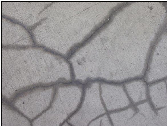
Figura 7. Fisuras en el concreto
