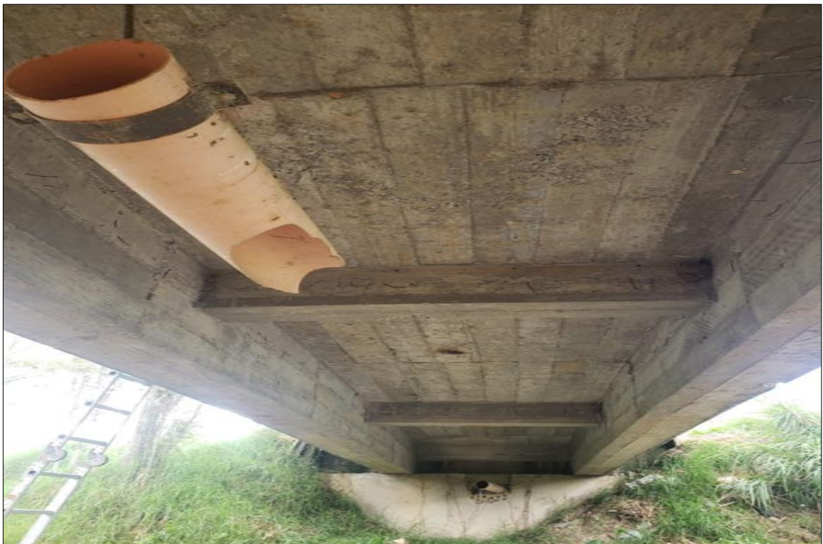
Fotografía 07: detección de fallas en puente y vista de las vigas diafragmas.
