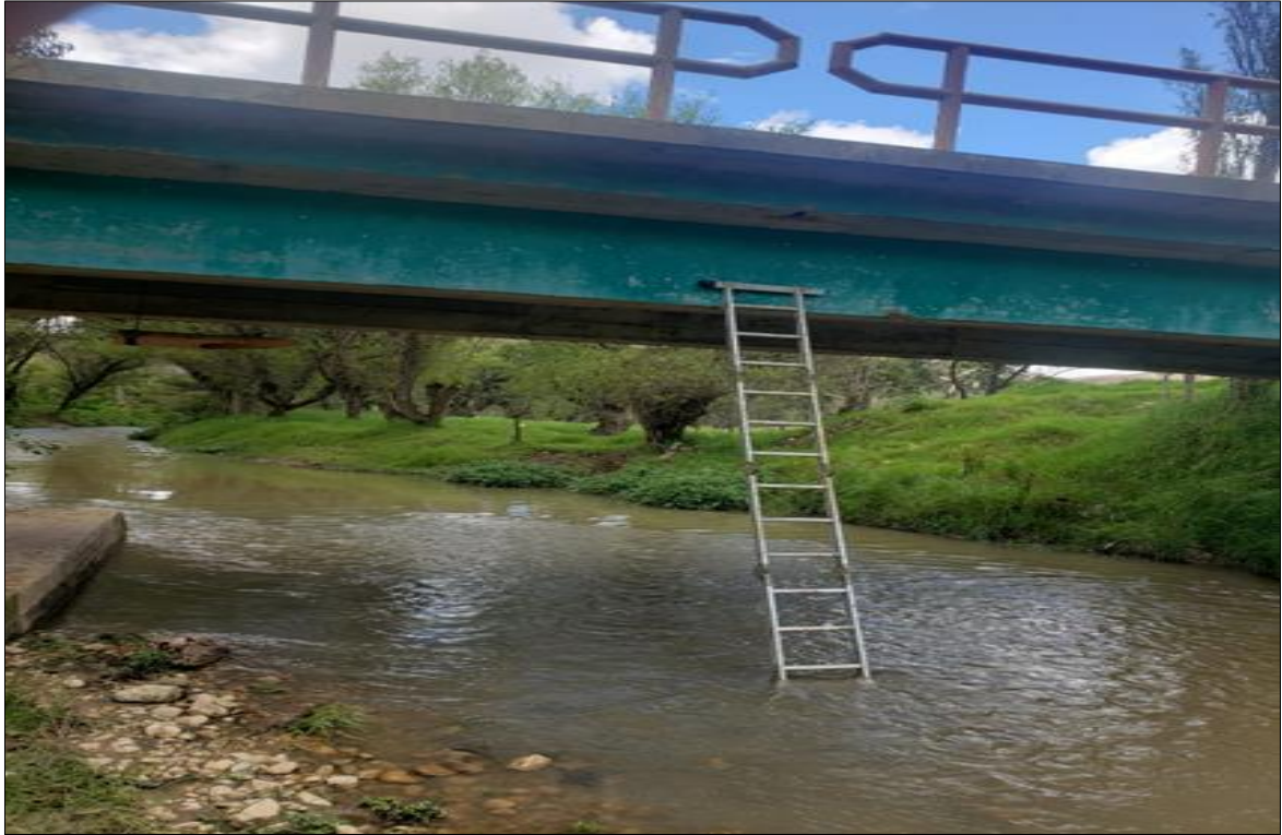
Fotografía 06: Medición de fallas en vigas y losa.
