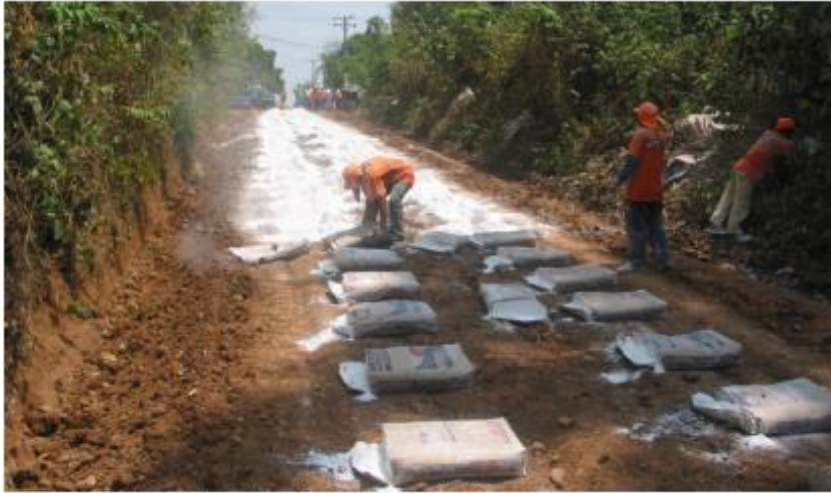
Figura 6. Colocación de los sacos de CCC sobre el material de subrasante en tramo del camino vecinal para su dosificación y posterior mezclado.
