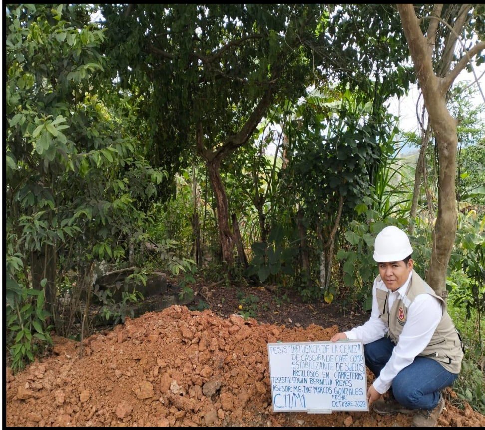
Fotográfica n° 23: Verificando los trabajos realizados en la calicata N° 11, profundidad 1.50m, en la progresiva (Km 9+000).
