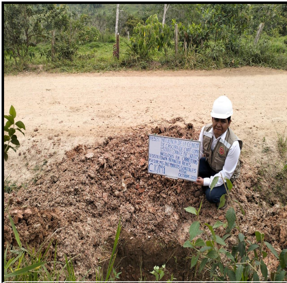
Fotográfica n° 21: Excavación calicata N° 10 y muestra 1, profundidad 1.50m, ubicado en la progresiva (Km 8+500).
