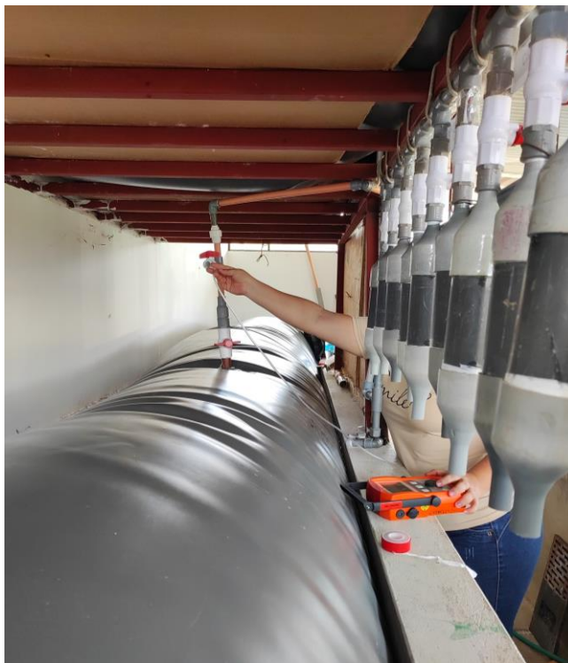
Fotografía 8. Medición de los parámetros antes del ingreso a los filtros
