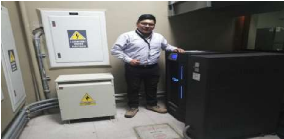
Imagen 17: Equipo UPS dentro del área de informática
